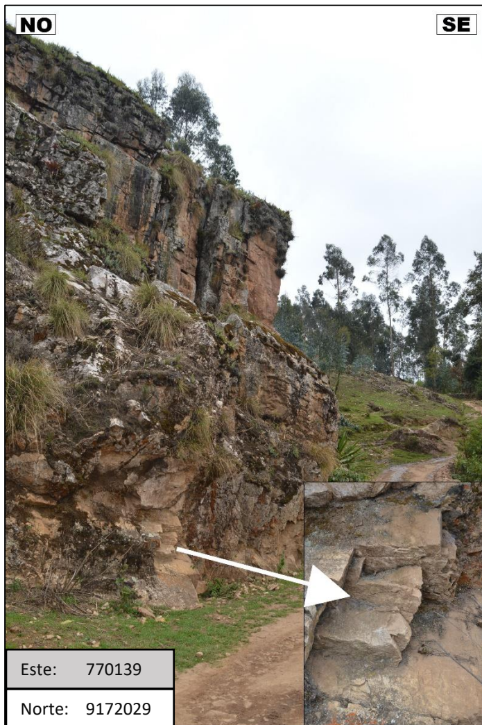
Foto 34: Se observa un afloramiento de la Formación Farrat, correspondiente a la estación geomecánica 08, en el sector Rambrán (progresiva Km 00+600).
