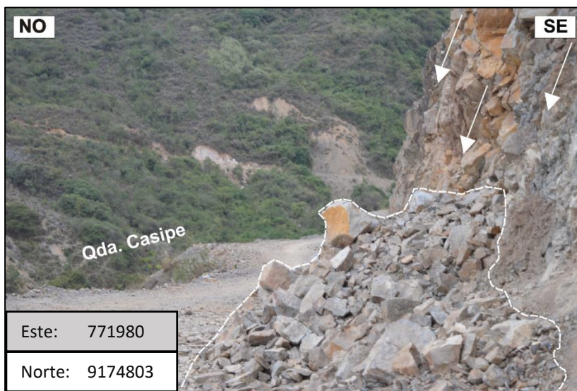
Foto 19: Caída de rocas en el flanco izquierdo de la carretera hacia Rambrán, sector Cerro Peña Blanca- Unión Casipe (progresiva Km 08+900).
