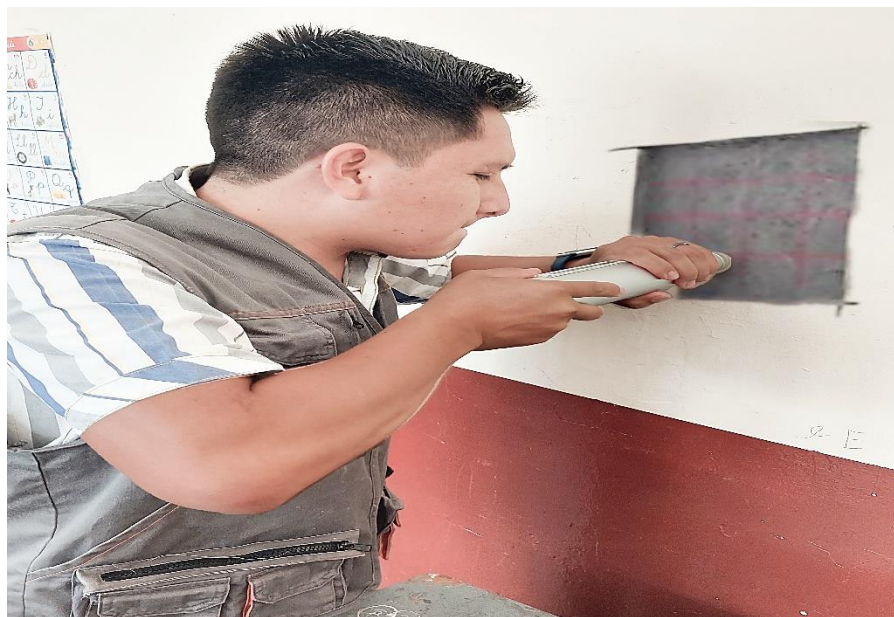
Fotografía N°03: Ensayo de Esclerometría en la columna de (0.25m x 0.40m) del 1er nivel del Eje 1 – 1.
