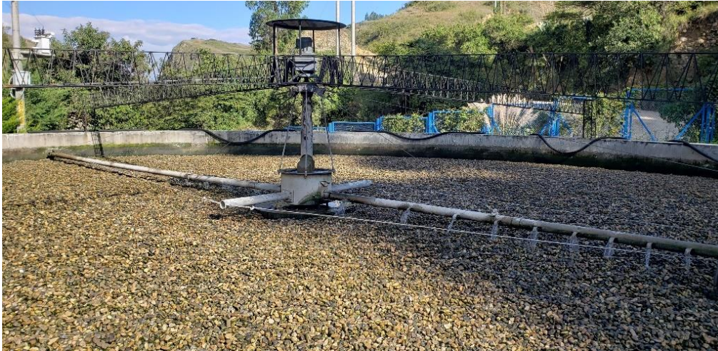
Figura 21: Filtro percolador captado el año 2022
