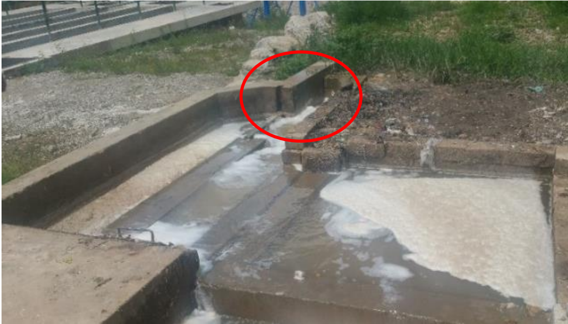
Figura 13: Ingreso de aguas del sistema de alcantarillado al sistema de tratamiento
