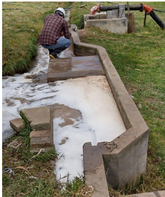
Figura 24: Agua residual desborda la estructura de pre tratamiento
