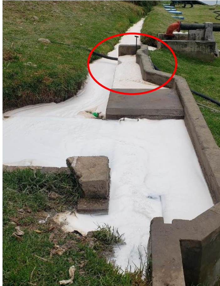
Figura 16: Medidor de caudal modelo Palmer Bowlus no abastece caudal
