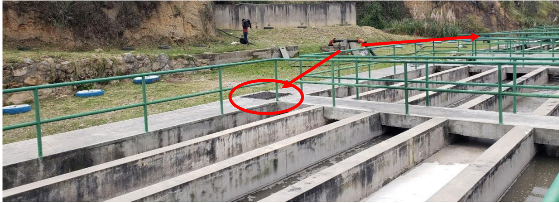
Figura 18: Descarga del agua residual cribada en el tanque Imhoff
