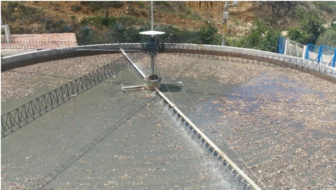
Figura 20: Filtro percolador captado el año 2017
