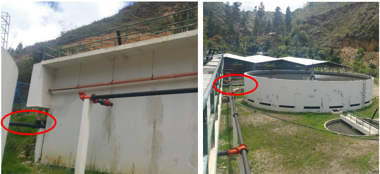
Figura 19: Ingreso de tubería de tanque inmhoff hacia filtro percolador
