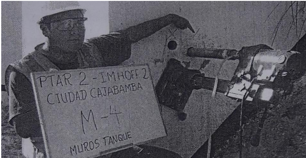
Figura 6: Tecnico muestra el testigo de concreto existente de probeta 2” en el muro lateral del tanque imhoff 02-PTAR 2 dyacente a estructura de lecho de secado Fuente: Gobierno Regional de Cajamarca-PRO REGION
