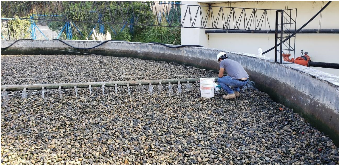
FOTOGRAFÍA N°4: Molinete hidráulico paralizado para toma de muestras
