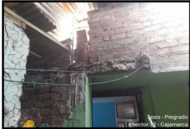
Acero expuesto en viga solera
