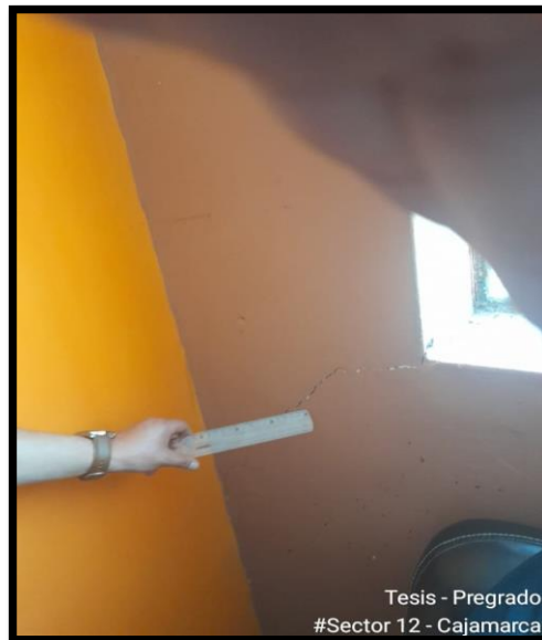
MURO DE VIVIENDA CON FISURAS
