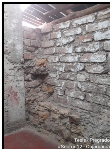
Mala disposición de unidades de albañilería
