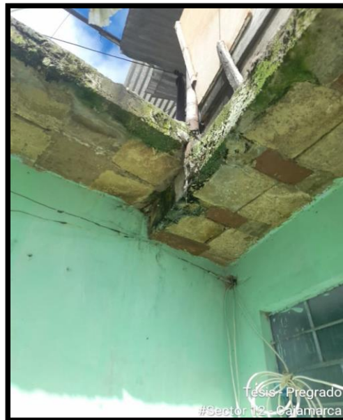
Losa con evidente humedad
