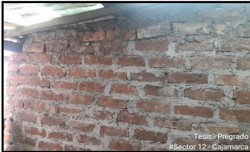
Fotografía N°3: Muro con ladrillo King Kong artesanal
