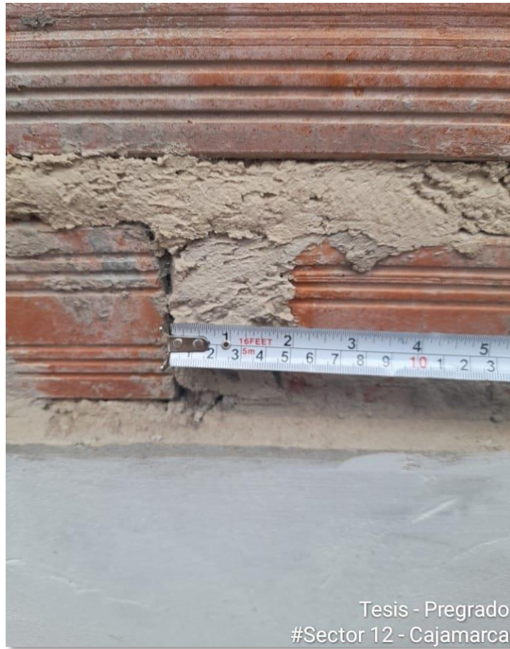
Fotografía N°1: Junta inadecuada en muro de albañilería
