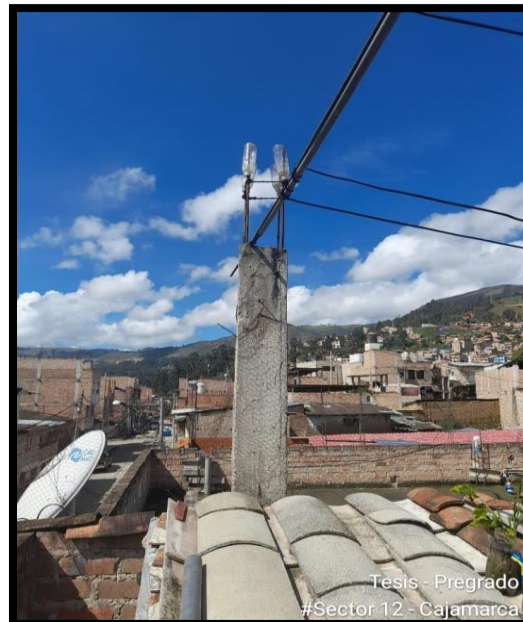
Aceros de columnas expuestos
