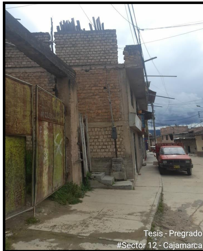
Fotografía N°8: Muros no arriostrados
