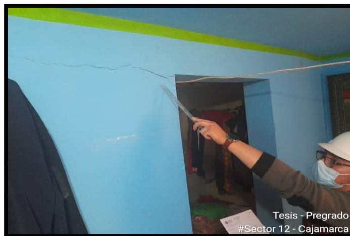
Falla en muro portante
