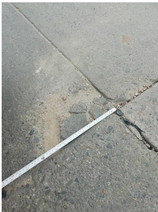
Foto N° 6: Descascaramiento de esquina. Progresiva 1+760.00m
