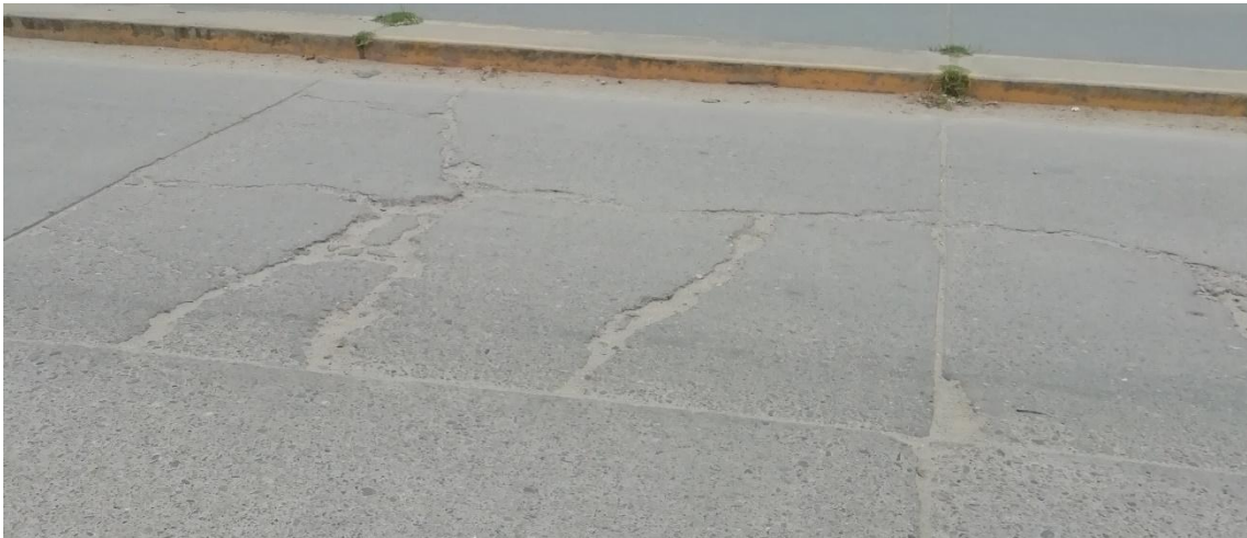
Foto N° 13: Losa Dividida. Progresiva 1+330.00m
