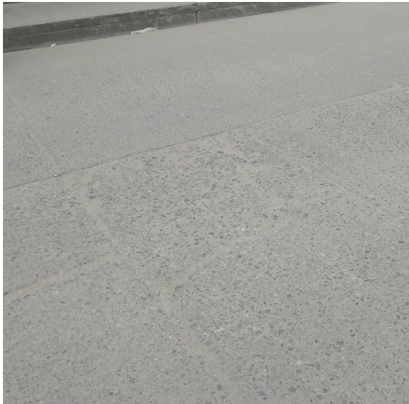
Foto N° 14: Grieta de esquina. Progresiva 1+240.00m
