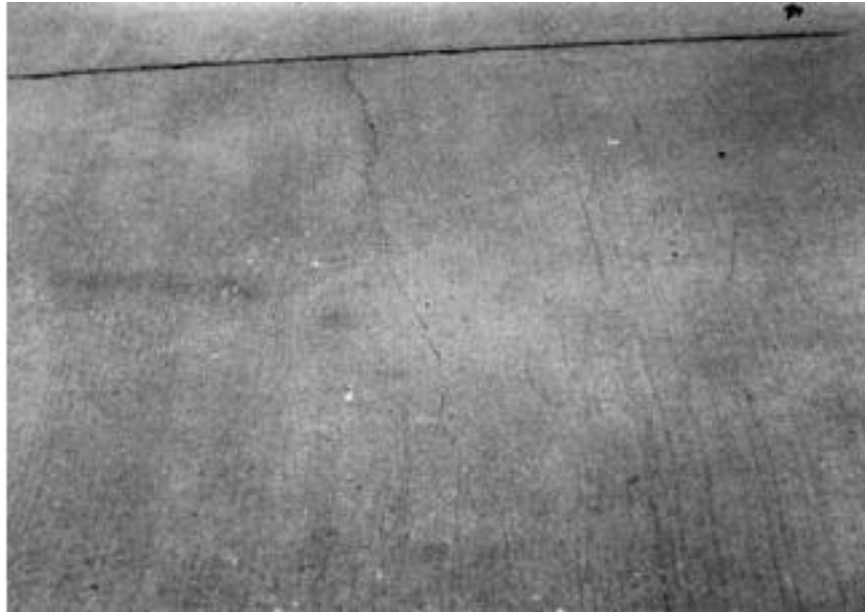
Imagen N° 16: Grietas de retracción.
