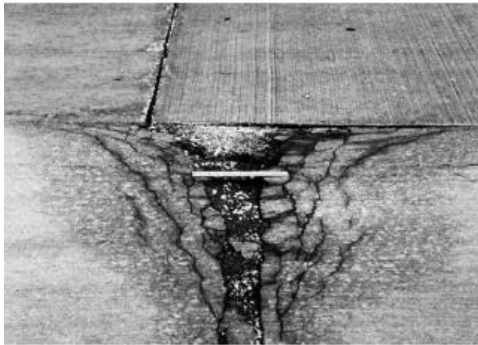
Imagen N° 4: Grieta de Durabilidad “D”
