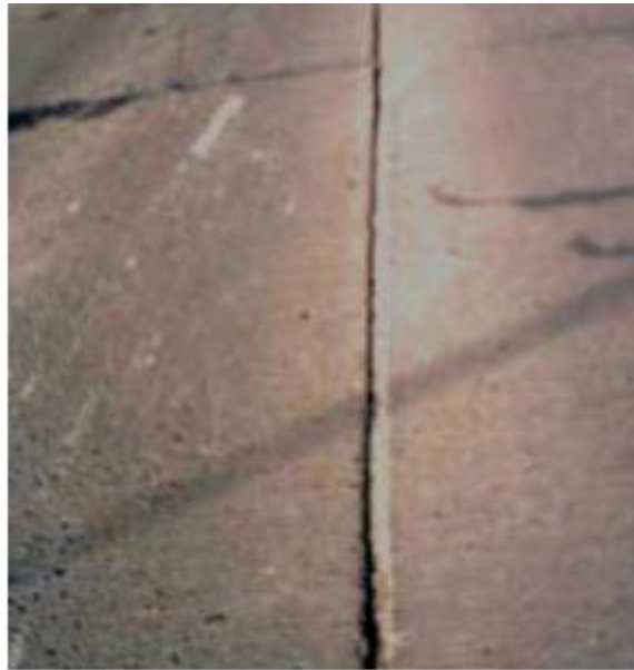
Imagen N° 6: Daño Del Sello De La Junta.
