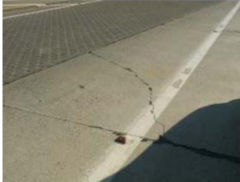
Imagen N° 2 Grieta de esquina.
