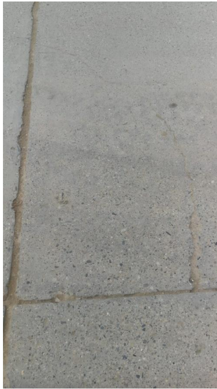
Foto N° 11: Grieta de esquina. Progresiva 1+680.00m
