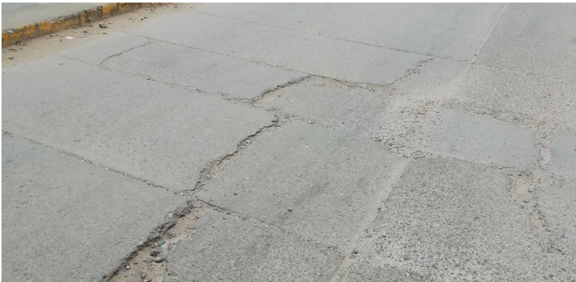
Foto N° 12: Grieta de Lineal. Progresiva 1+345.00m
