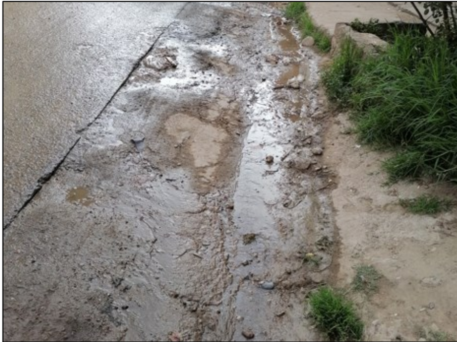
Fotografía 5.28: Cuneta en el Jr: La Libertad, entre Av: San Martín de Porres y Av: Mártires de Uchuracay
