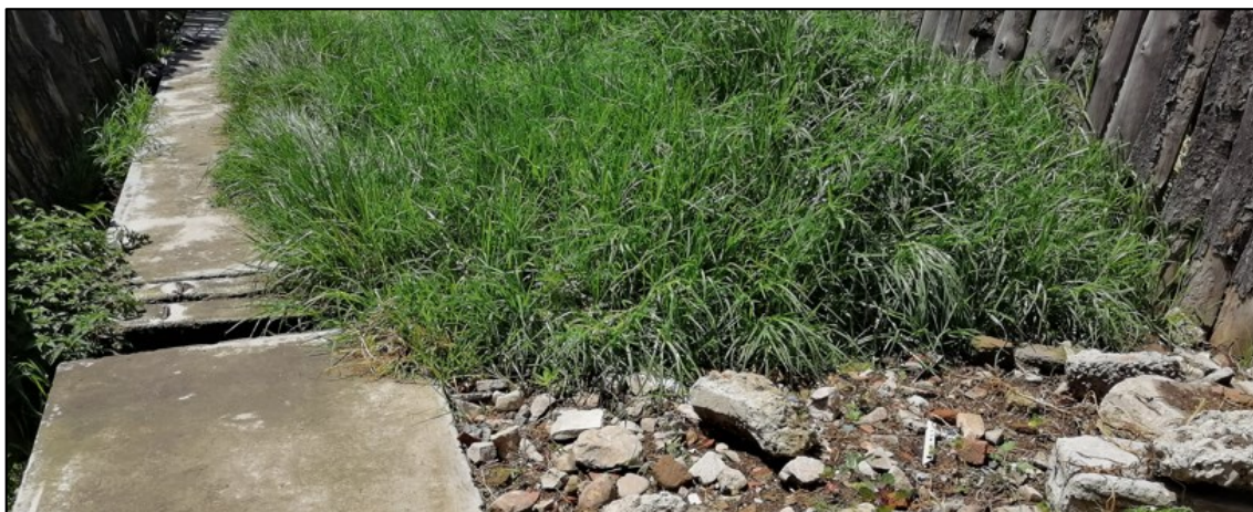
Fotografía 5.65: Fajas marginales en el canal El Ingenio, entre el Jr: Los Gladiolos y Psje: Los Granados
