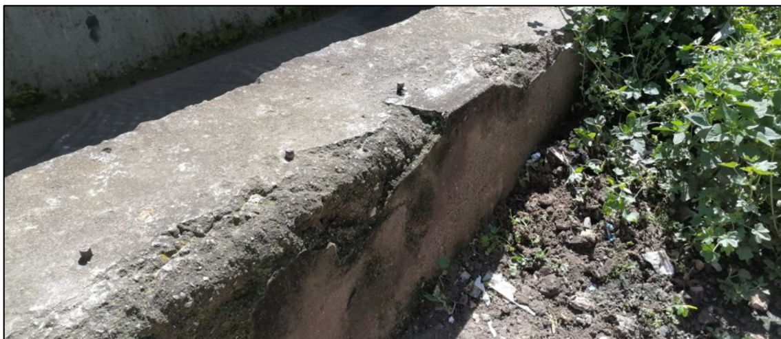
Fotografía 5.63: Estructura hidráulica (muro de encauzamiento) del canal Calispuquio, en la Prolg: E Progreso
