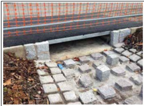
Figura 16: Erosión de suelo en el sistema de biorretención
