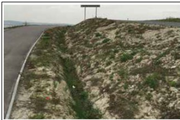
Figura 23: Suelo de siembra de mala calidad en la cuneta verde
