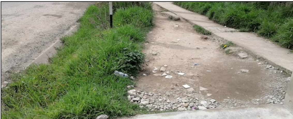
Fotografía 5.23: Vereda y cuneta de la Av: Vía de Evitamiento Sur, entre Av: Atahualpa y Jr: El Milagro
