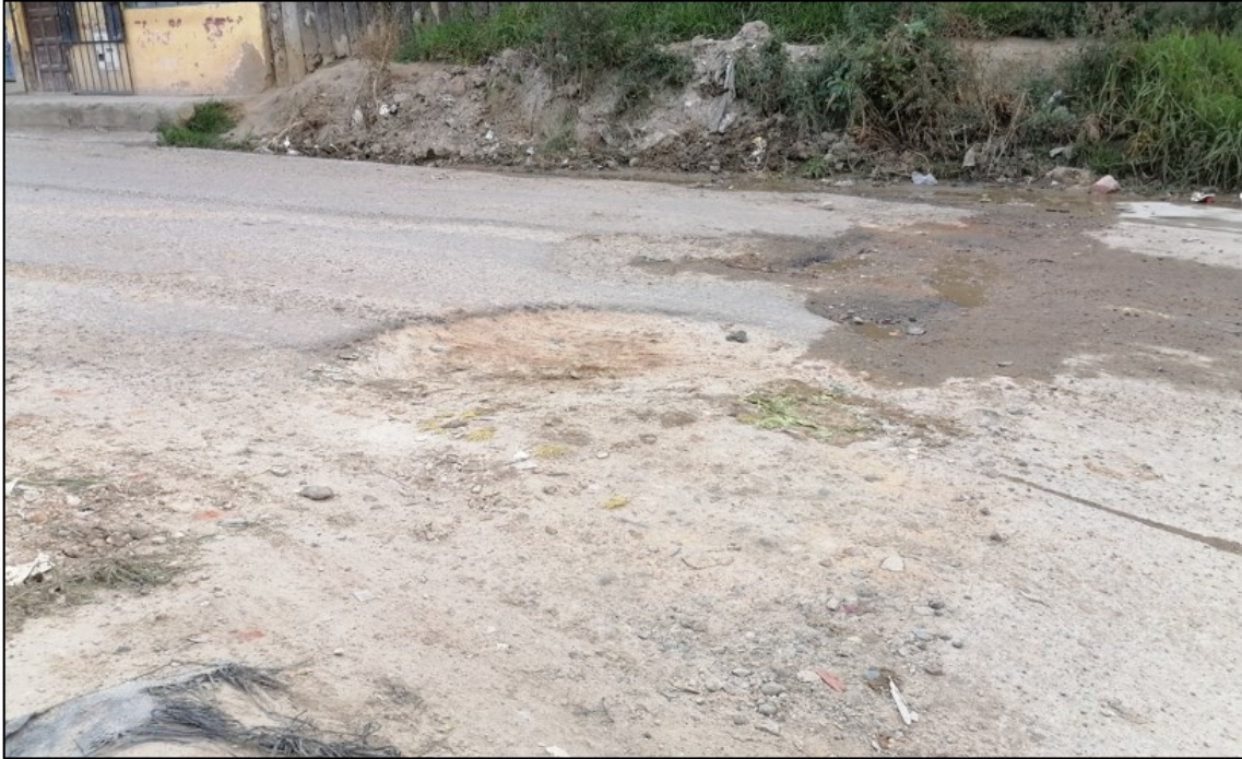
Fotografía 5.27: Calzada en el Jr: La Libertad, entre Av: San Martín de Porres y Av: Mártires de Uchuracay
