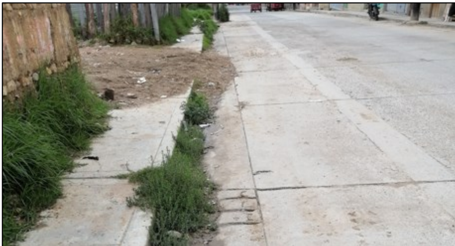
5.31: Vereda, cuneta y calzada en el Jr: Libertadores, entre Av: Mártires de Uchuracay y Jr: Juan Beato Macías
