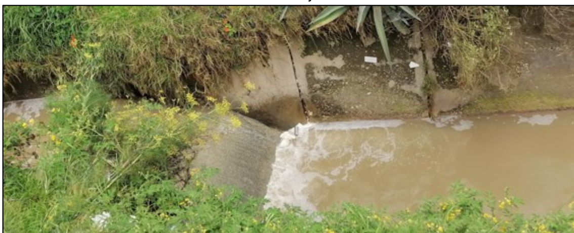
Fotografía 5.62: Estructura hidráulica (colchón de amortiguamiento) en el canal Calispuquio, en la Universidad Nacional de Cajamarca
