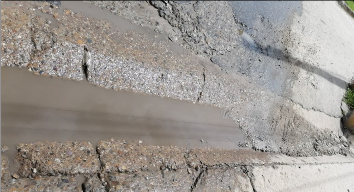
Fotografía 5.55: Badén del Psje: Coricancha
