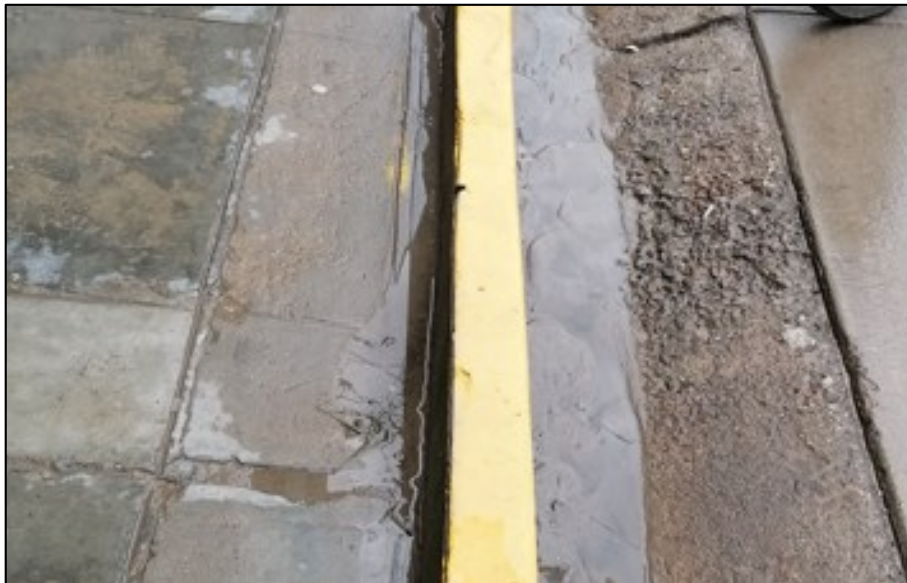
Fotografía 5.25: Cuneta en la Av: San Martín de Porres, entre Jr: El Milagro y Jr: La Libertad
