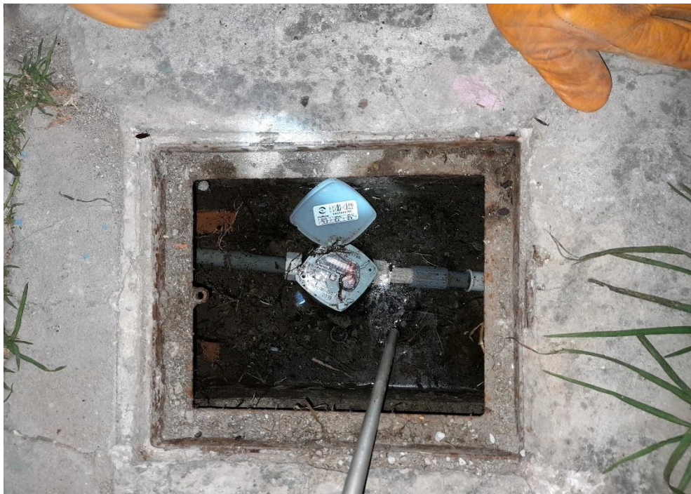
Figura 56: Vista de fugas en caja de medidor.
