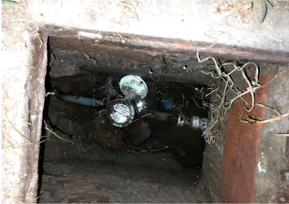
Figura 55: Vista de fuga en caja de medidor.
