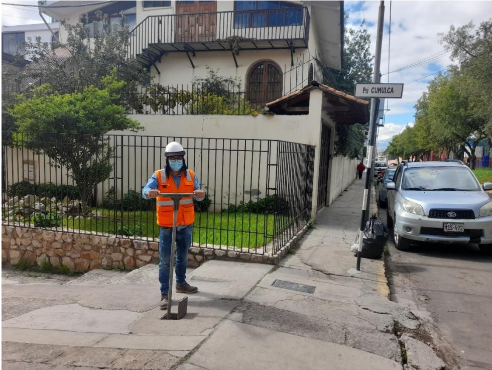
Figura 35: Apertura y cierre de válvulas de control con llave tee.
