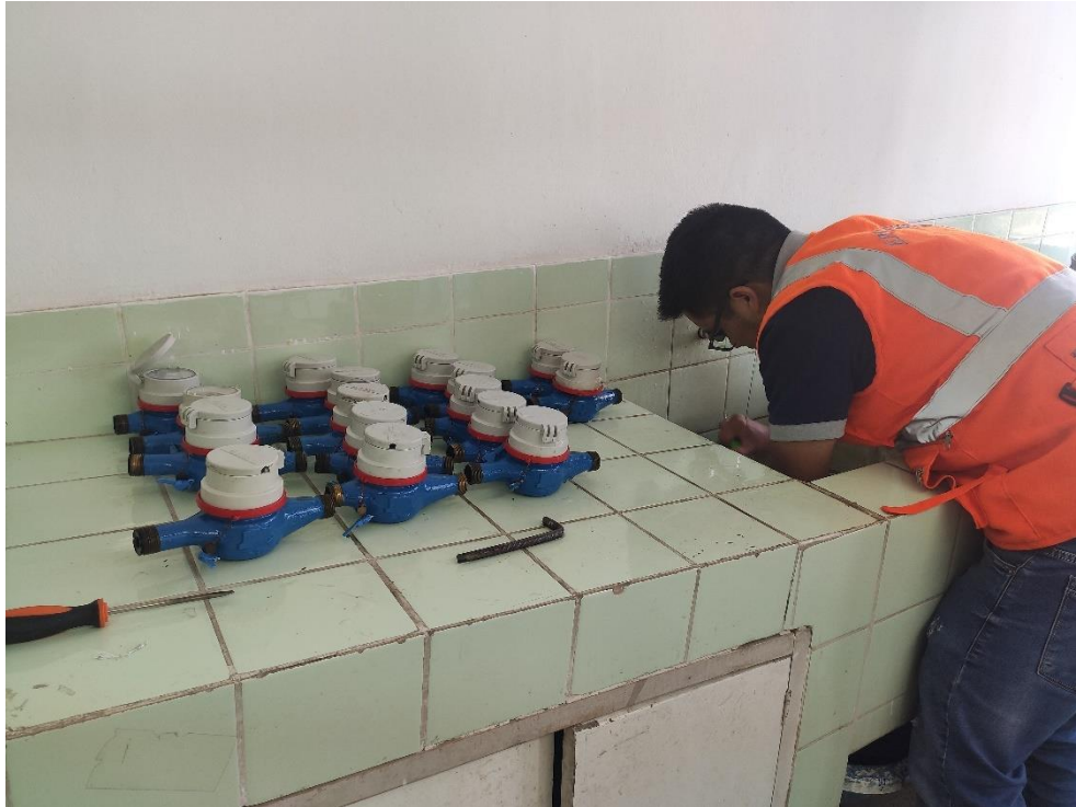
Figura 67: Limpieza de medidores para prueba de contrastación.
