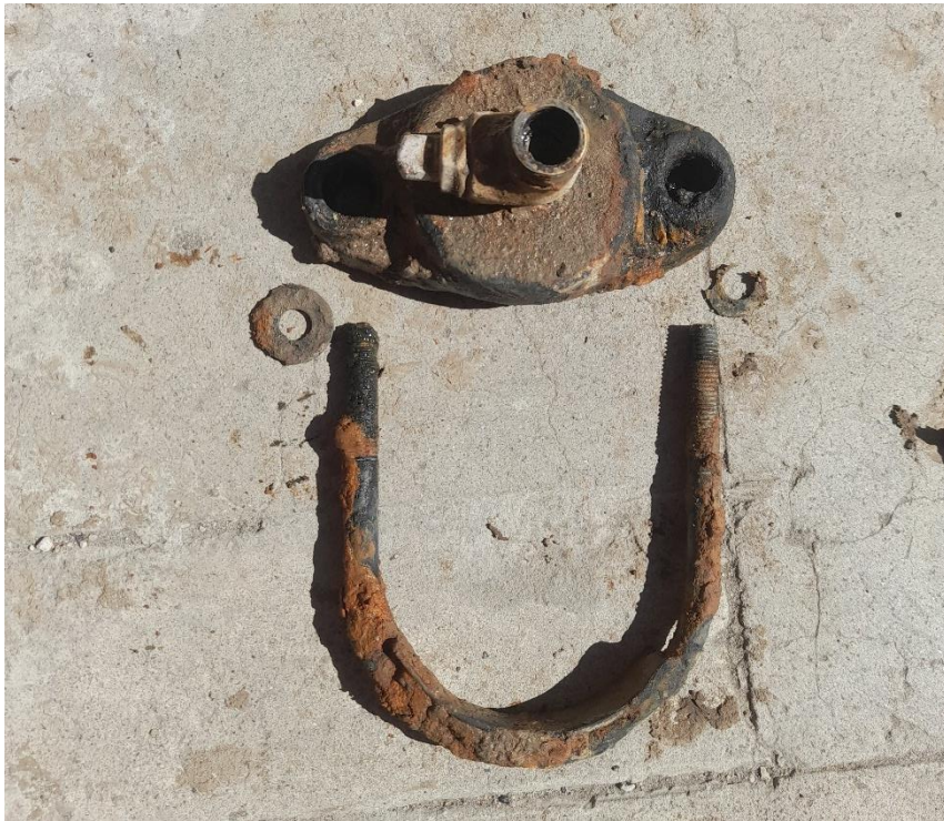
Figura 59: Estado de las abrazaderas instaladas en el sector.
