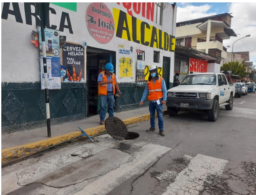
Figura 37: Ubicación cámara de ingreso al sector, Jr. Progreso – Av. El Maestro.
