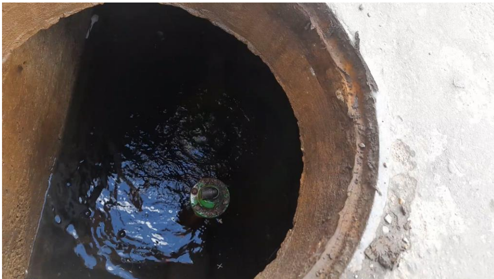
Figura 51: Fuga visible en cámara de ingreso al sector.
