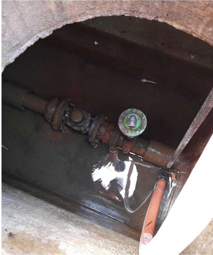
Figura 52: Estado de macromedidor en cámara de ingreso al sector.
