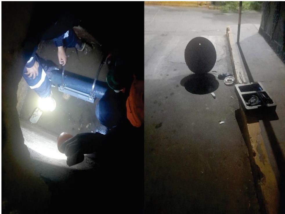
Figura 49: Instalación caudalímetro portátil.
