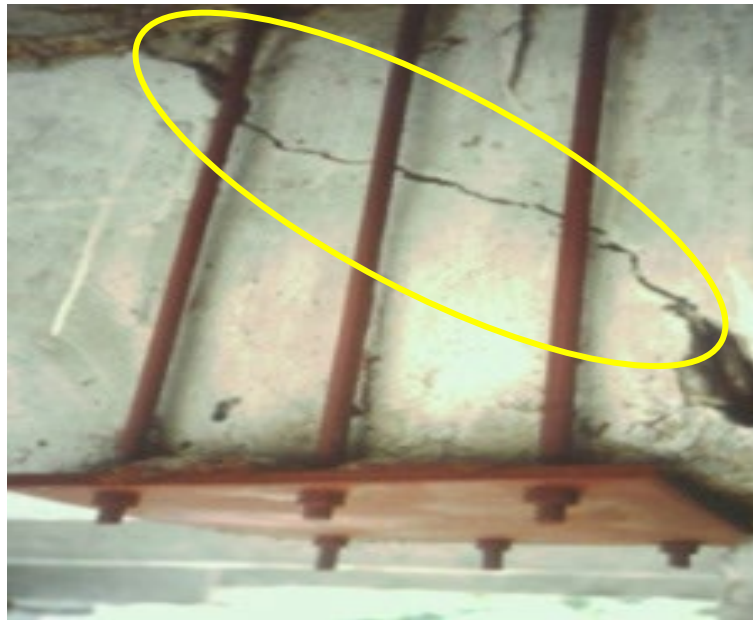
Figura N°6 Grieta a cortante en viga principal de concreto reforzado
