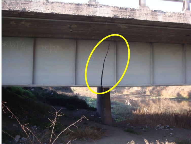
Figura N°8 Falla en elementos de acero después de un sismo (Vigas principales) Fuente: Muñoz, 2020.
