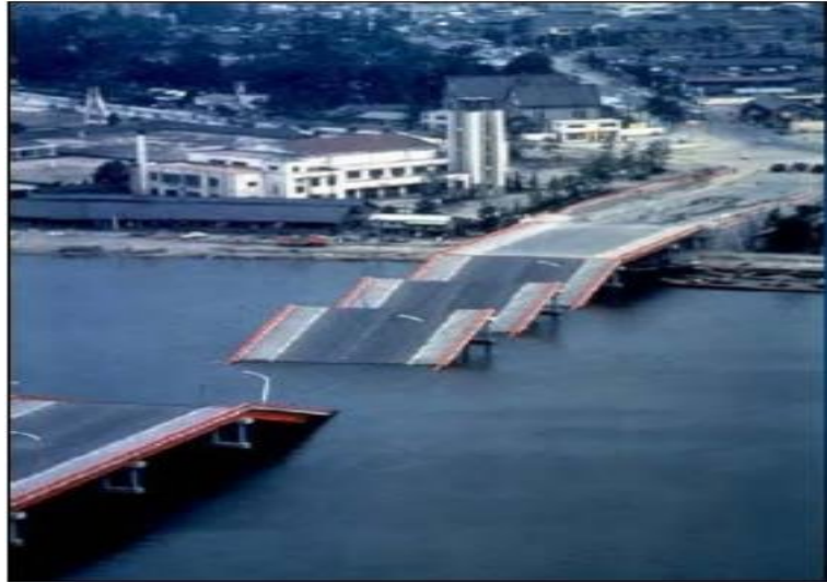
Figura N°4 Colapso del puente Showa durante el sismo de Nigata, 1964. Falla por licuación Fuente: Alvaque, 2011.
