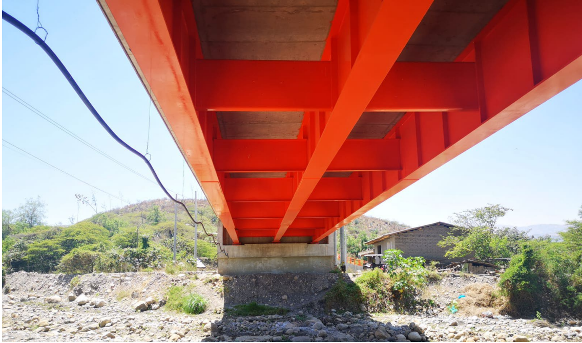
Fotografía N°05: Inspección in situ del estado actual del puente Malcas (Vigas Principales y transversales).
