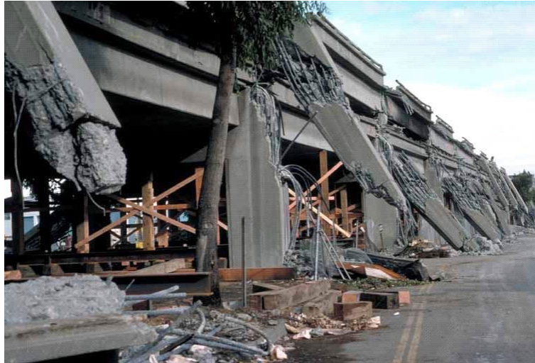
Figura N°7 Falla en los nodos
