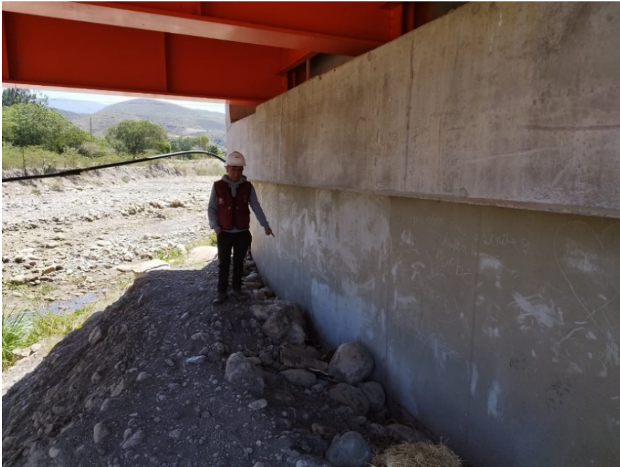
Figura N°30 Estado de socavación del puente Malcas Fuente: Elaboración Propia
