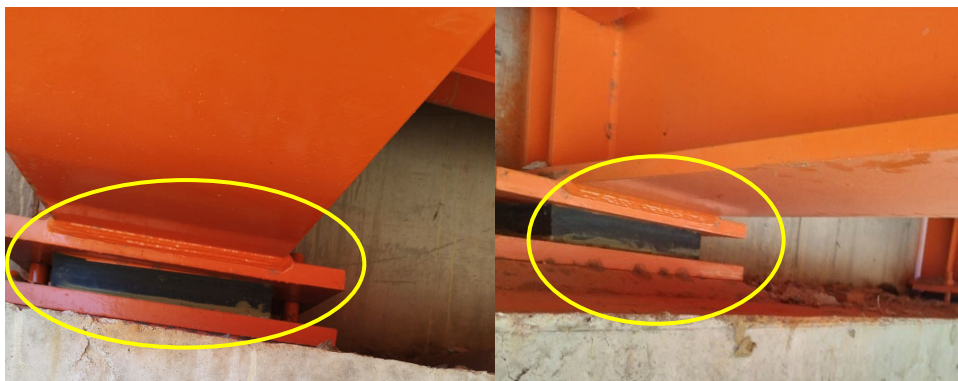
Figura N°31 Estado de conservación de los apoyos del puente Malcas Fuente: Elaboración Propia.
