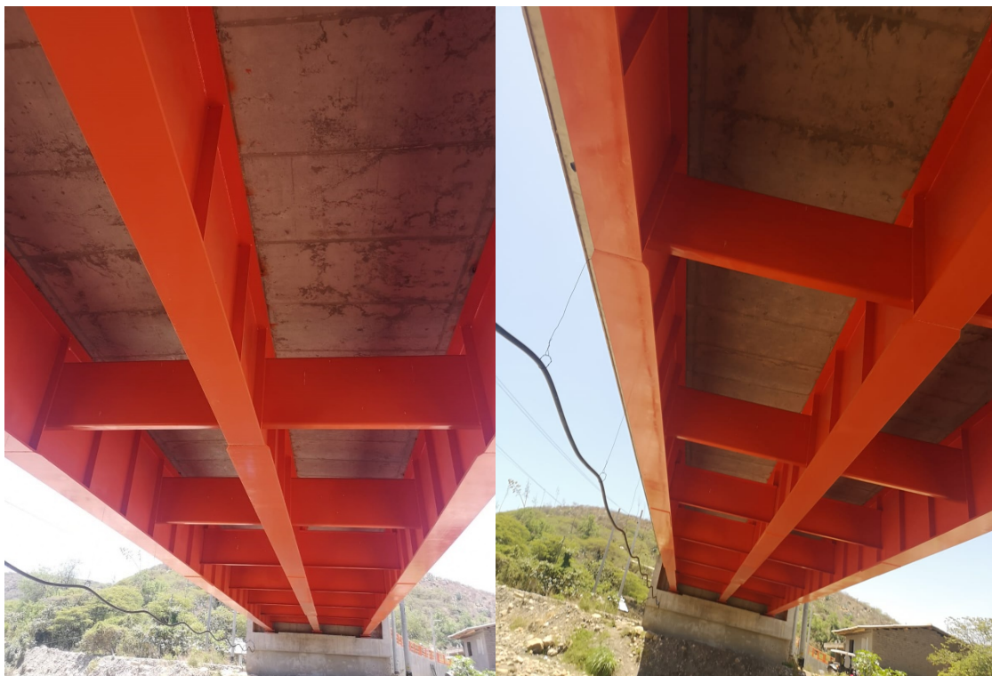
Figura N°33 Estado actual de las vigas metálicas del puente Malcas
