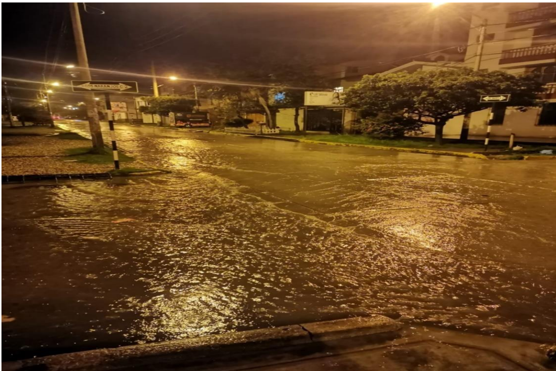
FOTOGRAFÍA N° 13 Falla del sistema de drenaje del Jirón Los Sauces cuadra 4 -
