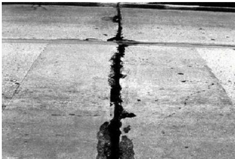
Figura 4. Daño del sello de la junta.
