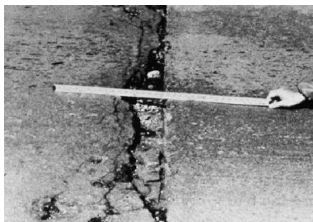
Figura 14. Descascaramiento de junta.
