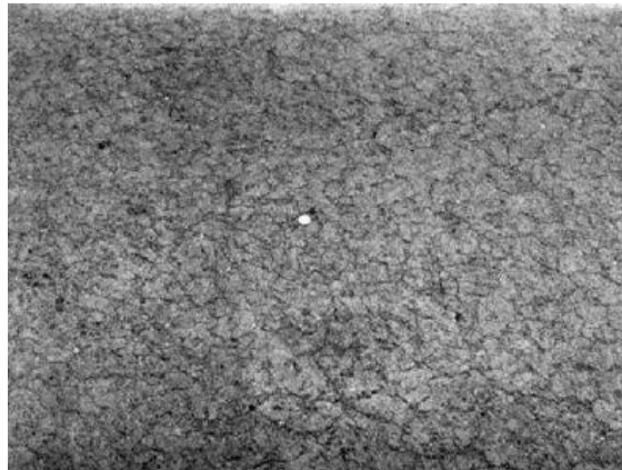
Figura 11. Mapa de fisuras.
