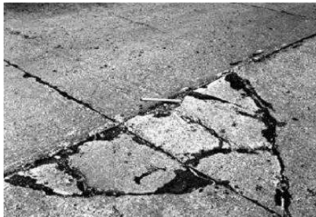
Figura 2. Fisura de esquina.
