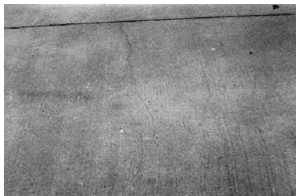
Figura 12. Fisuras de contracción.
