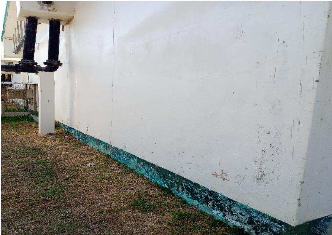
Figura 33: Presencia de humedad en la parte lateral inferior del tanque Imhoff N°02
