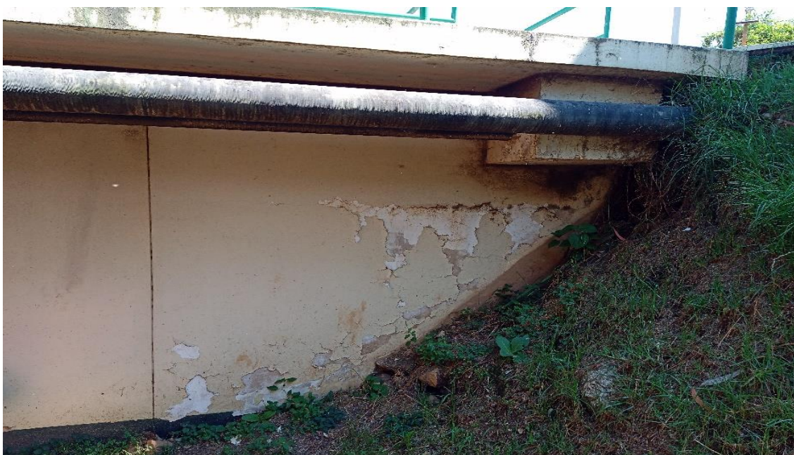
Figura 30: Deterioro de la pintura en la parte lateral del tanque Imhoff N°01
