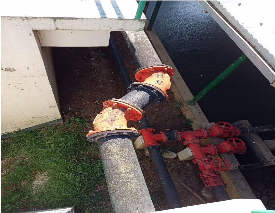
Figura 28: Tubería HDPE que va desde la cámara de repartición hasta el tanque Imhoff N°02
