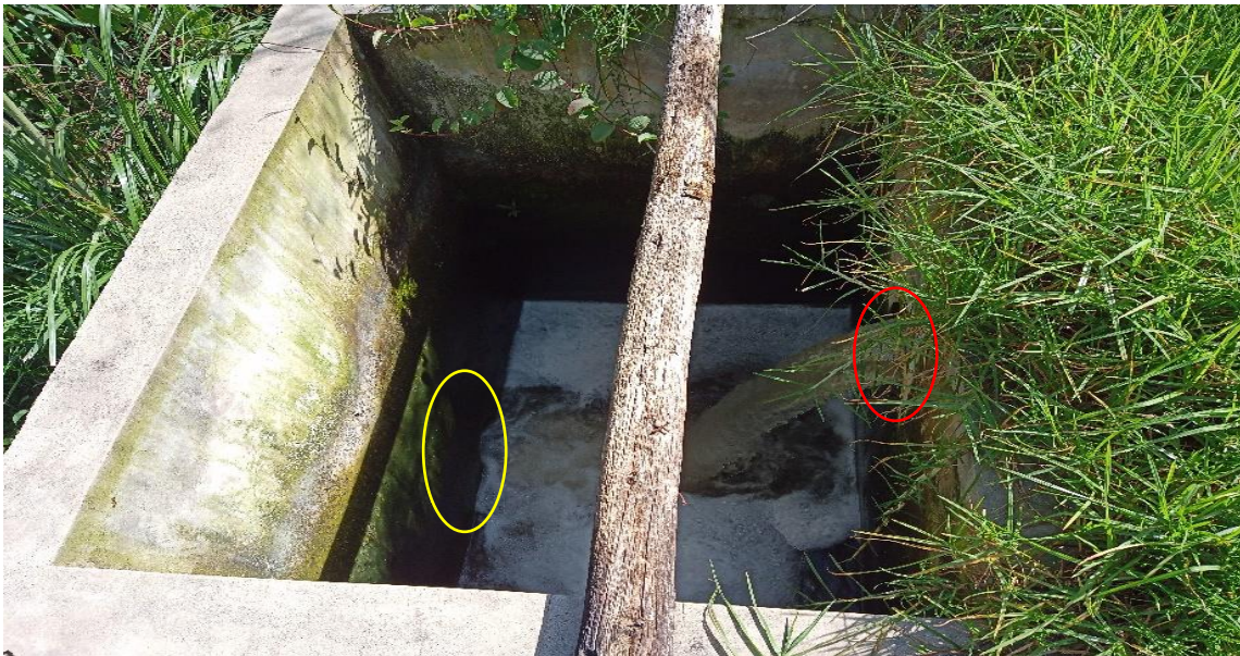
Figura 42: Disposición final del agua residual tratada
