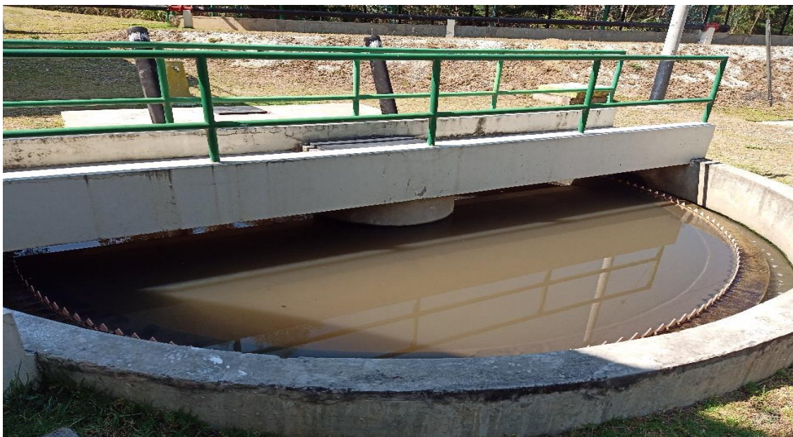
Figura 39: Tanque Dortmund N°02
