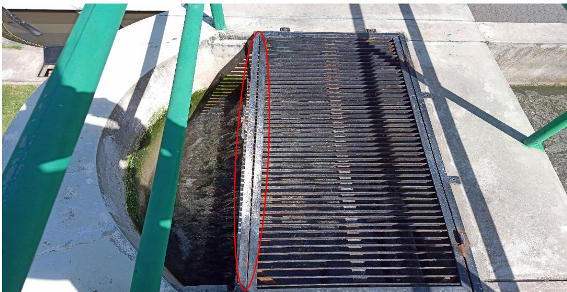
Figura 50: Rejilla por la que pasa el agua antes de ir a la cámara de reunión
