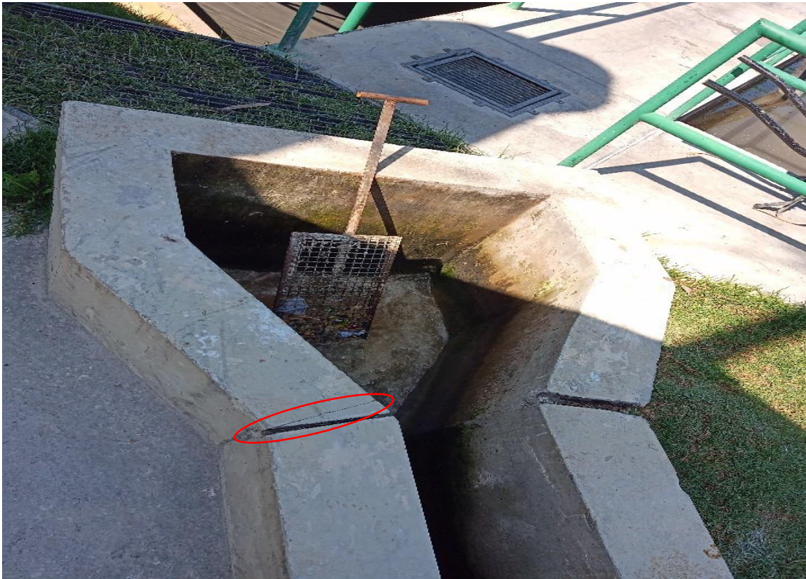
Figura 27: Fisura en la cámara de repartición de caudal
