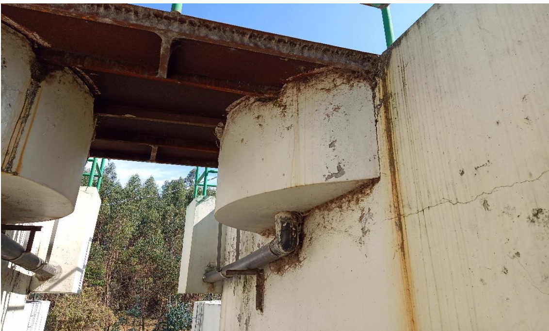
Figura 32: Aparición de grietas en la pared oeste del tanque Imhoff N°01
