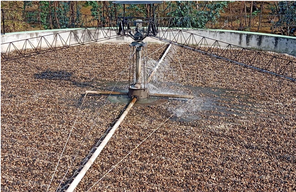
Figura 56: Sobrecarga hidráulica en el filtro percolador
