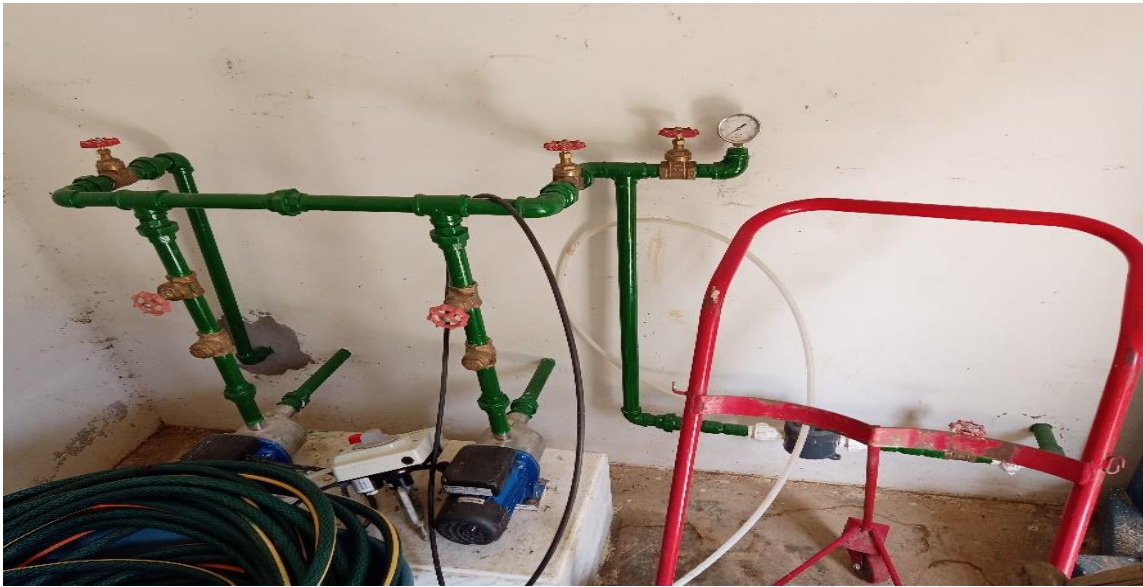
Figura 41: Tuberías para la dosificación
