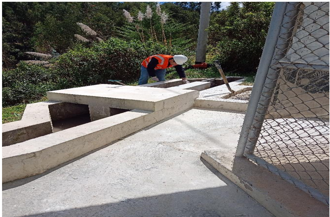
Figura 21: Medición de las dimensiones del by pass
