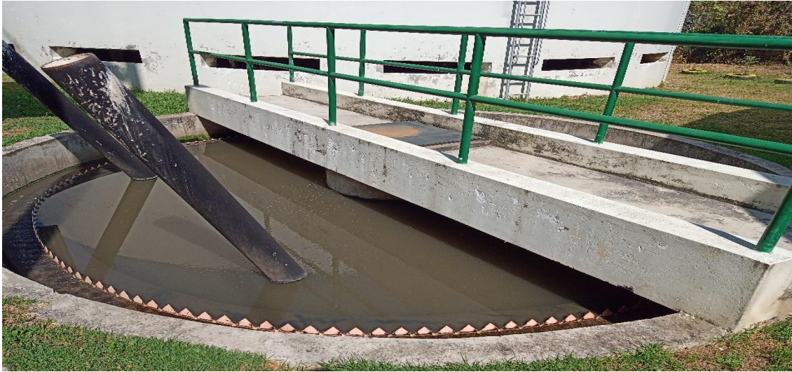
Figura 38: Tanque Dortmund N°01
