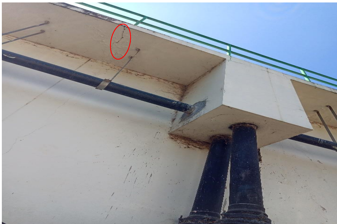
Figura 34: Grieta en la parte que sirve para el tráfico peatonal del tanque Imhoff N°02
