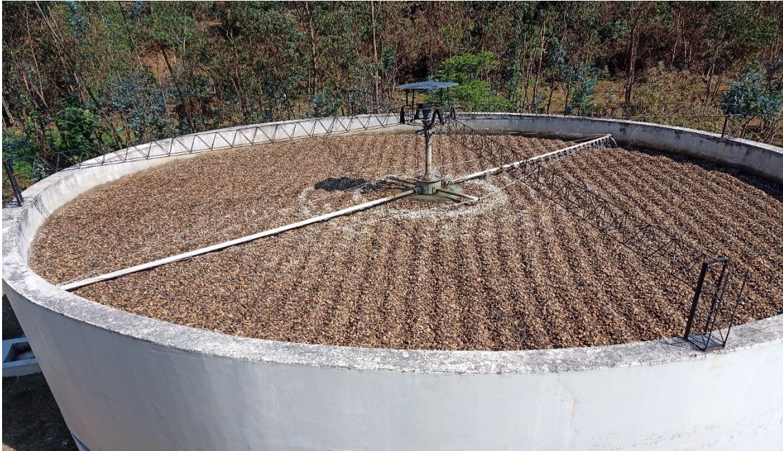
Figura 54: Filtro Percolador N°02
