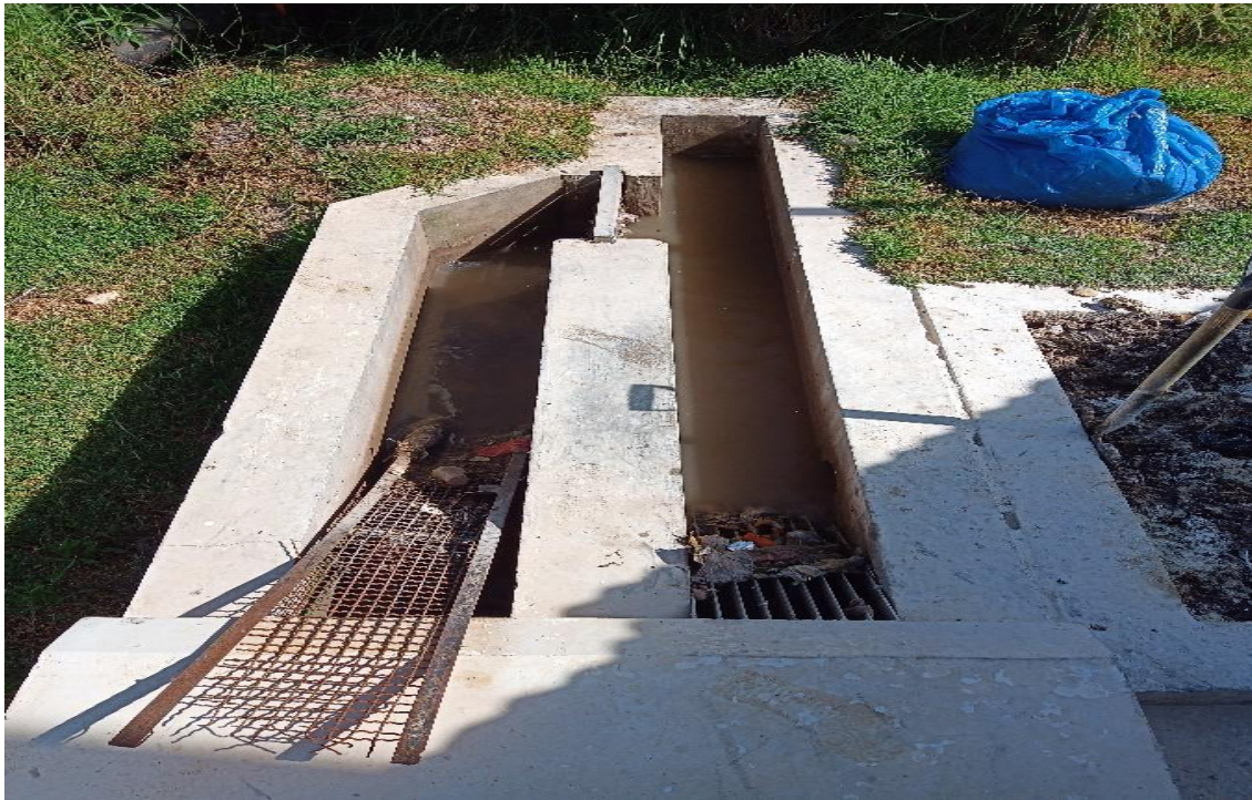
Figura 20: Canal de alimentación principal y by pass
