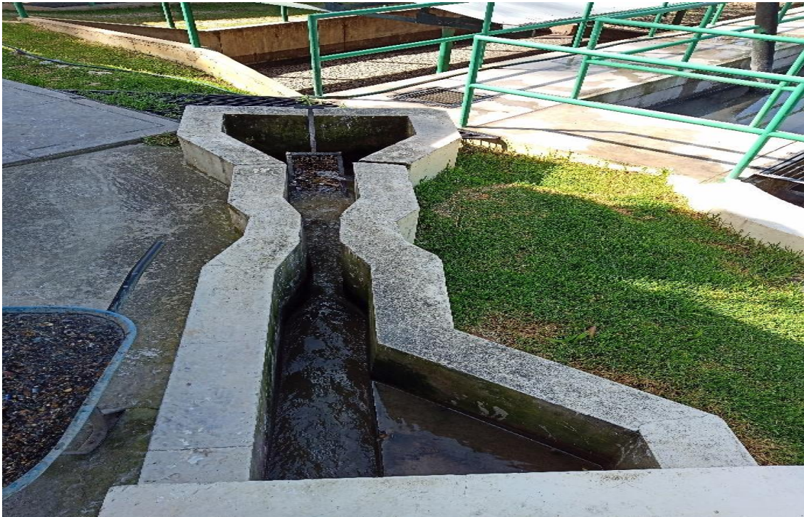
Figura 26: Medidor de caudal
