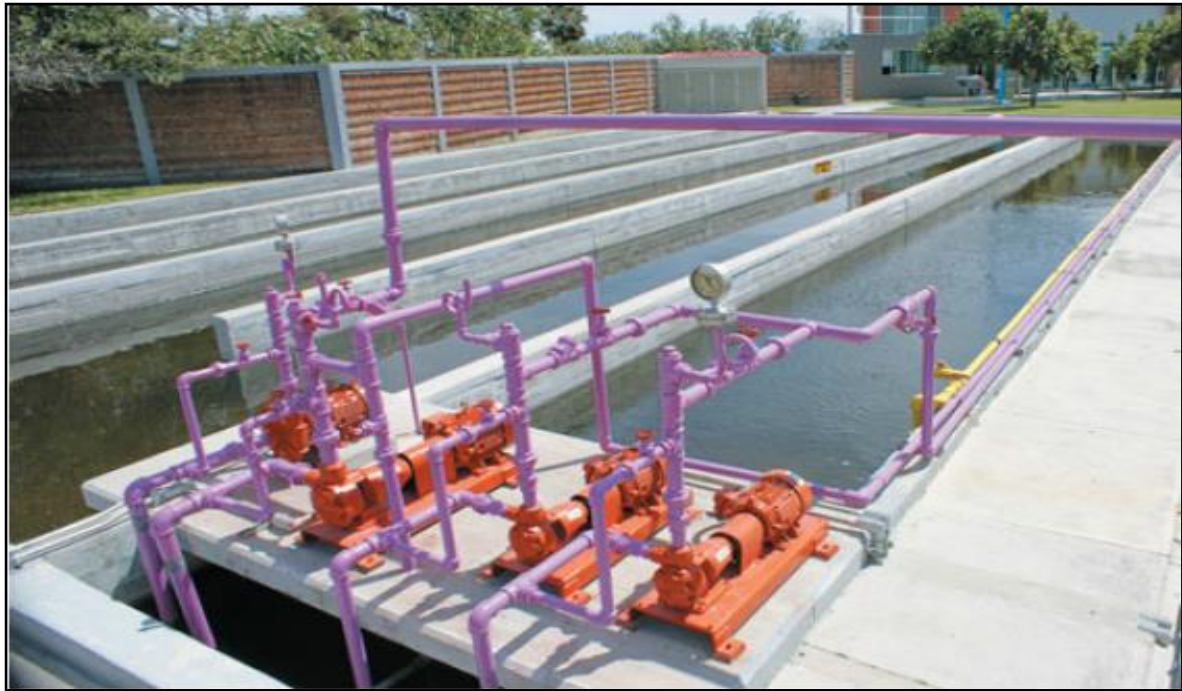
Figura 8: Parte del sistema de cloración.
