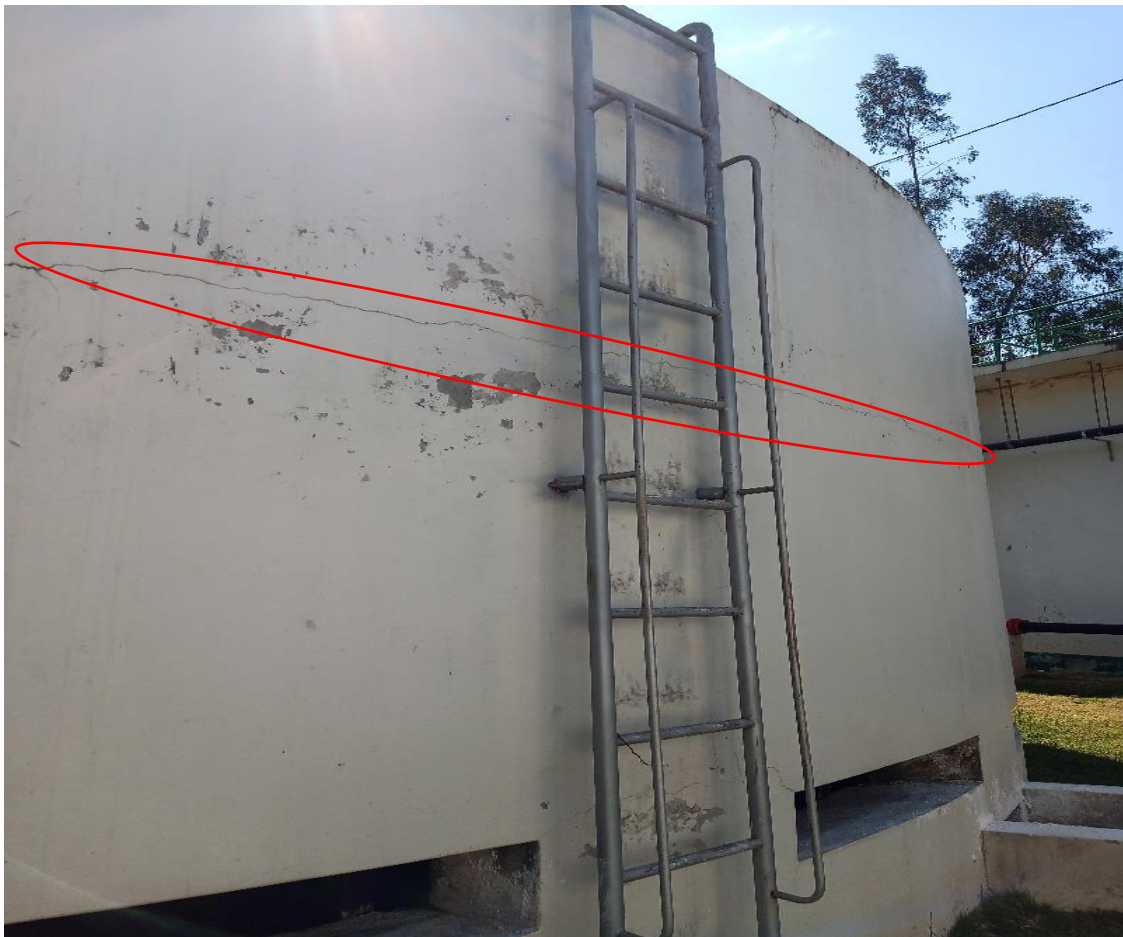
Figura 36: Agrietamiento en el filtro percolador N°01
