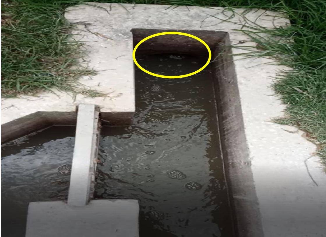
Figura 19: Ingreso de las aguas residuales crudas a la PTAR mediante una tubería PVC
