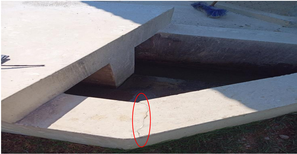
Figura 23: Grieta en la pared que pertenece a la parte final del by pass
