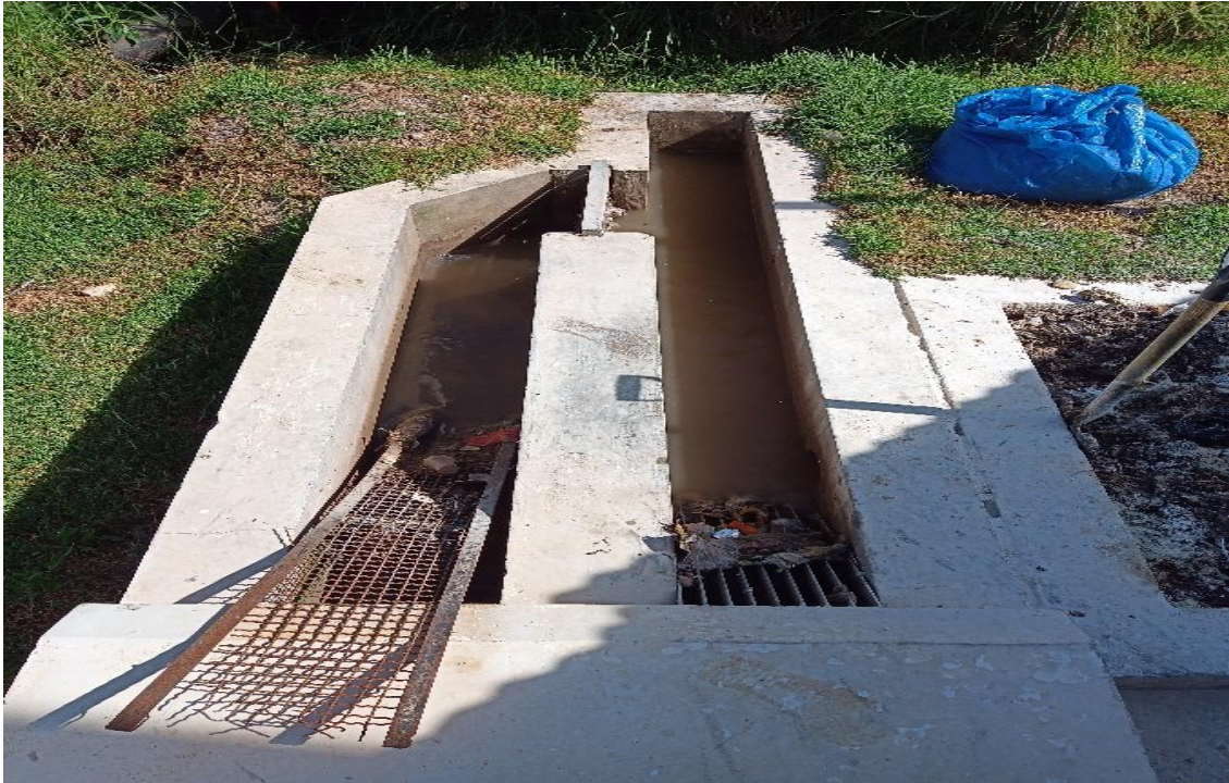
Figura 20: Canal de alimentación principal y by pass
