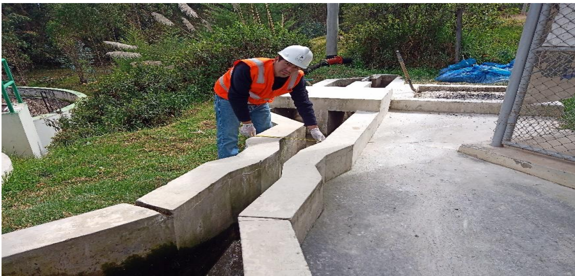
Figura 24: Medición del ancho de entrada al medidor de caudal
