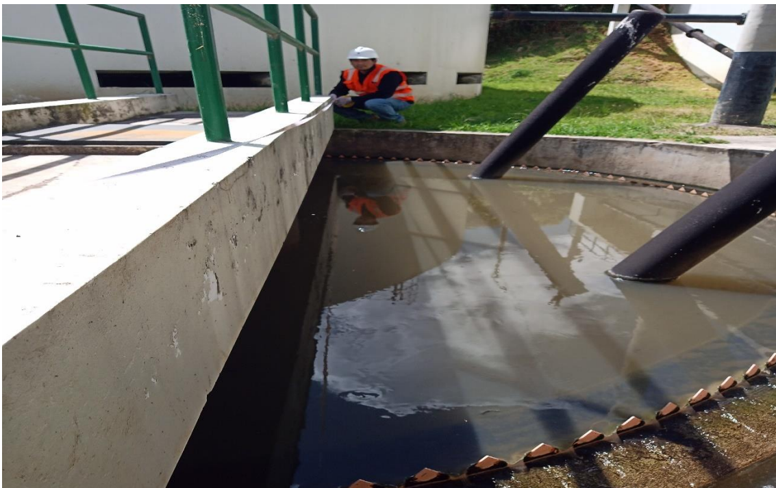
Figura 57: Sedimentador Secundario o Tanque Dortmund
