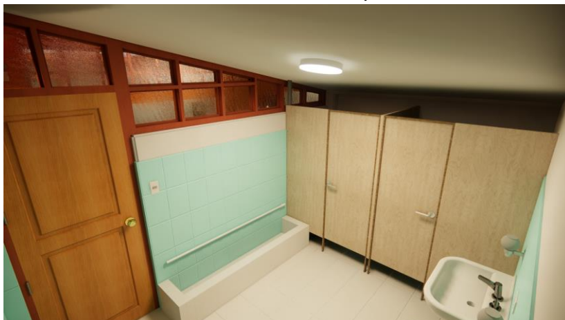
Figura N° 86: Gabinetes de inodoros sin iluminación en el SS.HH. de varones de la Sala de Usos Múltiples
