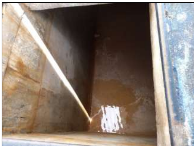
Figura N°3. Interior del reservorio N°1, minerales pegados en las paredes.
