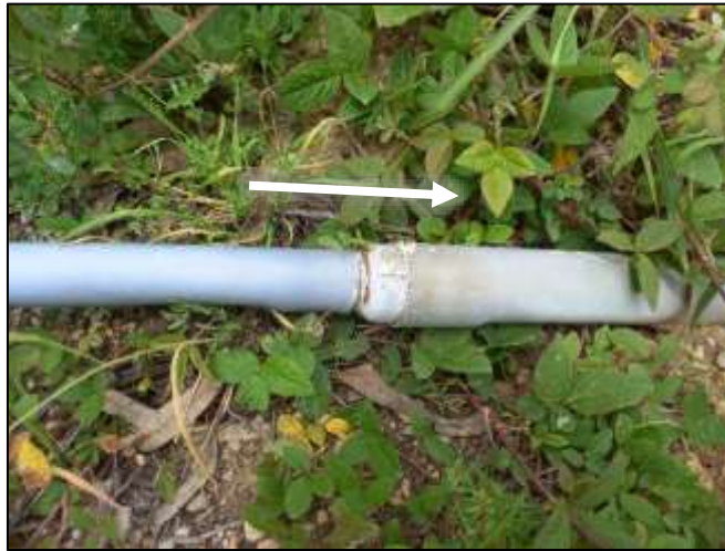
Figura N°5. Ampliación de tubería, mala unión.
