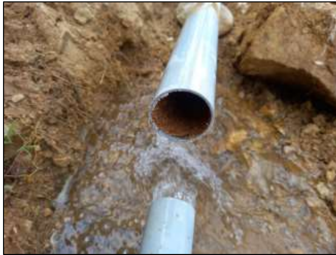
Figura N°14. Adherencia de sarro en la pared interior de la tubería de la L.C.
