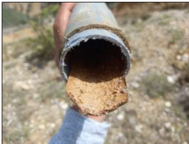
Figura N°15. Reducción del diámetro de la tubería ante la presencia de sarro.
