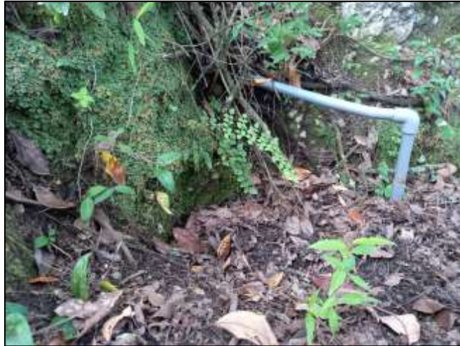
Figura N°10. Codo de 90° innecesarios en la L.C.
