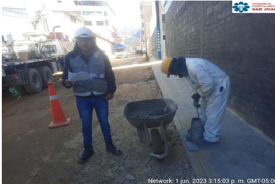
Fotografía N°03. Prueba de asentamiento antes del vaciado del elemento estructural losa de techo y vigas.
