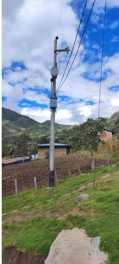
Figura 30: Poste de media tensión que recibe la derivación desde la estación Chiquinda, en la parte posterior de la municipalidad distrital de Oxamarca.
