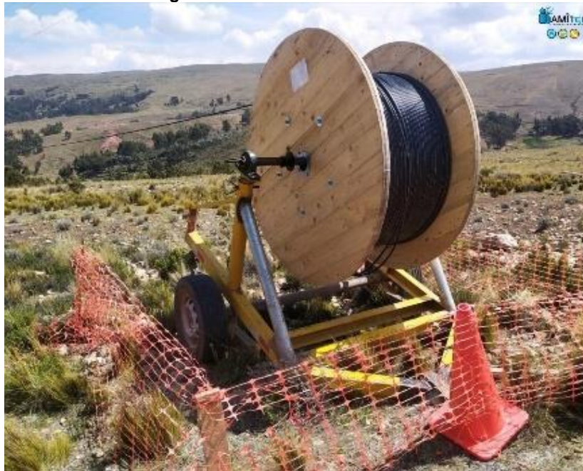
Fuente: AMITEL PERÚ TELECOMUNICACIONES S.A.C. [63].
