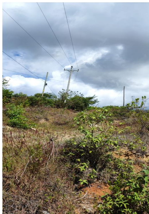
Figura 27: Torre MT Trancapampa
