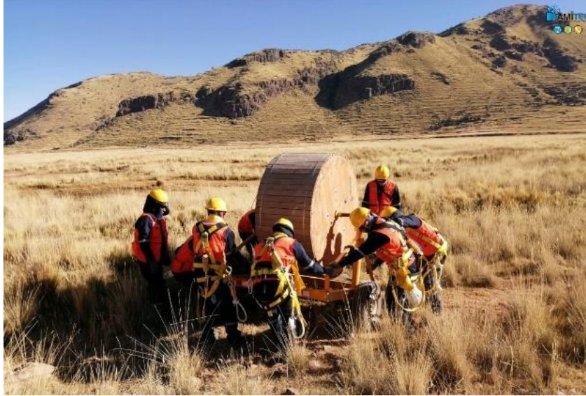
Fuente: AMITEL PERÚ TELECOMUNICACIONES S.A.C. [63].
