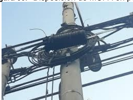
Figura 66: Disposición de MUFA en poste
