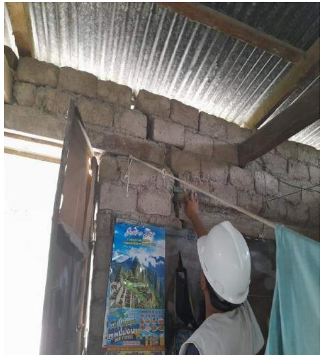
Grietas cerca a vanos, puertas y dintel.
