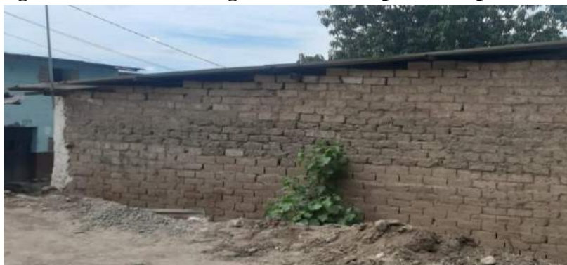
Figura 3.21. Muro en regular condición por intemperización.
