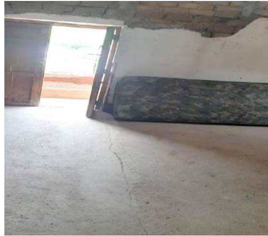
Figura 3.25. Segundo nivel sin adecuada distribución de muros.
