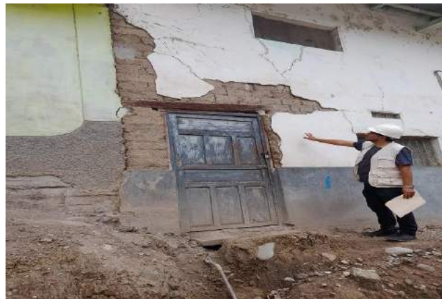
Vivienda afectada por sismo, grietas y desprendimientos de enlucido.
