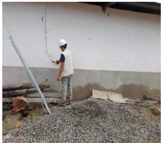
Grieta mayor a 5 mm en parte externa del muro.
