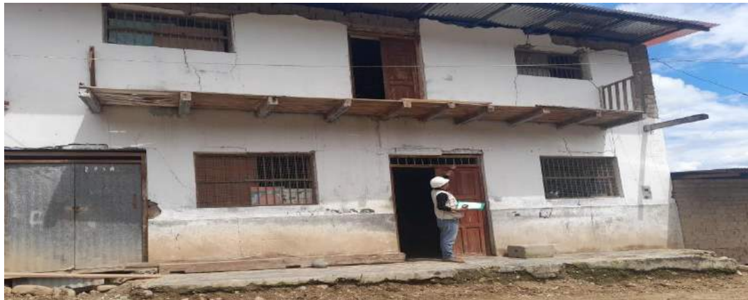
Figura 3.38. Vivienda en estado de deterioro, dintel de madera expuesto.
