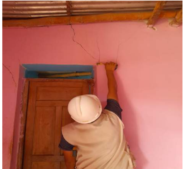
Presencia de fisuras cerca a vanos y puertas.
