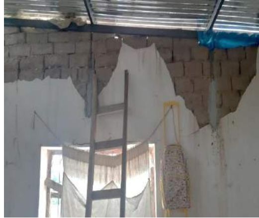
Figura 3.42. Desprendimiento de enlucido en segundo nivel.
