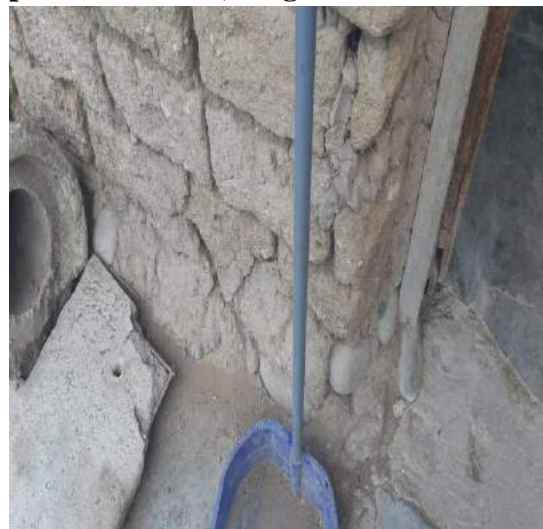
Figura 3.27. Adecuada trabazón entre piezas de adobe, desgaste en la misma.
