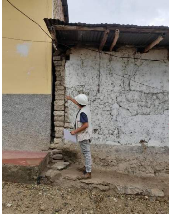
Vivienda con piezas de adobe sin verticalidad uniforme.
