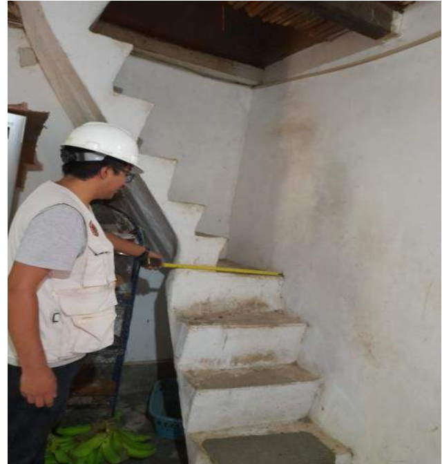
Escalera con poca sección, difícil acceso a segunda planta y evacuación.
