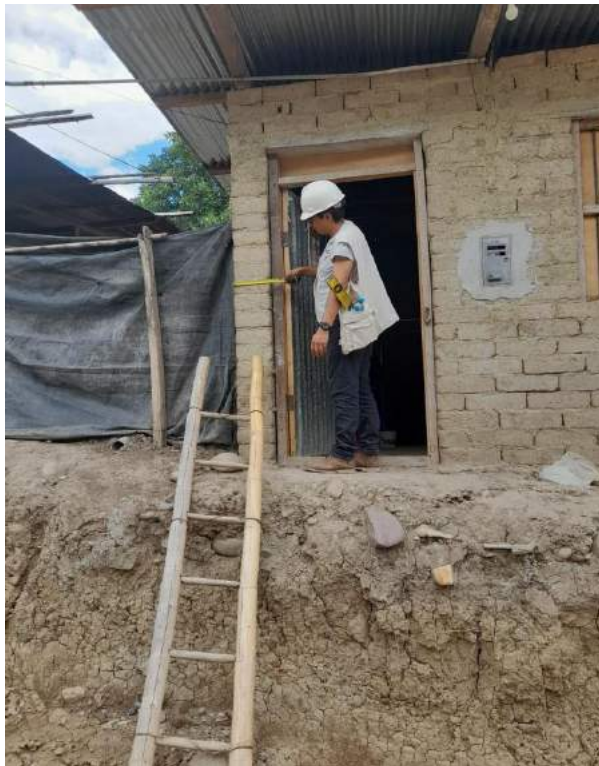
Medición de ancho de muro, dificultad de acceso a la vivienda con escalera provisional.
