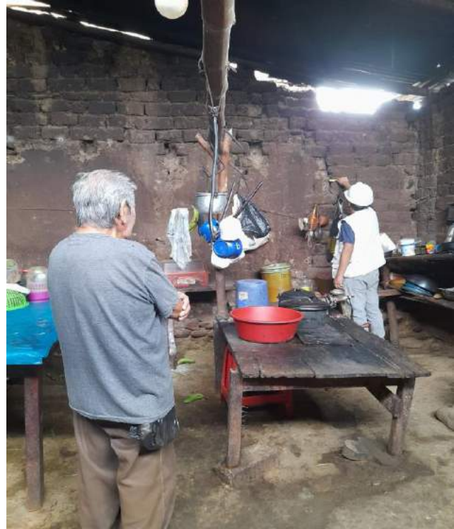
Muros en mal estado de conservación.
