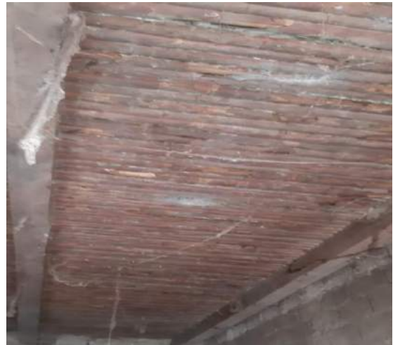
Figura 3.33. Pasadizo en mal estado de conservación.
