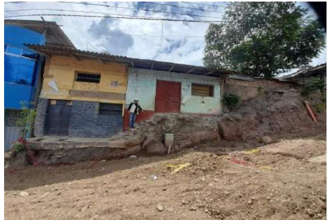
Viviendas con corte en calle, que afecta el acceso y evacuación.
