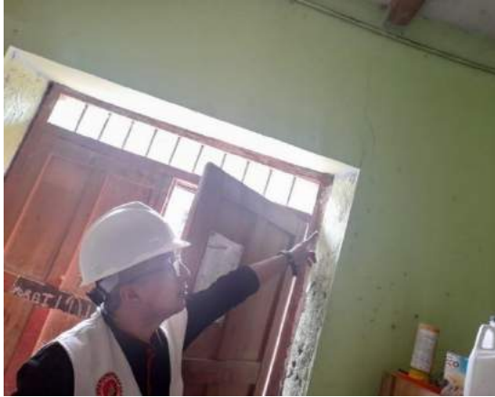
Figura 3.41. Enlucido en mal estado en puerta.
