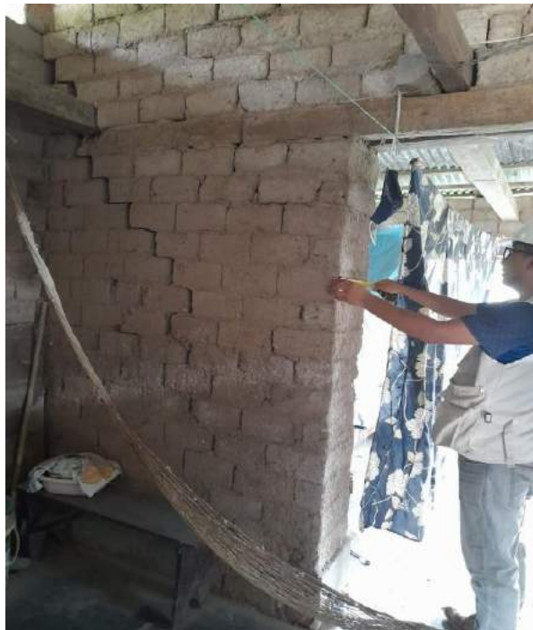
Grieta oblicua en muro interno.
