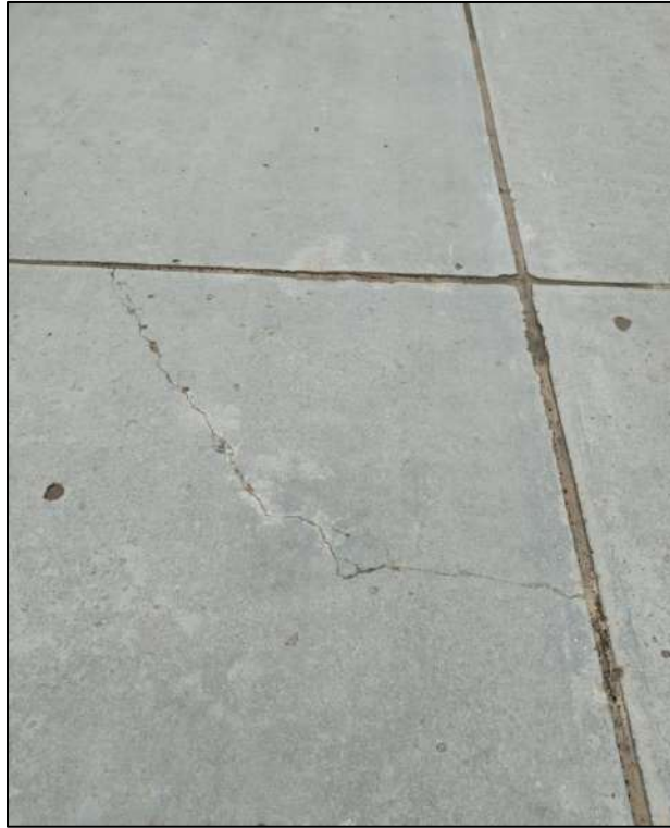
Figura 77: Grieta de esquina, observada en la UM-07 de la Sección 02.
