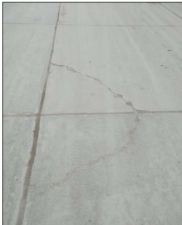
Figura 78: Grieta de esquina, observada en la UM-09 de la Sección 02.
