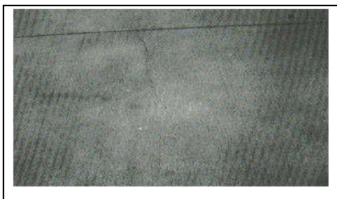
Figura 48: C37. Grietas de contracción.
