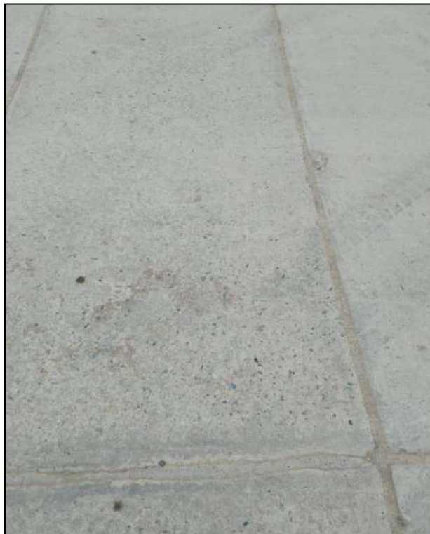
Figura 90: Pulimiento de agregados, observada en la UM-03 de la Sección 01.
