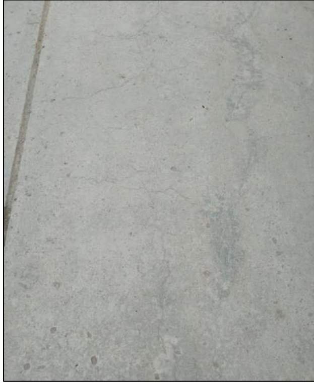
Figura 99: Grietas de retracción, observadas en la UM-02 de la Sección 01.
