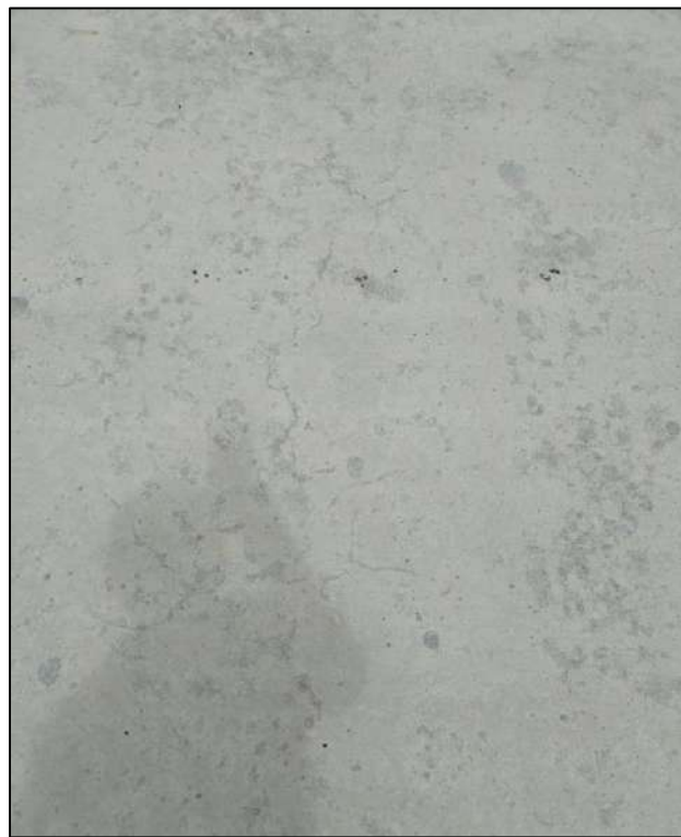
Figura 100: Grietas de retracción, observadas en la UM-02 de la Sección 01.
