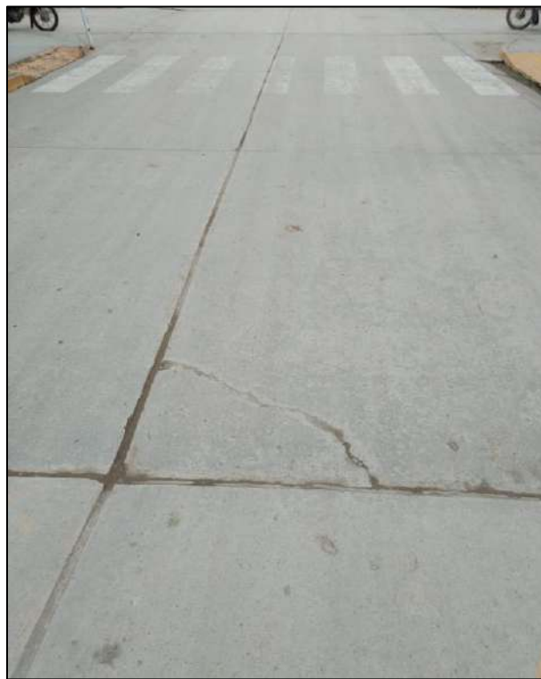
Figura 76: Grieta de esquina, observada en la UM-07 de la Sección 01.
