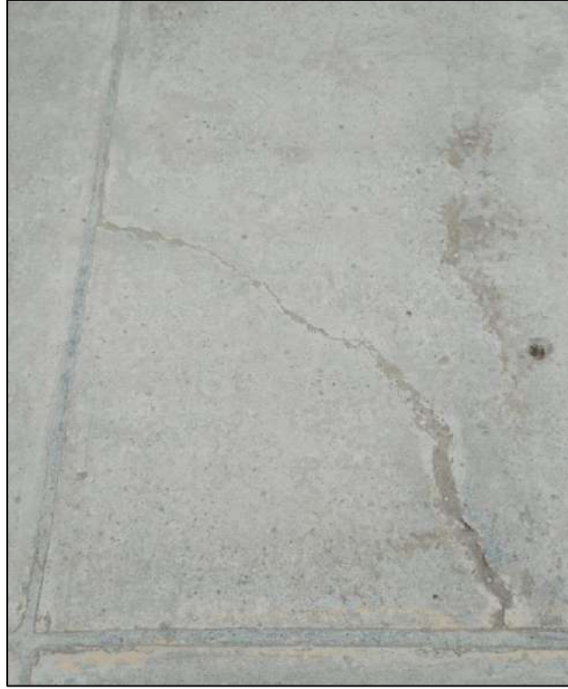
Figura 75: Grieta de esquina, observada en la UM-01 de la Sección 01.
