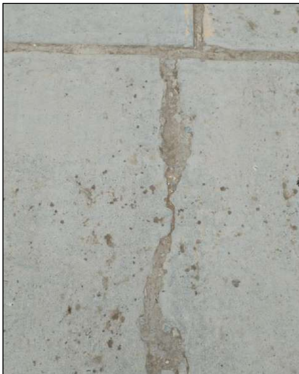
Figura 85: Grieta lineal, observada en la UM-07 de la Sección 02.
