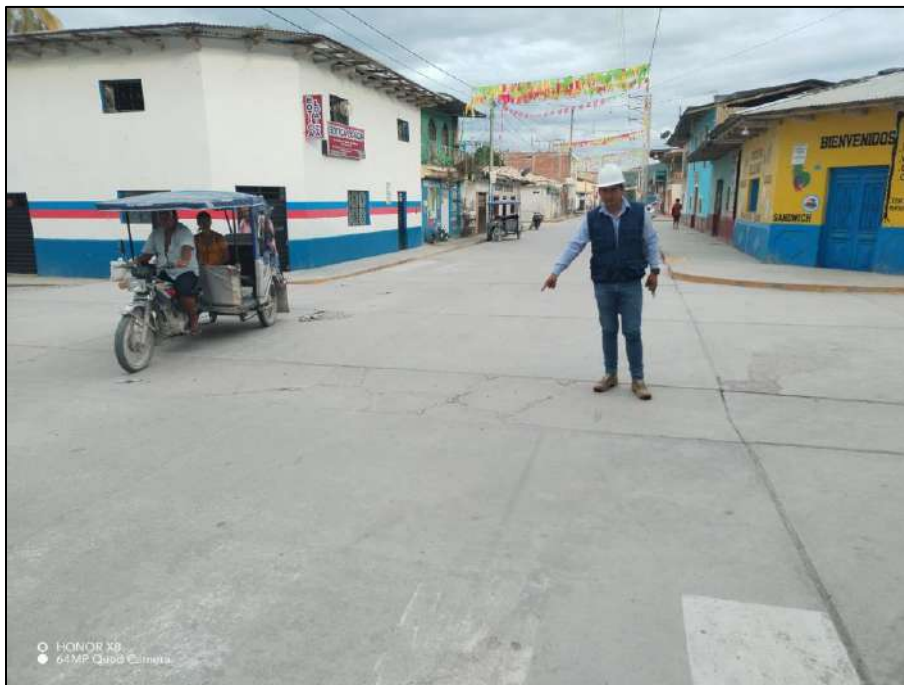
Figura 73: Se observa la identificación de las fallas y la cuantificación de las mismas, específicamente en la UM-09 de la sección 1, ubicada en la cuadra 8 de la vía en estudio.
