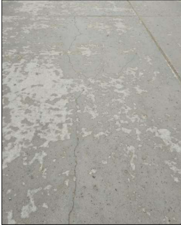
Figura 83: Grieta lineal, observada en la UM-01 de la Sección 02.
