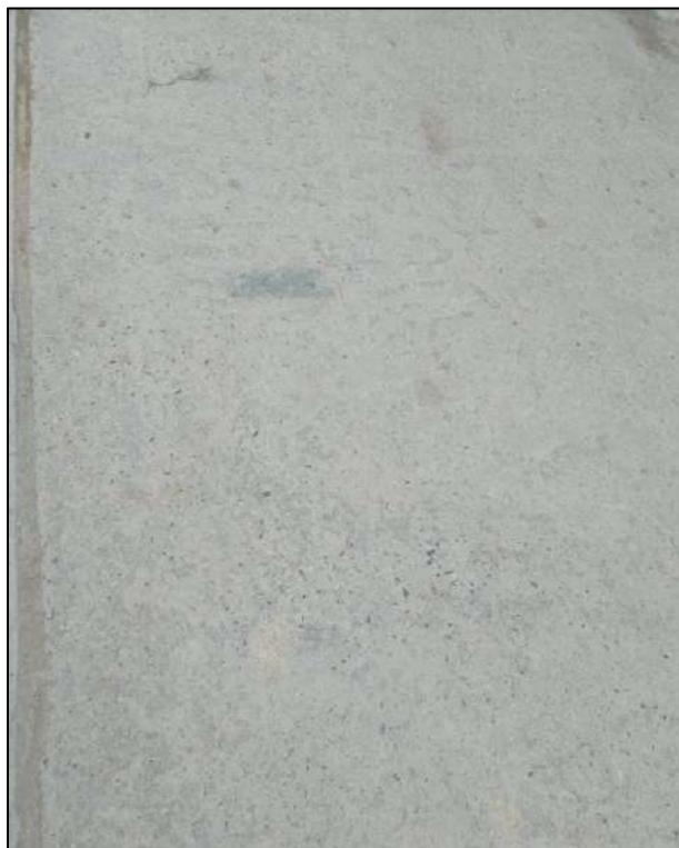
Figura 92: Pulimiento de agregados, observada en la UM-03 de la Sección 02.
