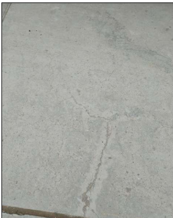
Figura 86: Grieta lineal, observada en la UM-08 de la Sección 02.
