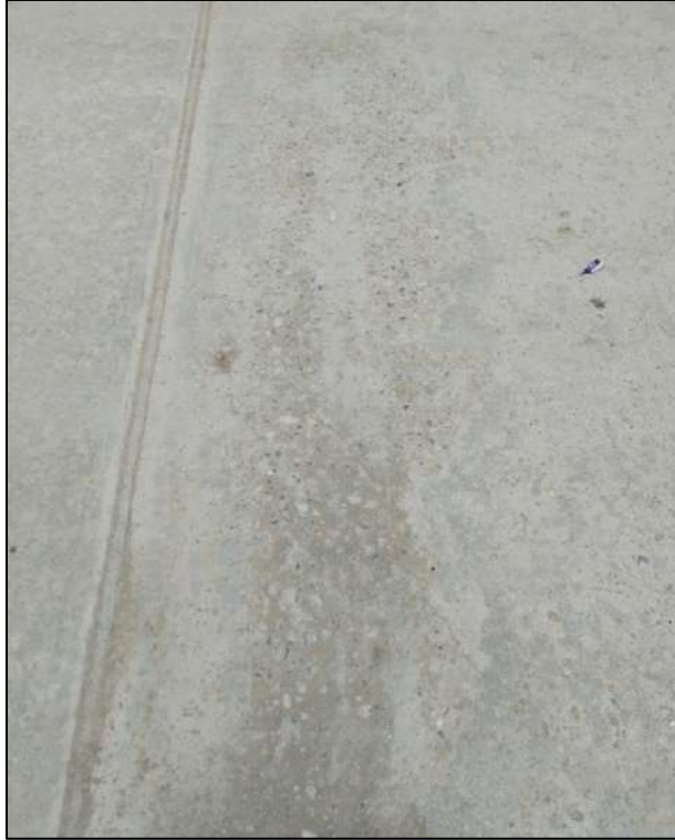
Figura 89: Pulimiento de agregados, observada en la UM-02 de la Sección 01.
