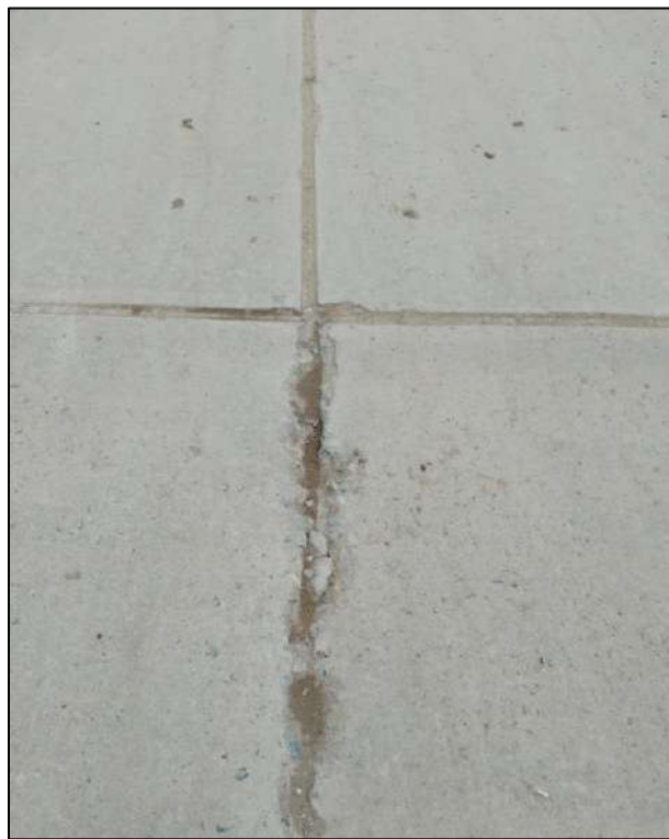
Figura 102: Descascaramiento de junta, observadas en la UM-11 de la Sección 01.
