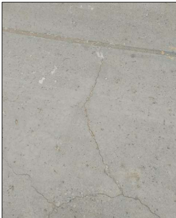
Figura 84: Grieta lineal, observada en la UM-03 de la Sección 02.
