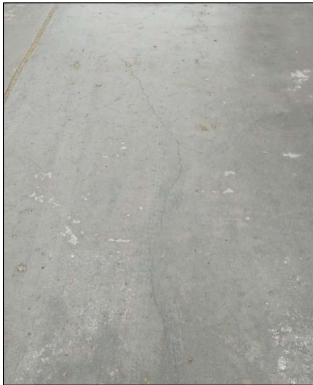
Figura 80: Grieta lineal, observada en la UM-04 de la Sección 01.
