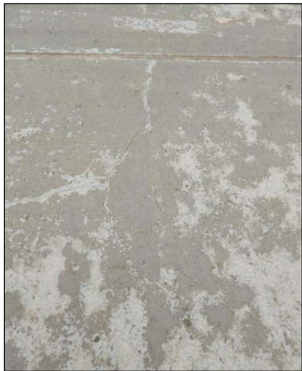
Figura 82: Grieta lineal, observada en la UM-11 de la Sección 01.
