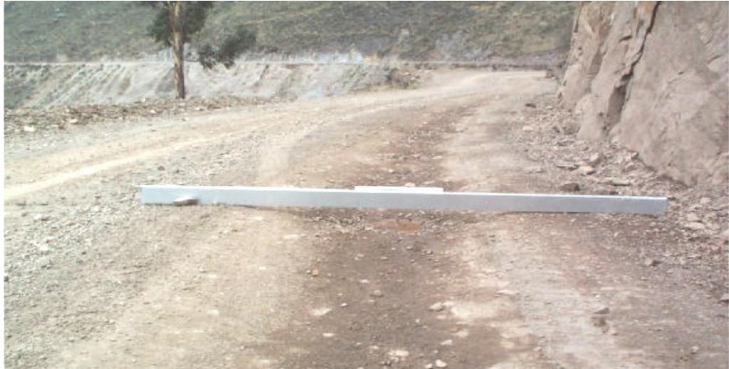
Figura 3.- Gravedad 3: Huellas/hundimientos \geq 10 cm.
