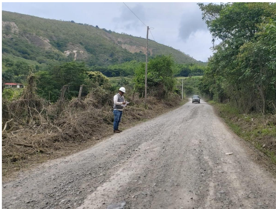
Figura 29.- Evaluación del tramo – tipos de daño
