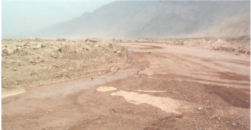
Figura 8.- Gravedad 2: Necesita una capa de material adicional
