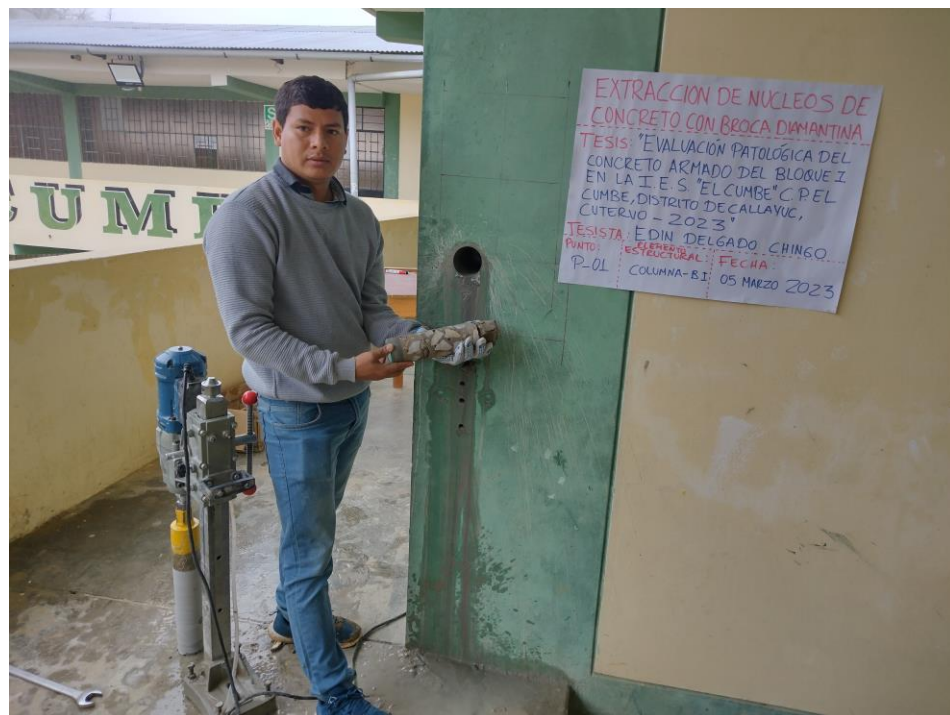
Fotografía 14: Extracción de la muestra de concreto endurecido utilizando broca diamantina de 3” en la columna.
