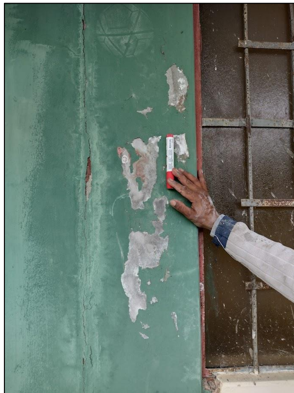
Fotografía 12: Identificación de lesiones en columnas (lesión por humedad y fisuras).
