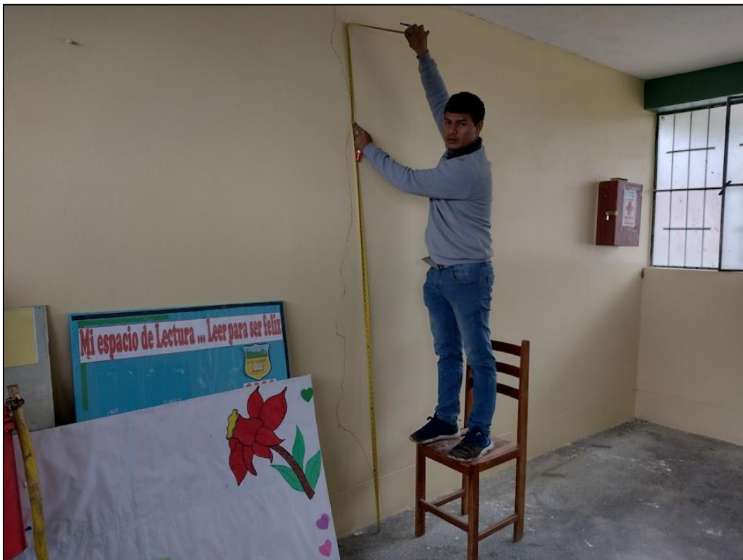
Fotografía 08: Identificación de lesiones en los muros (lesión por grieta).
