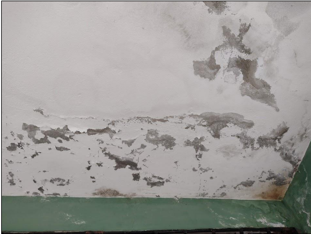
Fotografía 11: Identificación de lesiones en losa aligerada (lesión por humedad).
