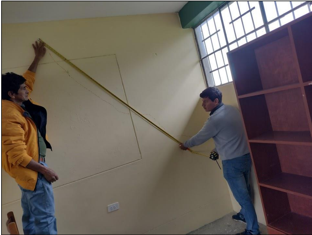
Fotografía 07: Identificación de lesiones en los muros (lesión por grieta).
