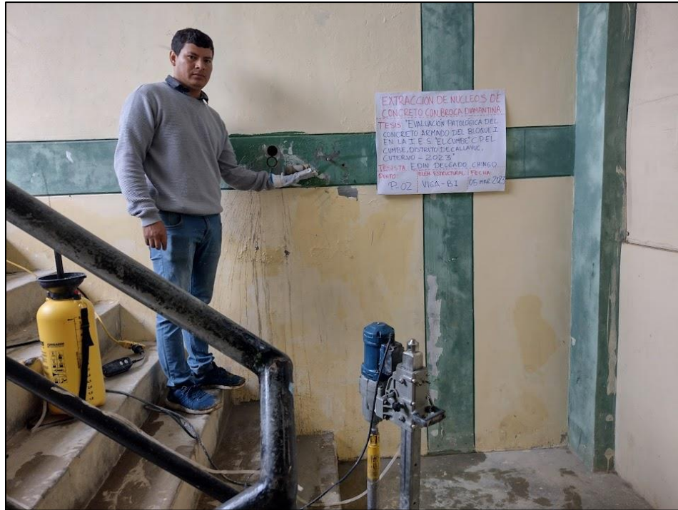
Fotografía 13: Extracción de la muestra de concreto endurecido utilizando broca diamantina de 2” en la viga.
