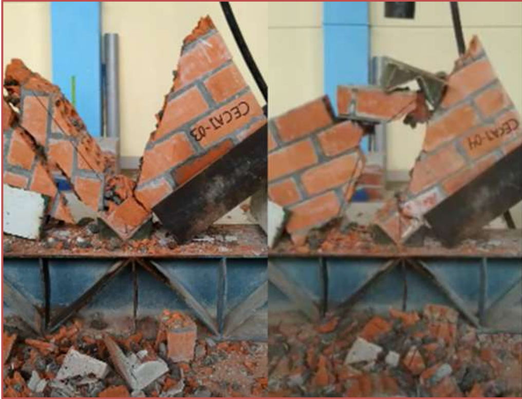
Figura 29. Falla por tensión diagonal en el murete 3 y 4, de cerámicos Cajamarca
