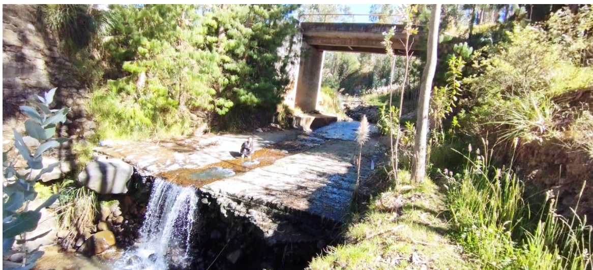
Figura 133. Socavación local en la descarga de la zona protegida de estribos del puente San Plan Manzanos.
