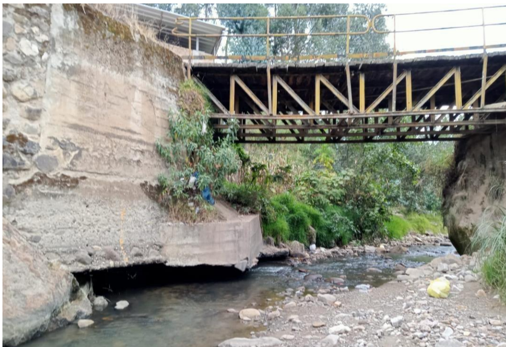
Figura 130. Socavación local actual del estribo izquierdo del Puente San Antonio.
