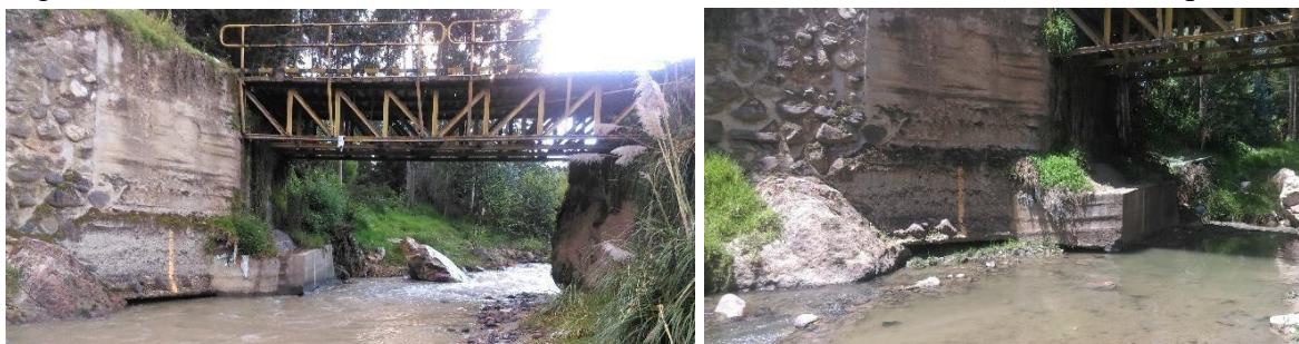
Figura 29. Puente San Antonio (la máxima socavación se visualiza en el estribo izquierdo)
