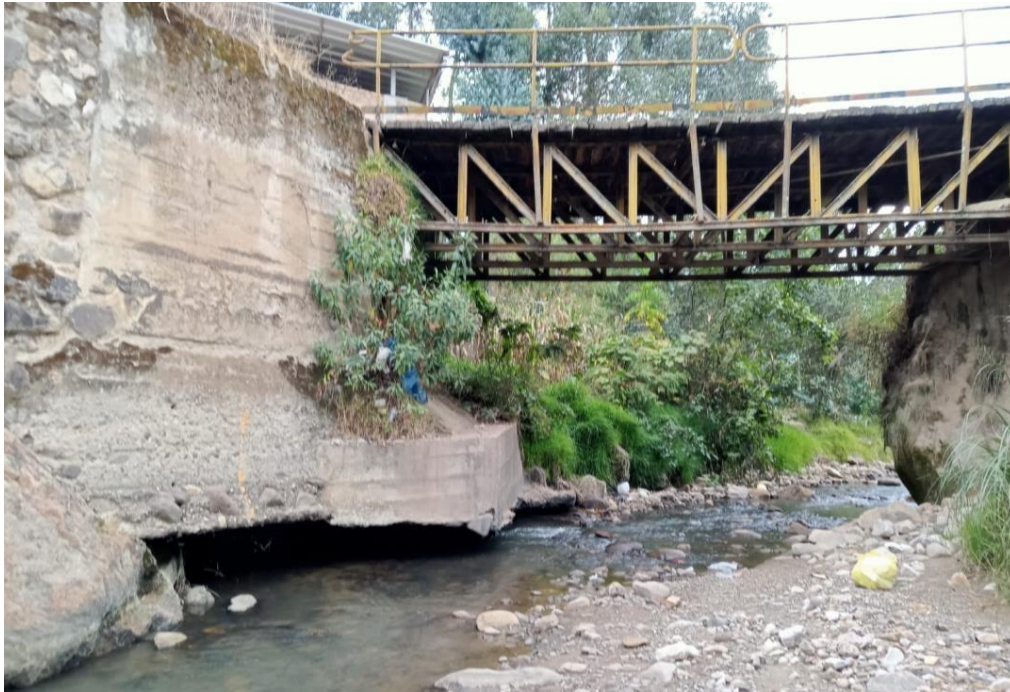
Figura 103. Socavación local en campo – estribo izquierdo del puente San Antonio.
