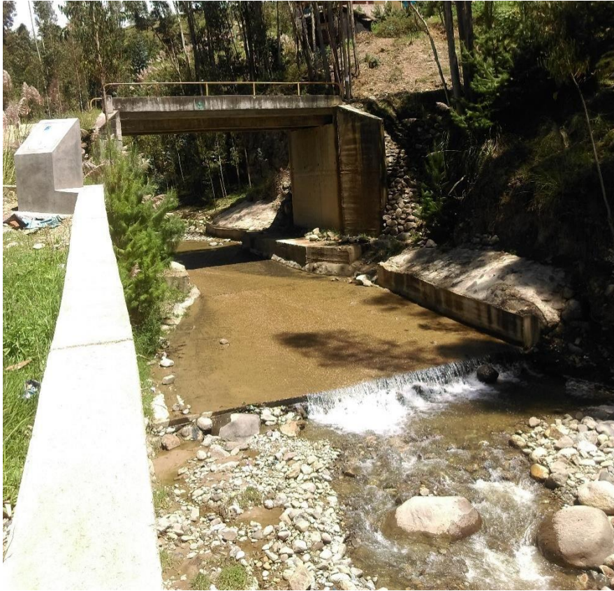
Figura 127. Socavación local en la descarga de la protección de los estribos del puente Plan Manzanas.
