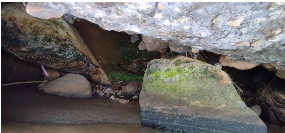
Figura 136. Detalle de la socavación local horizontal dentro de la pantalla del estribo derecho - Puente San Antonio.
