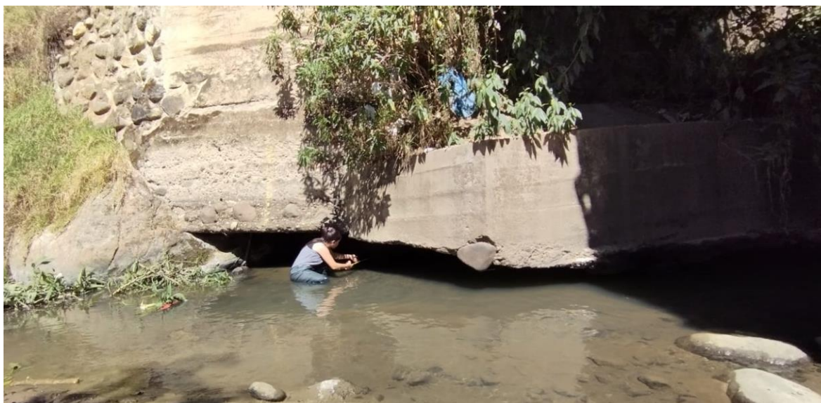
Figura 135. Socavación local actual de puente San Antonio – Pantalla del estribo derecho.
