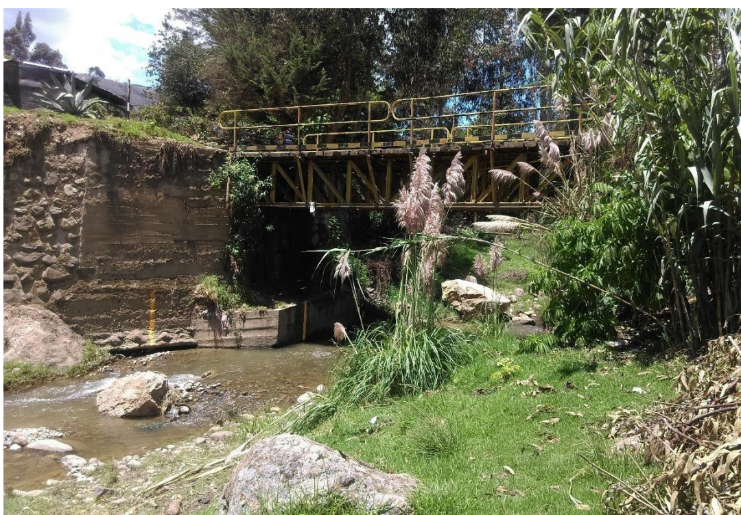
Figura 129. Socavación local moderada en el estribo izquierdo del Puente San Antonio
