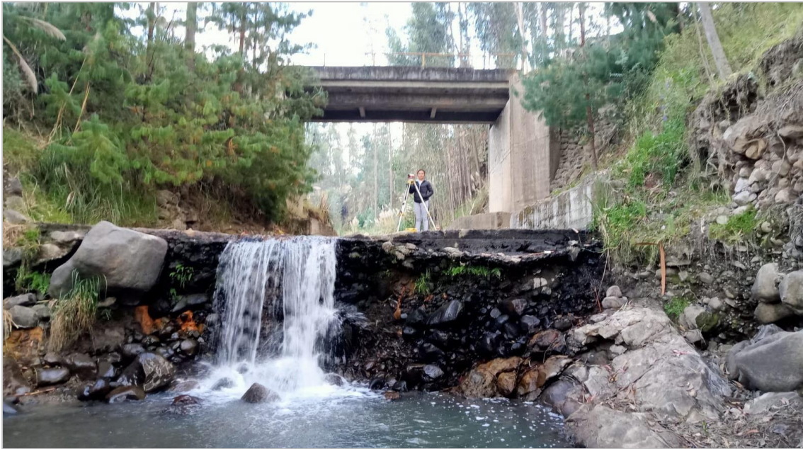
Figura 100. Socavación local en campo – descarga de la zona protegida- Puente Plan Manzanas.
