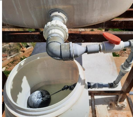
Fotografía N° 14: Recipiente con el flotador, del sistema de cloración.
