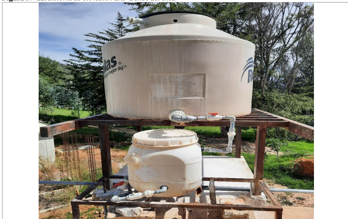
Figura N° 12: Sistema de cloración SAP Baños del Inca
