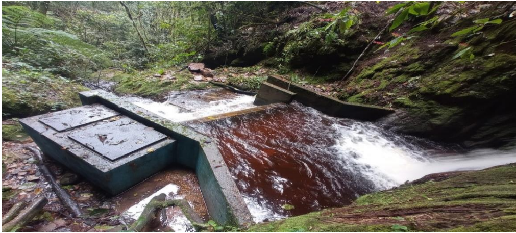
Foto 2: Línea de Conducción
