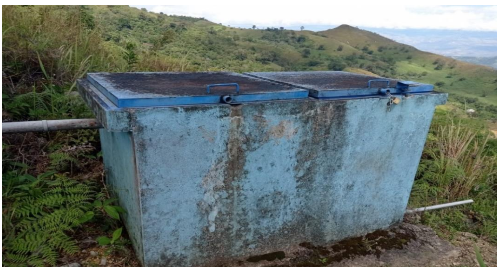
Foto 12: Cámara de Distribución de Caudales
