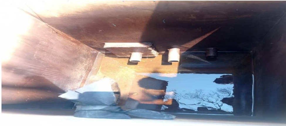
Foto 14: Cámara de Distribución de Caudales: Caseta de Válvulas
