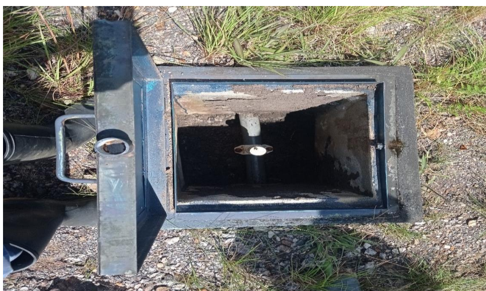
Foto 6: Válvula de Aire
