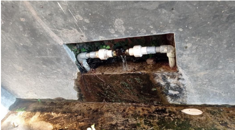
Foto 23: Fugas en válvulas domiciliarias
