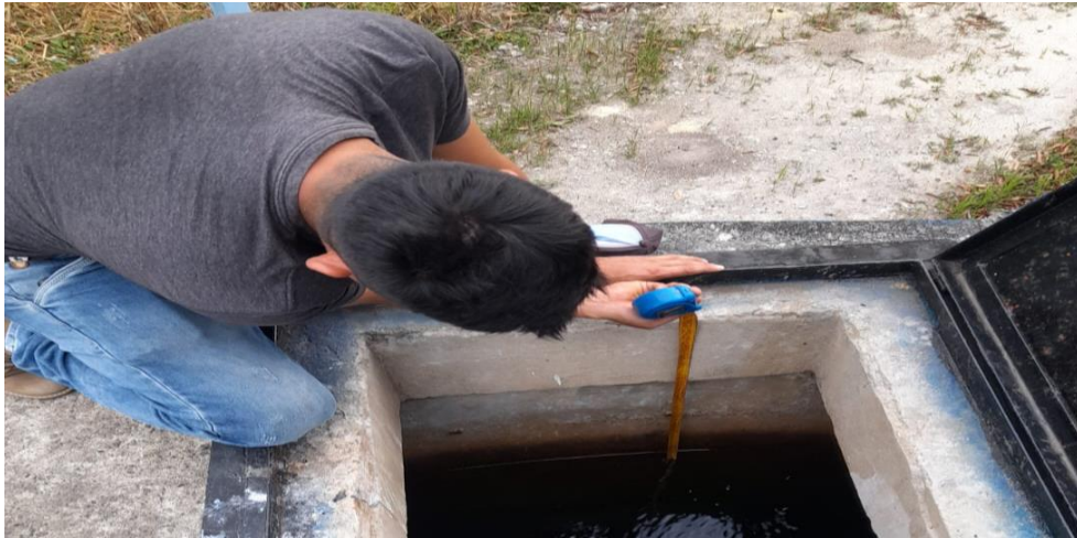
Foto 20: Casetas de cloración inoperativos
