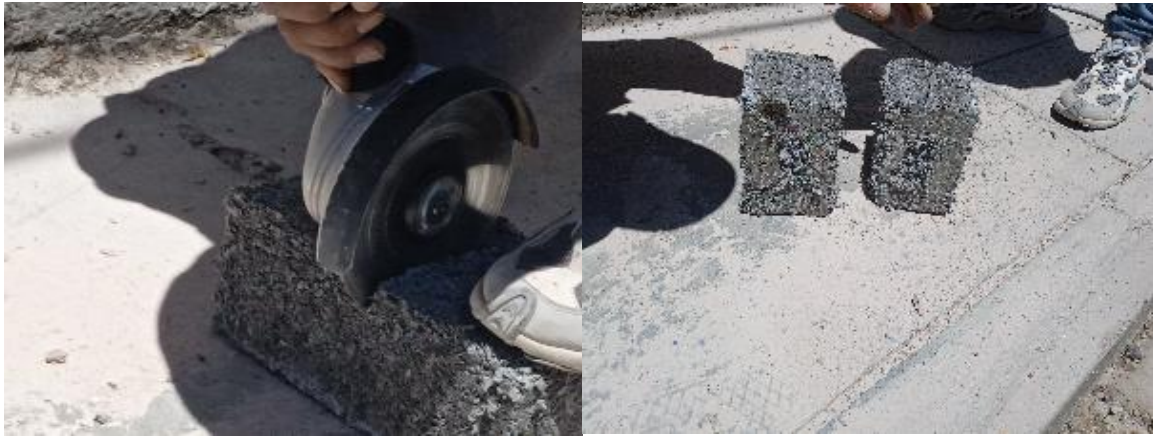
Figura 27: Acerrado del ladrillo de PET y cemento para la construcción de los módulos de 50cmx50cmx50cm.
