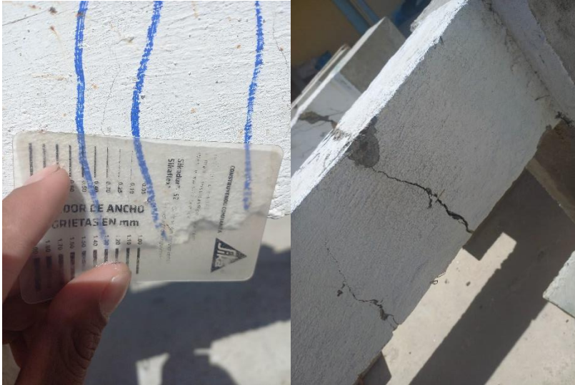
Fotografía N°01. Identificación de fisuras y grietas de pórticos
