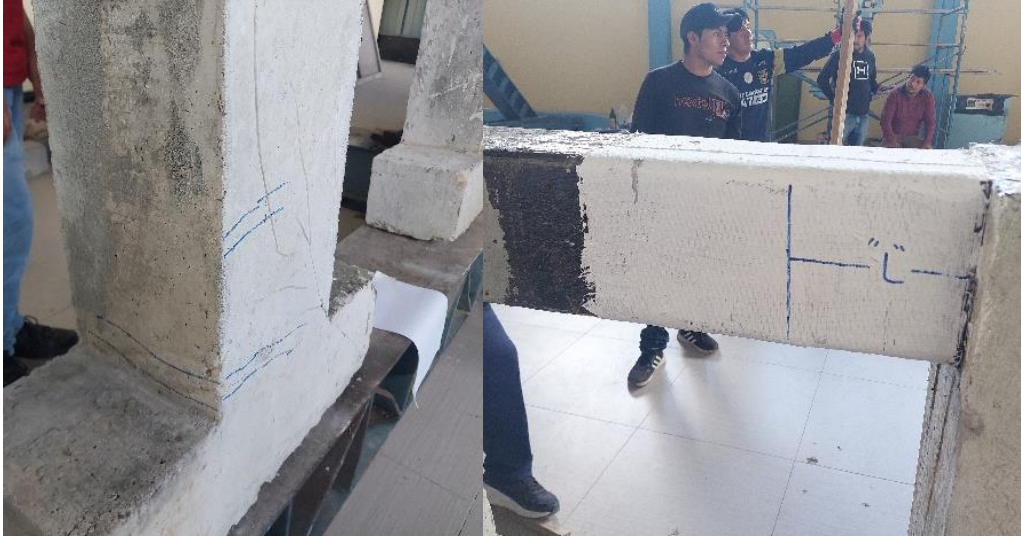
Fotografía N°39. Verificación del comportamiento de la Falla al corte de Viga (Pórtico PF-03)
