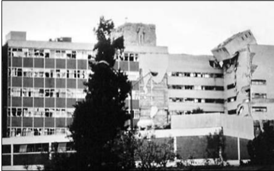
Figura 7. Tanque elevado colapsado a consecuencia de un sismo.
