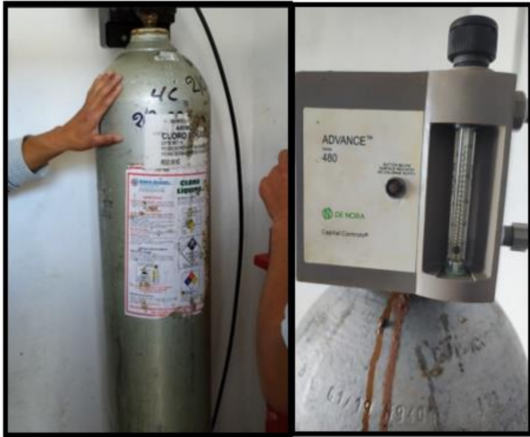
Figura N° 21. Balón de Cloro gas usado en la desinfección del agua luego del proceso de filtración.
