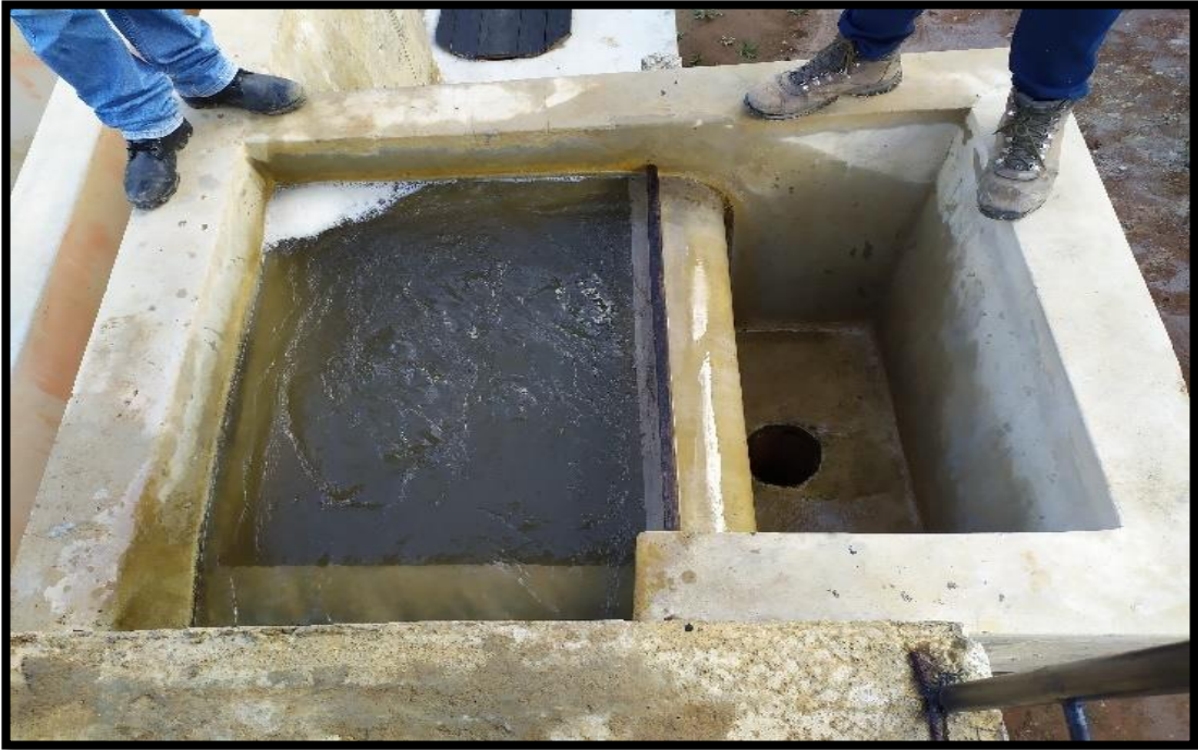
Figura N°19. Estructura de llegada del agua cruda a la PTAP.
