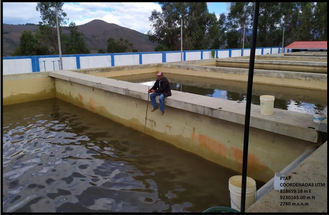
Figura N°20. Filtros lentos de la planta de tratamiento.
