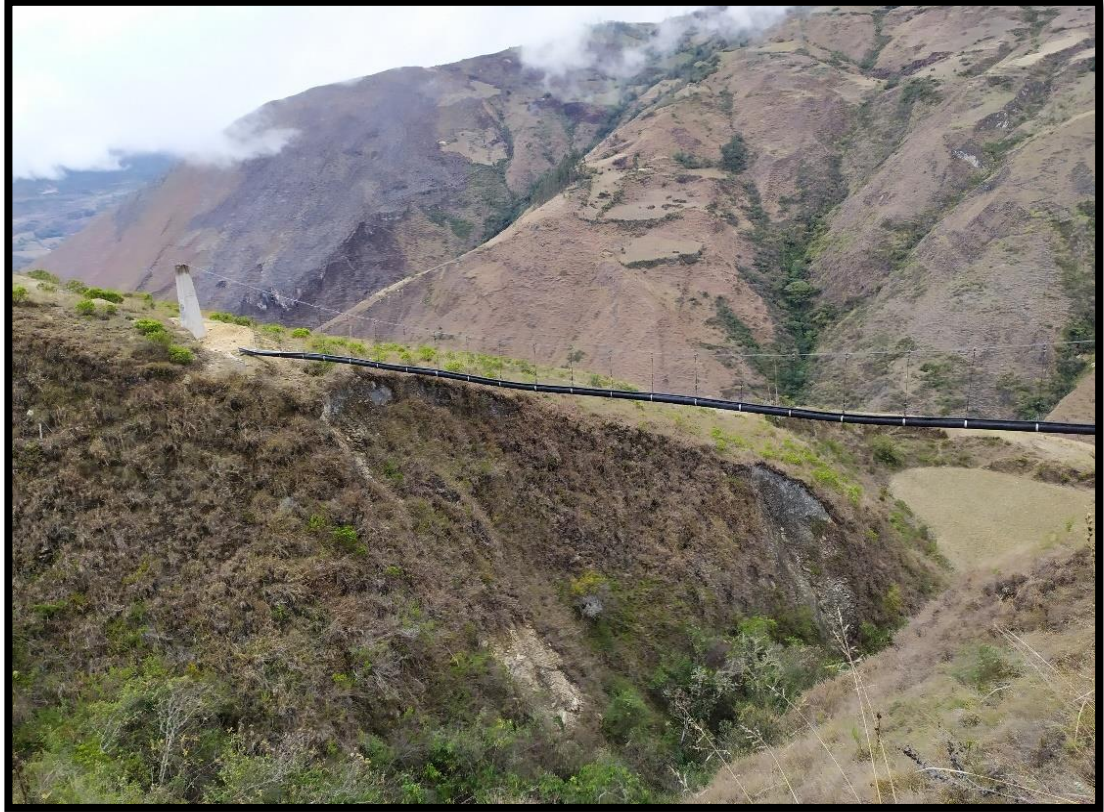
Figura N°18. Pase aéreo de tubería de conducción de agua cruda.
