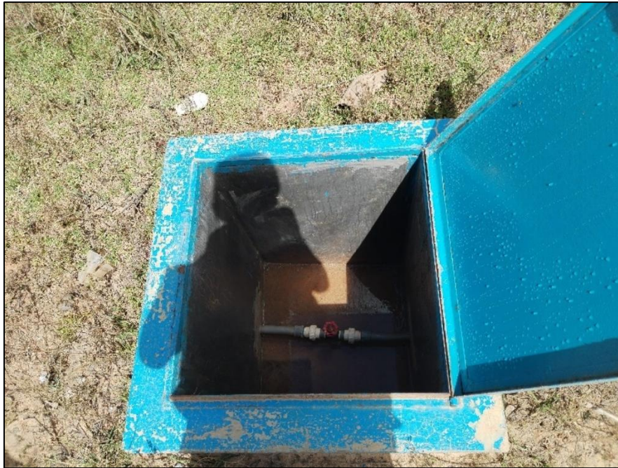
Foto 6 : Válvula de Control con presencia de agua
