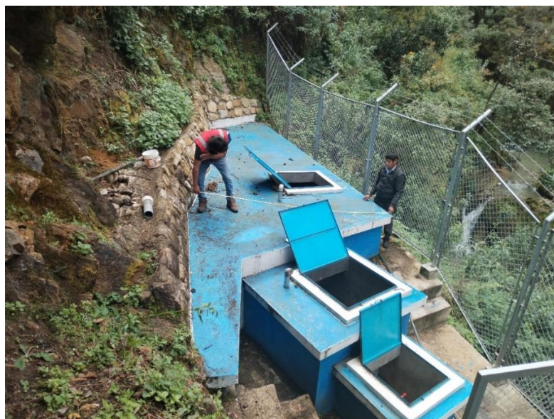
Foto 2: Captación del sistema de abastecimiento de agua potable en la localidad de San Juan
