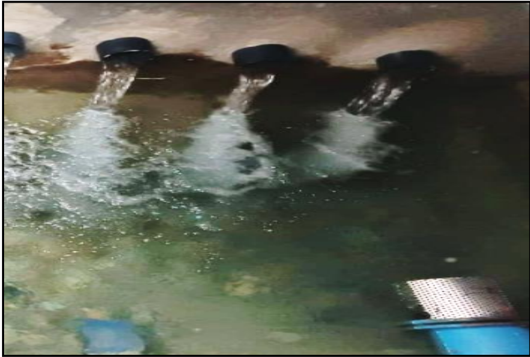
Figura 28: Captación del sistema
