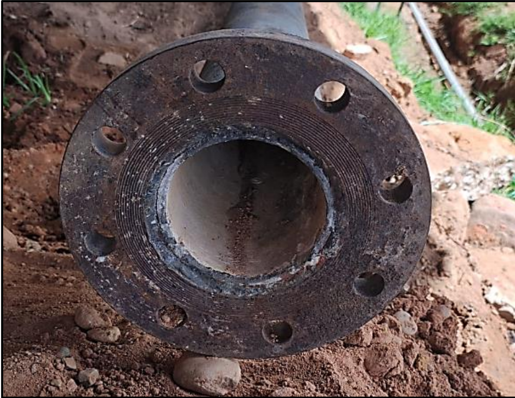
Figura 32: Tubería de impulsión en mal estado
