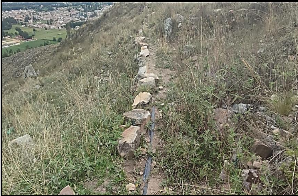
Figura 51: Tubería de aducción
