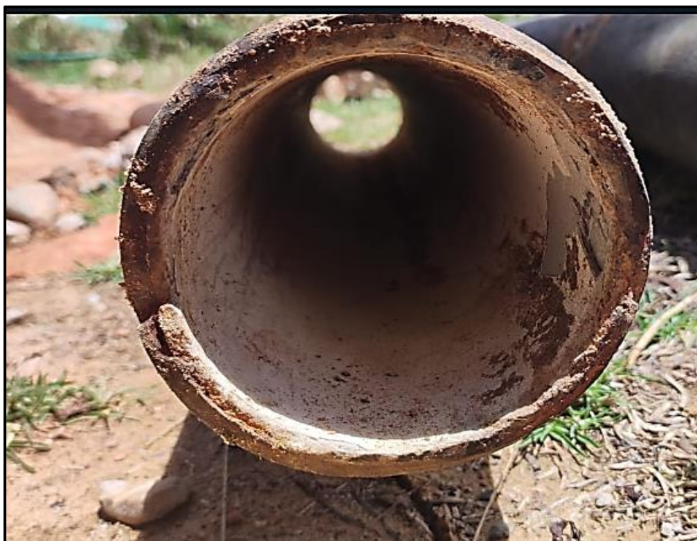
Figura 31: Tubería de impulsión
