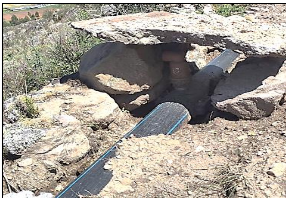
Figura 34: Tubería de aducción
