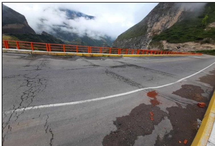
Figura N° 19: Vista de las fallas en pavimento
