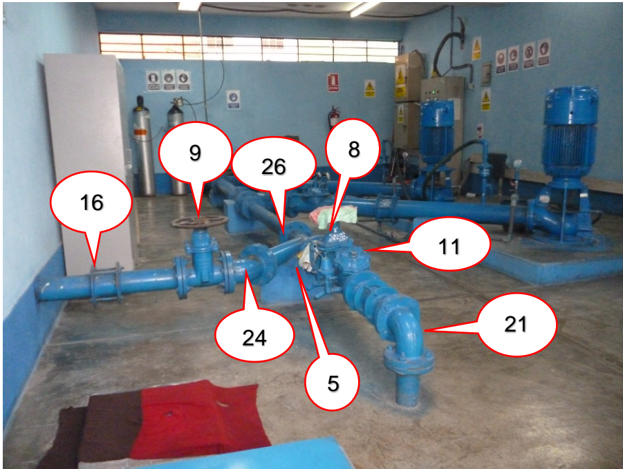
Figura 6 Accesorios del árbol hidráulico de la purga de la Cisterna
