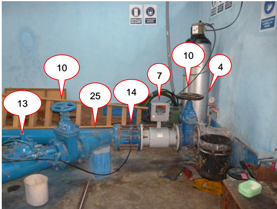
Figura 8 Accesorios del árbol hidráulico de la Cisterna hacia la línea de impulsión
