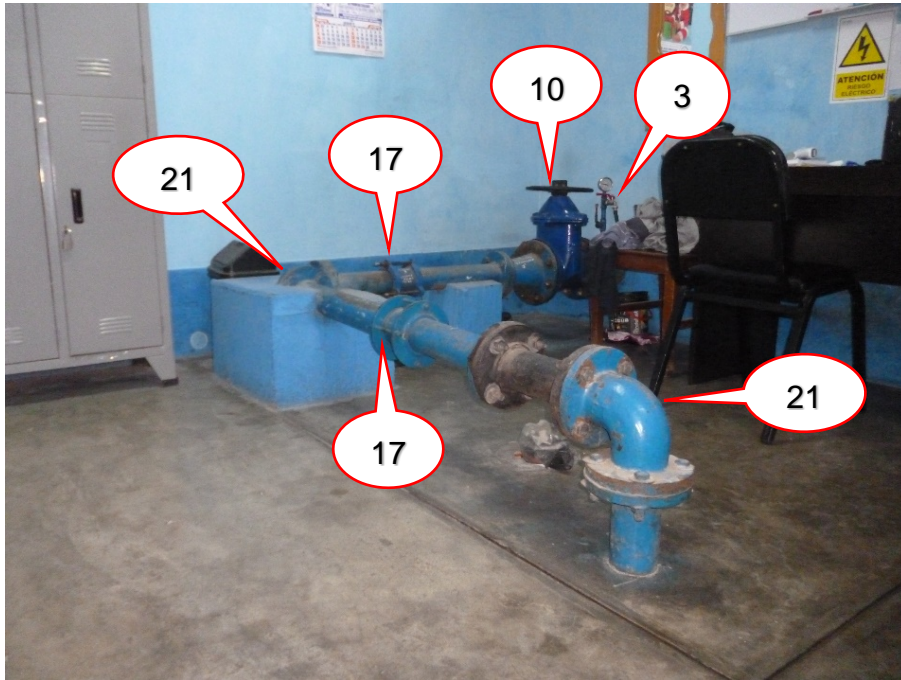
Figura 5 Accesorios del árbol hidráulico de ingreso a la Cisterna
