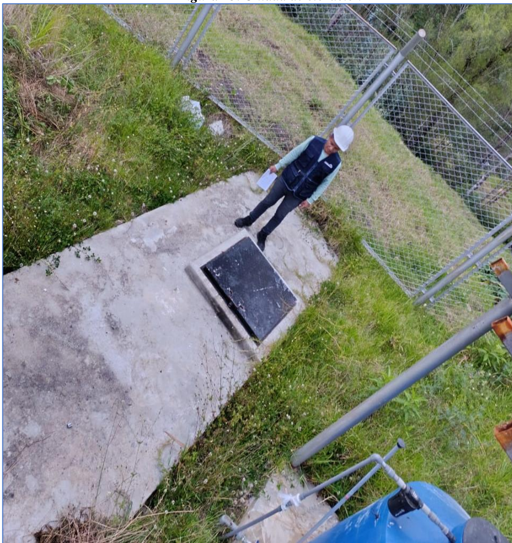
Figura 43. Unidad de cloración
