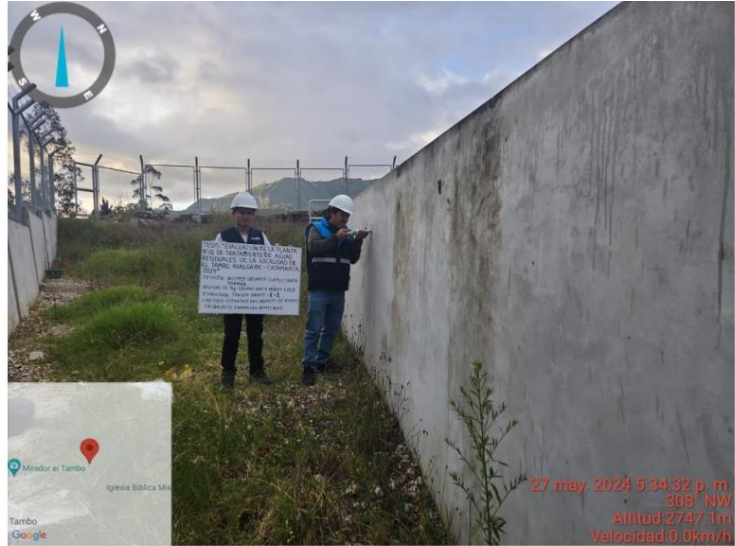
Fotografía N° 1 Ensayo E-1: TANQUE IMHOFF
