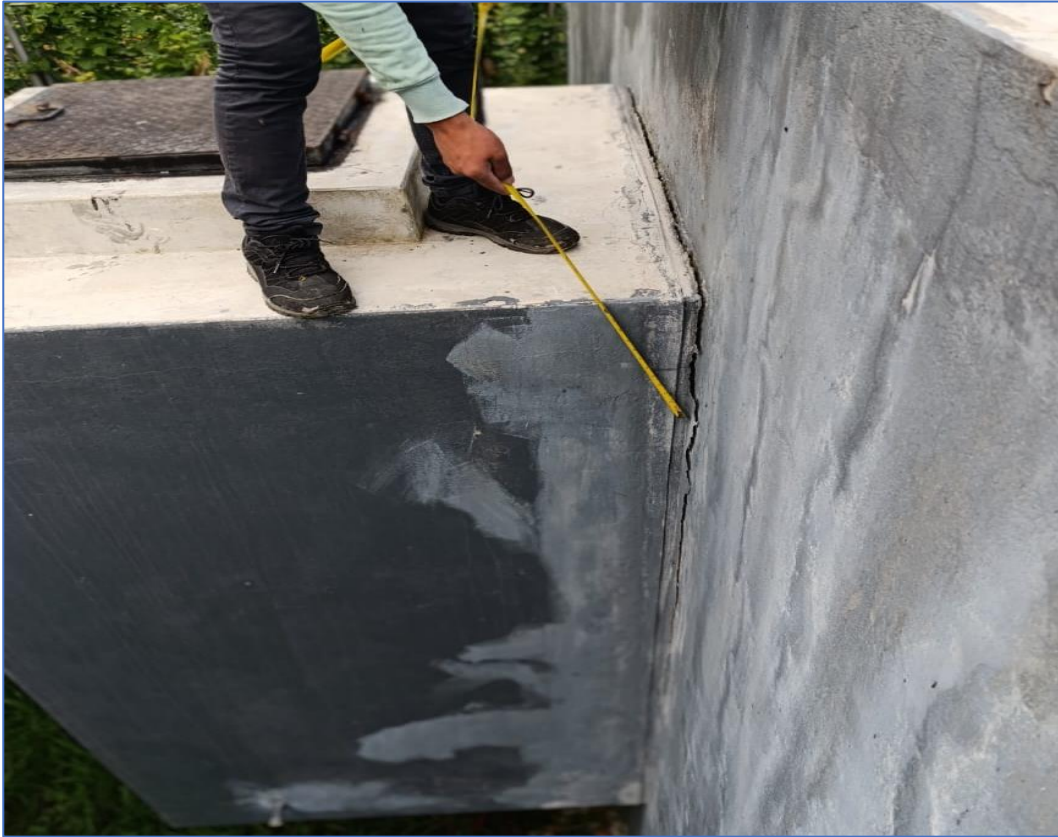
Figura 49. Desprendimiento de la caja de control del muro del tanque Imhoff
