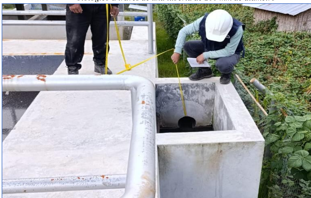
Figura 36. Las aguas residuales salen del tanque Imhoff y llegan al filtro biológico a través de una tubería de 200 mm de diámetro
