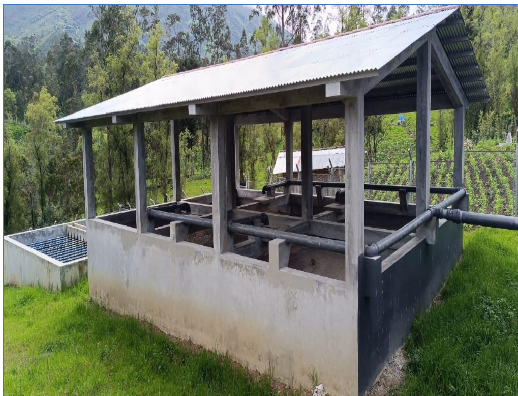
A21. Tratamiento de lodos activados – Lecho de Secado PTAR N°02 Tambo
