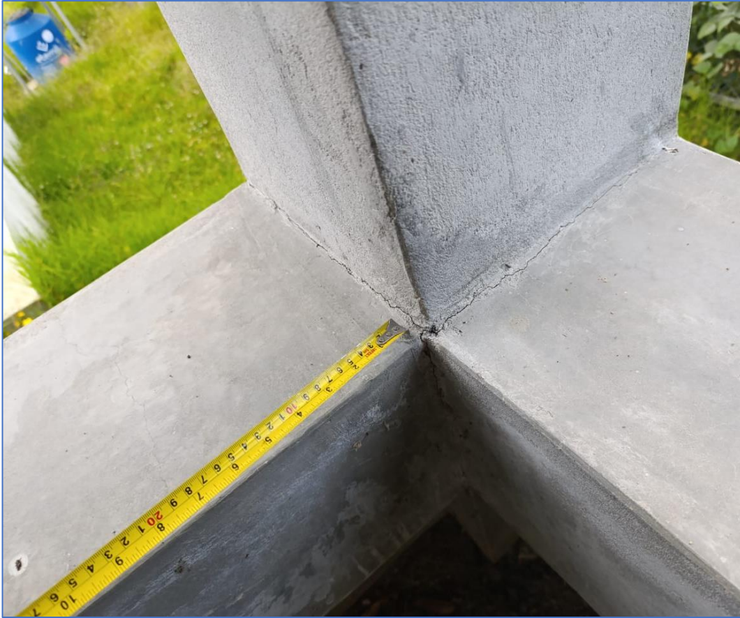
Figura 55. Presencia de grietas en la unión de las vigas y columnas del lecho de secado
