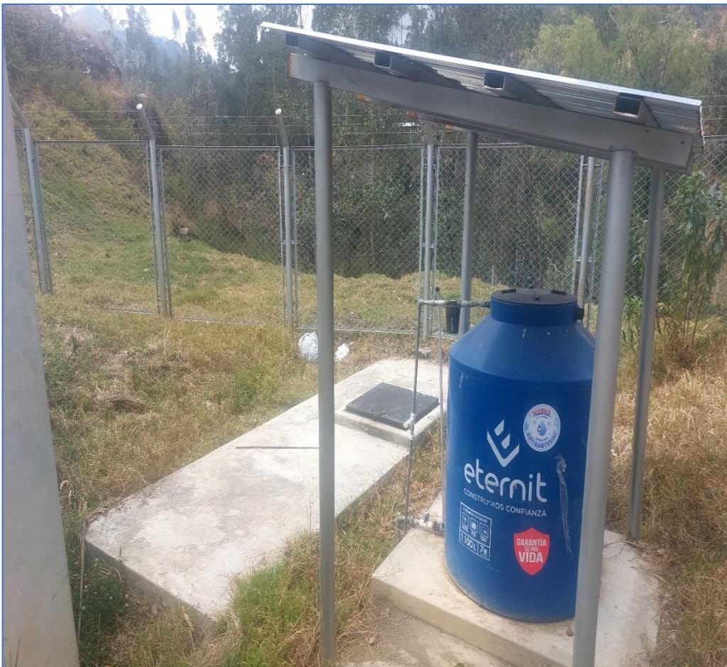
A24. Tanque de almacenamiento de cloro en el PTAR N°02 Tambo
