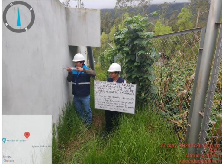
Fotografía N° 3 Ensayo E-2: TANQUE IMHOFF
