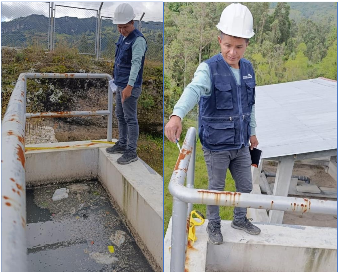
Figura 35. Oxidación de barandas y presencia de residuos inorgánicos en el tanque Imhoff
