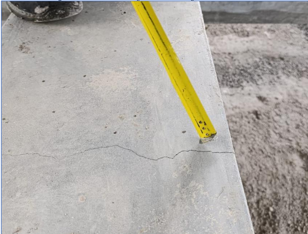
Figura 56. Presencia de grietas en las vigas del lecho de secado
