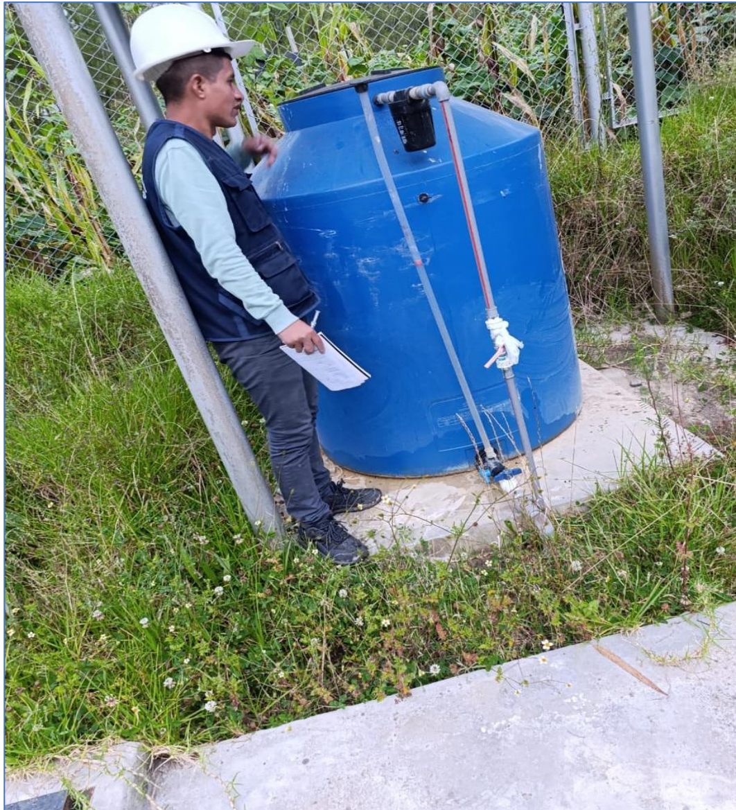
Figura 45. Tanque Eternit de almacenamiento de cloro de 1100 litros
