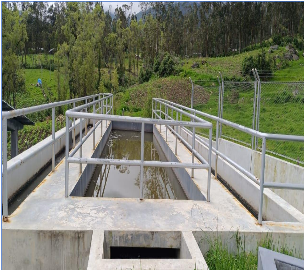
A20. Componente del tratamiento primario – tanque Imhoff PTAR N°02 Tambo
