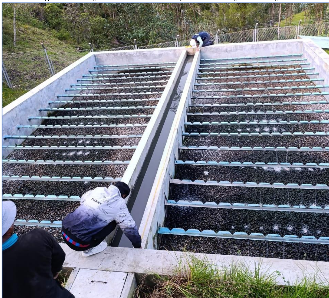
Figura 68. Verificación del canal de repartición en el filtro biológico
