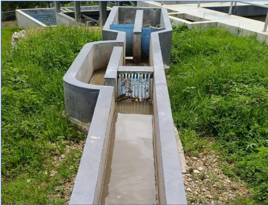
A19. Componentes del pretratamiento – rejas, by pass y desarenador PTAR N°02 Tambo
