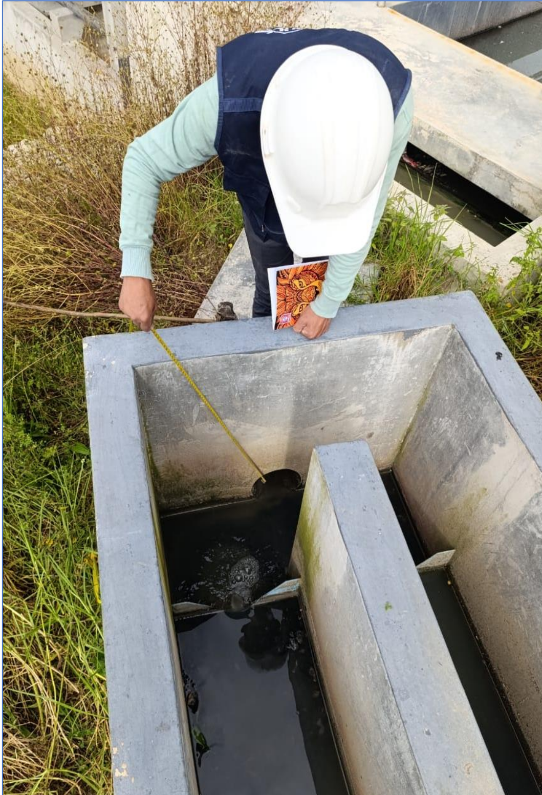
Figura 31. Entrada del caudal al tanque Imhoff
