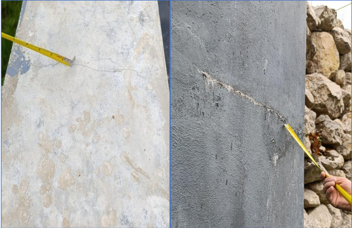
Figura 34. Presencia de grietas en las paredes o muros del tanque Imhoff
