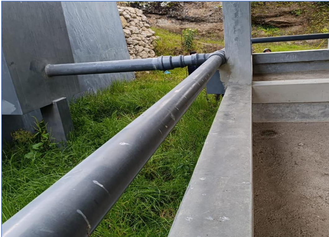
Figura 50. Tuberías que llevan el caudal al lecho secado
