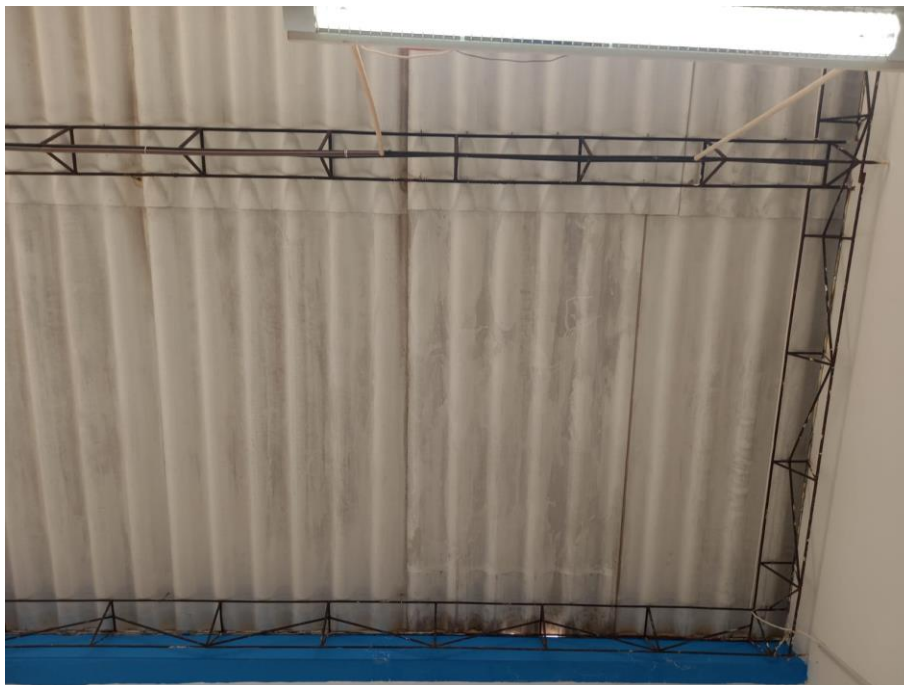
Figura 38. Filtración de agua de lluvia en el techo de fibroceмент de los ambientes del CETPRO Santa Cruz.
