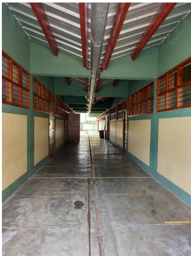
Figura 20. Goteras en el techo por la mala disposición de las calaminas de los ambientes del pabellón 2 de la IE N° 10603.
