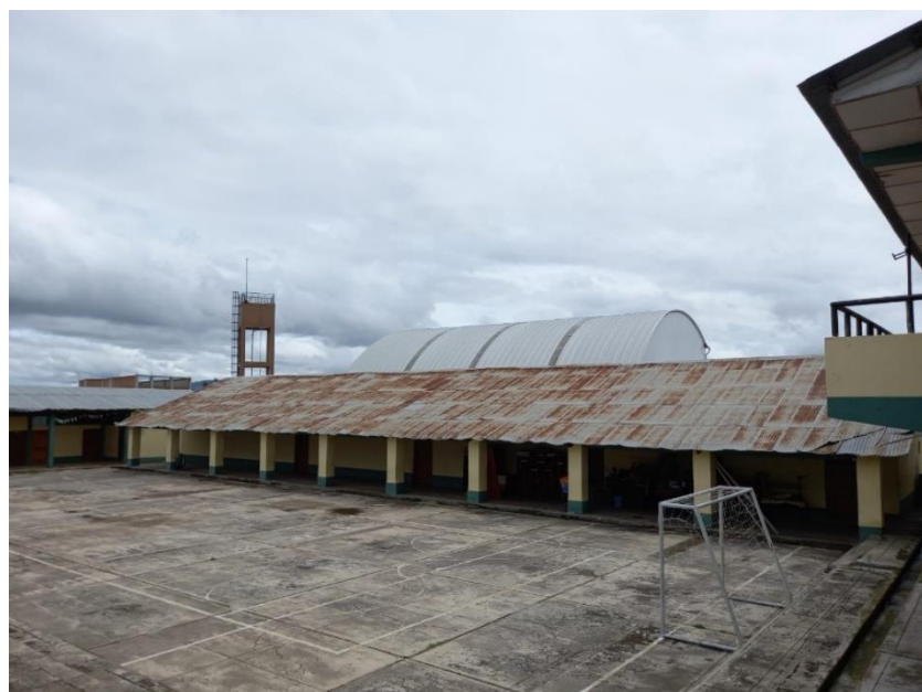
Figura 21. Mal estado de conservación de las calaminas de los ambientes del pabellón 1 de la IE N° 10603.
