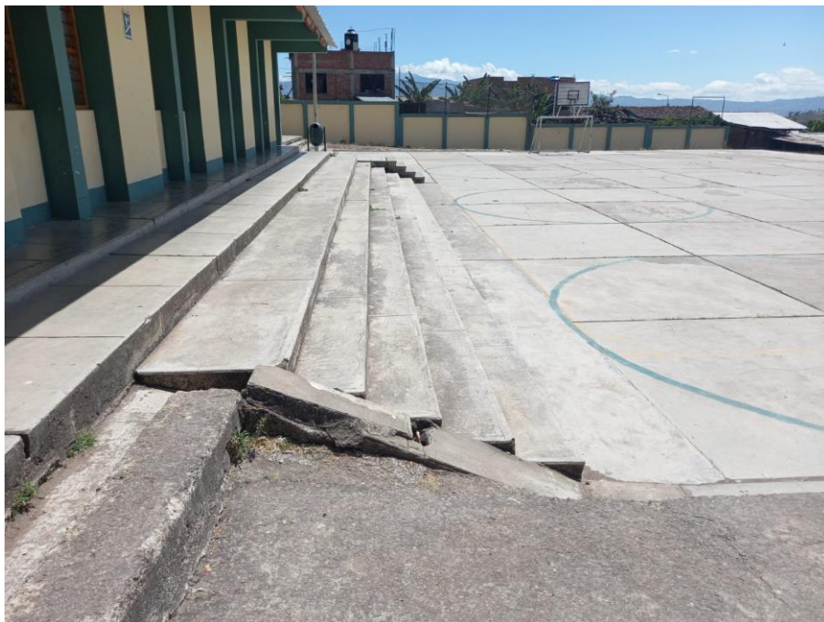
Figura 26. Las escaleras de la IE N° 10603 no tienen pasamanos.
