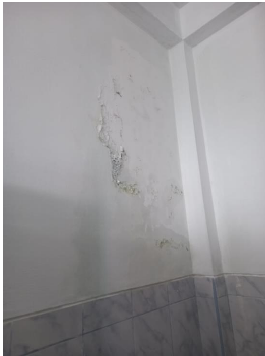
Figura 11. Filtración de agua de lluvia en la pared de concreto de los servicios higiénicos de la IE N° 418.
