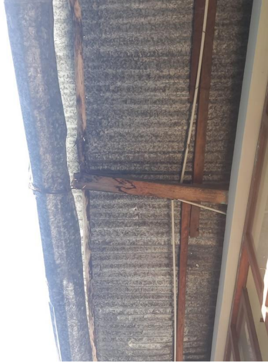
Figura 8. Mal estado de conservación de la calamina y madera del techo del aula amarilla de 5 años de la IE N° 418.
