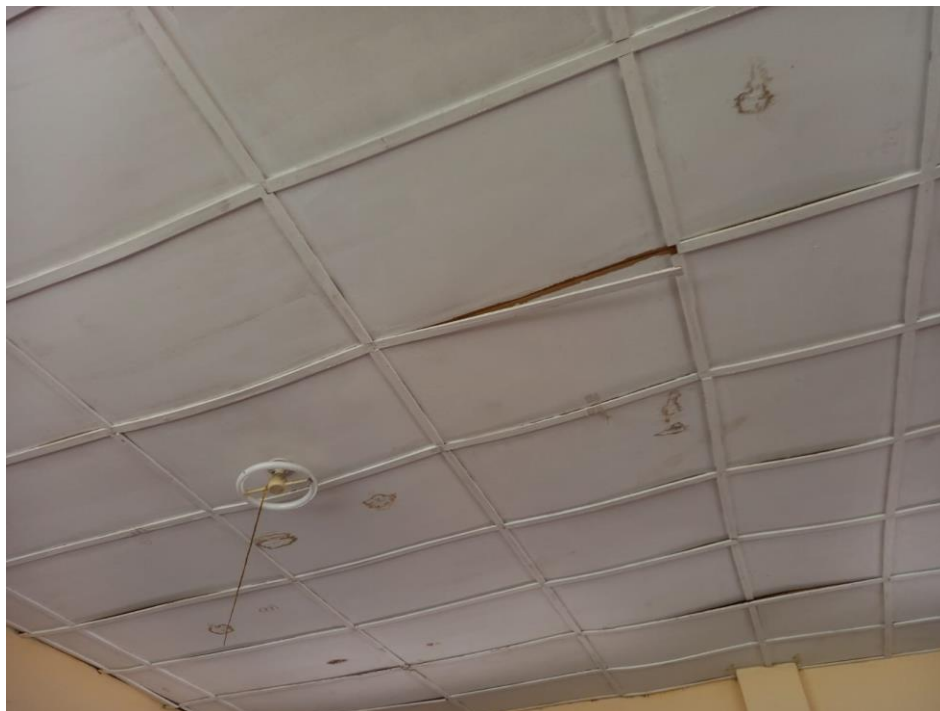
Figura 22. Filtración de agua de lluvia en el falso techo de triplay de los ambientes del pabellón 1 de la IE N° 10603.
