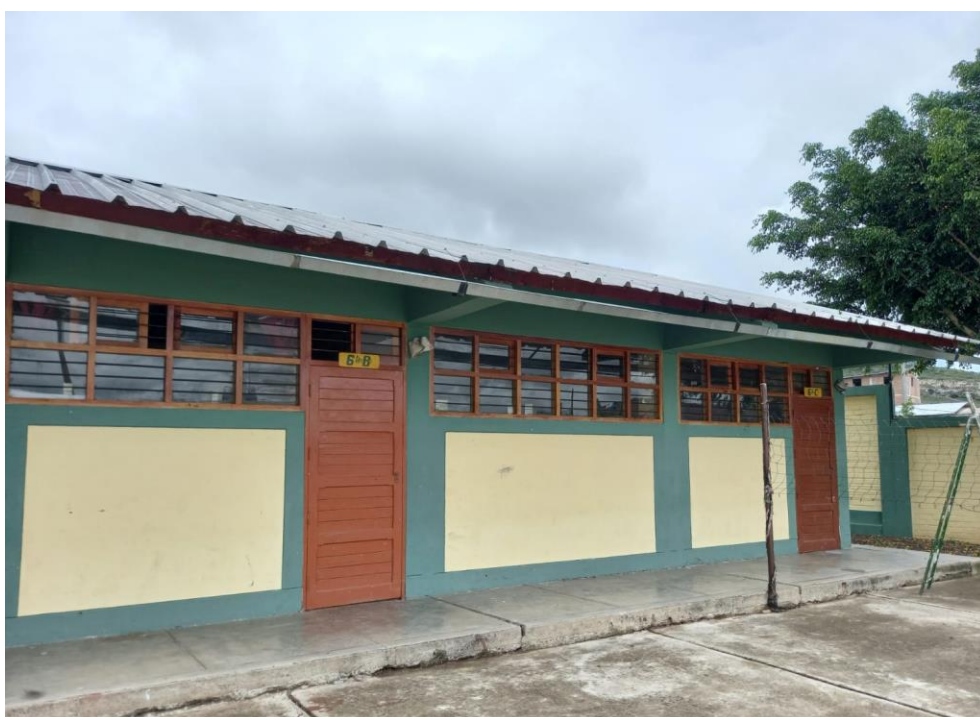
Figura 25. Las puertas de la IE N° 10603 no cuentan con ningún elemento que permita visualizar el interior de los ambientes.
