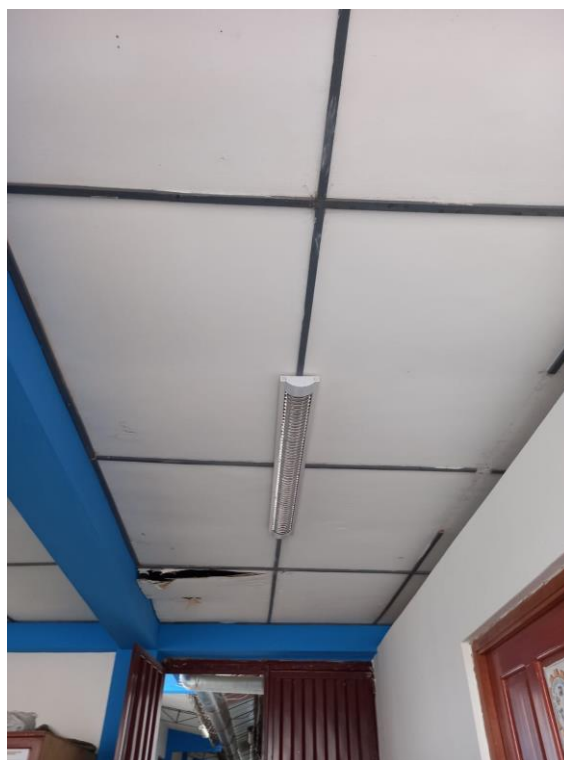
Figura 39. Ruptura del falso techo de la dirección del CETPRO Santa Cruz.
