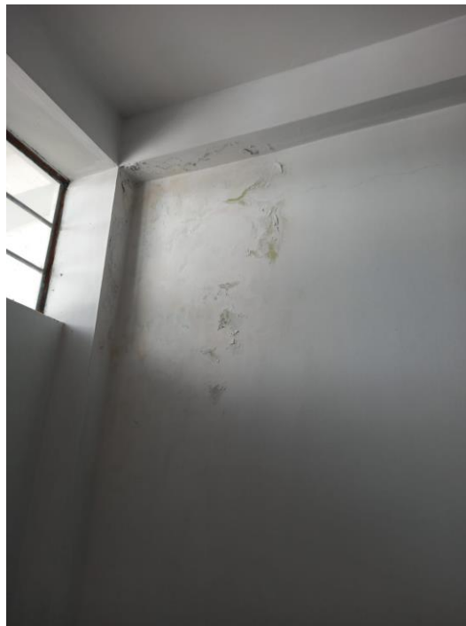
Figura 9. Filtración de agua de lluvia en la pared de concreto de la cocina - comedor de la IE N° 418.
