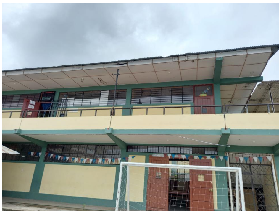
Figura 23. Filtración de agua de lluvia en el falso techo de triplay de los aleros de los ambientes del pabellón 1 de la IE N° 10603.
