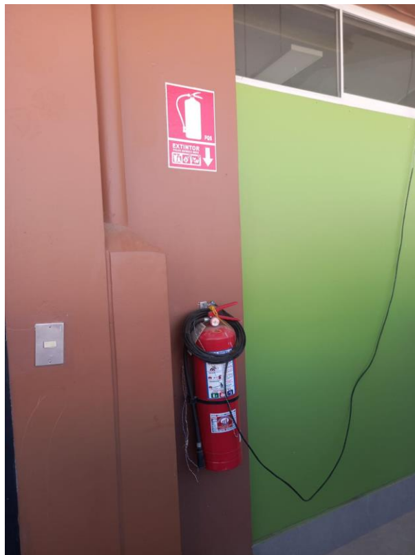
Figura 35. La IE Juan Ugaz está implementada con dispositivos de seguridad.
