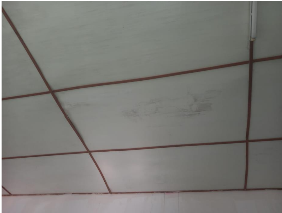
Figura 7. Filtración del agua de lluvia en el falso techo de triplay del aula amarilla de 5 años de la IE N° 418.
