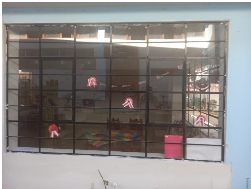
Figura 14. El vidrio de las ventanas de los ambientes de la IE N° 418 no son templados, laminados ni cuentan con lámina de seguridad.
