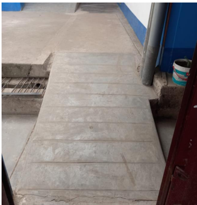
Figura 41. Las rampas del CETPRO Santa Cruz no cuentan con pasamanos y no cumplen con la pendiente máxima permitida de 12%.
