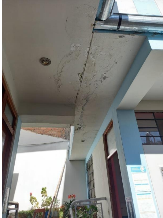
Figura 10. Filtración de agua de lluvia en el alero de concreto de la cocina - comedor de la IE N° 418.
