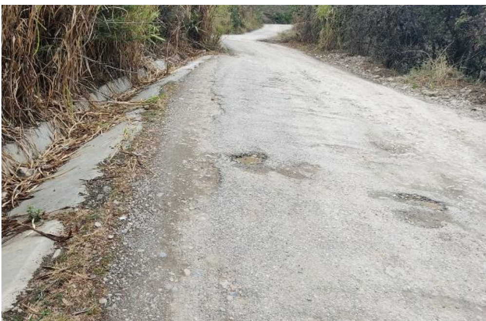
Fotografía N° 08: Presencia de hoyos en la calzada.
