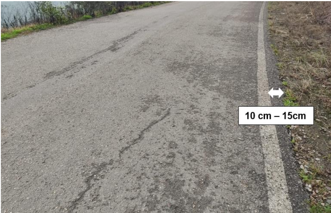
Fotografía N° 06: Berma con ancho menor al mínimo.
