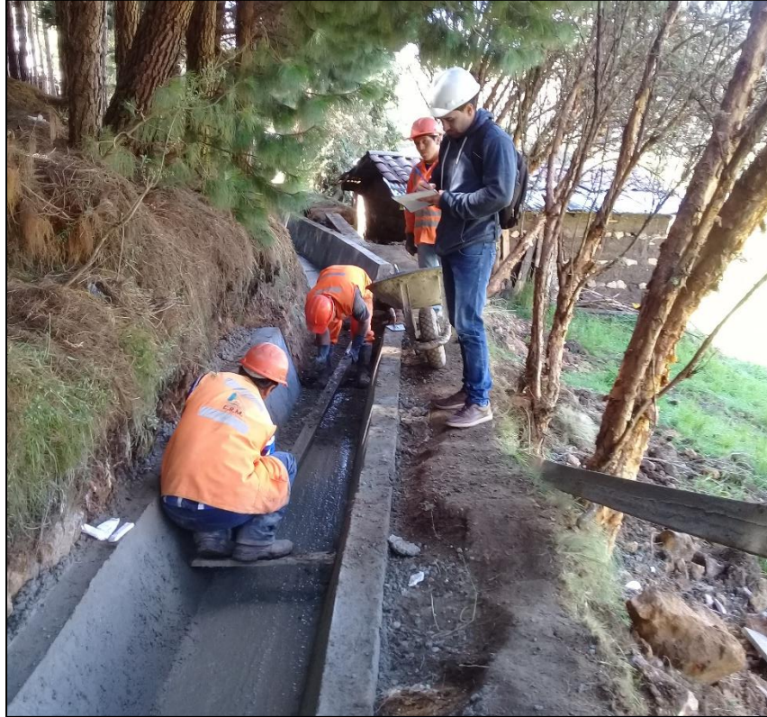
Fotografía N°19: Toma de datos con el formato de Cartas Balance en la partida de Acabado piso frotachado y curado de concreto.
