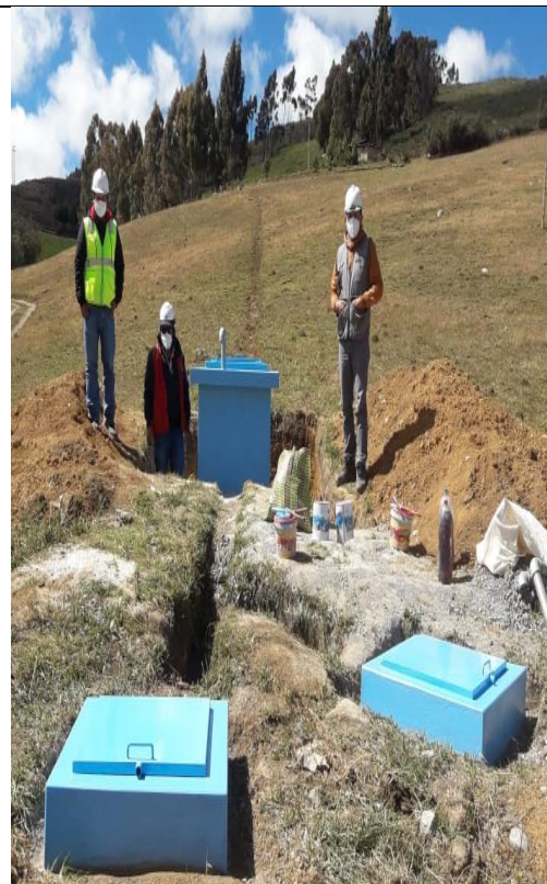
CAMARA ROMPE PRESIÓN T7 Y VALVULAS CONTROL
