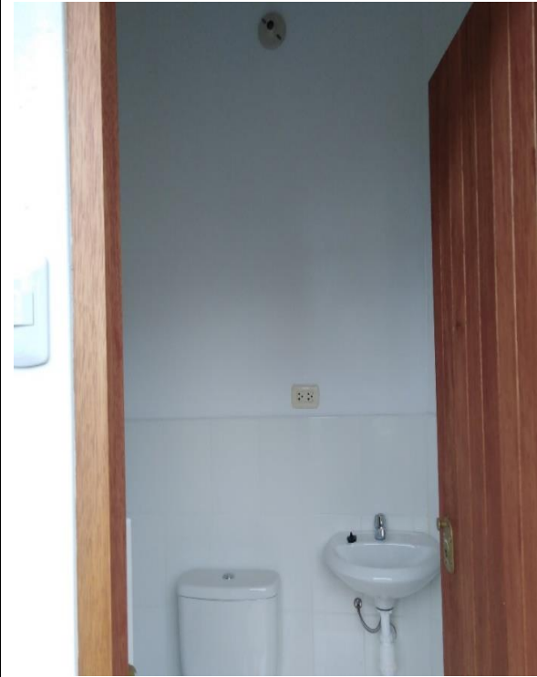
APARATOS SANITARIOS UBS
