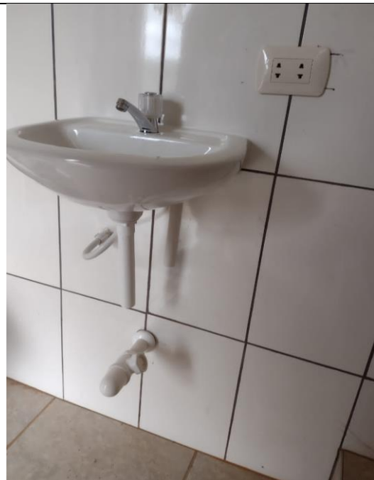
INSTALACION SANITARIA Y ELÉCTICA
