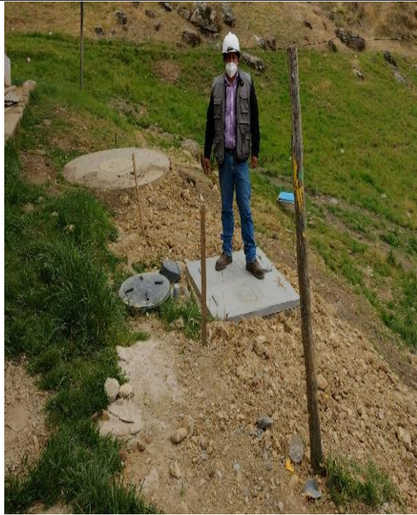
BIODIGESTOR CON CAJA DE LODOS Y POZO PERCOLADOR
