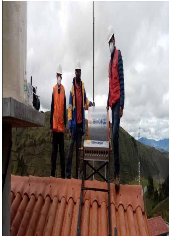
INSTALACIÓN THERMA SOLAR
