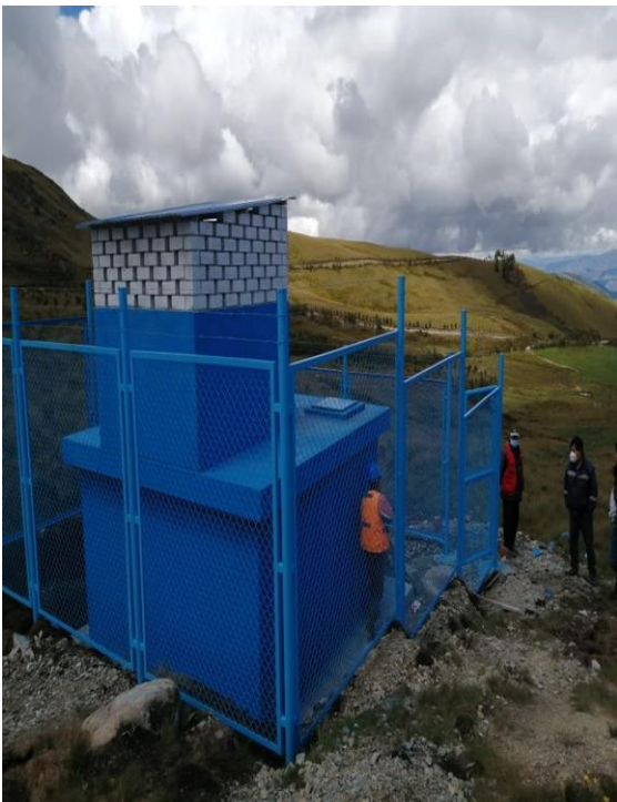
RESERVORIO Y CASETA CLORACIÓN
