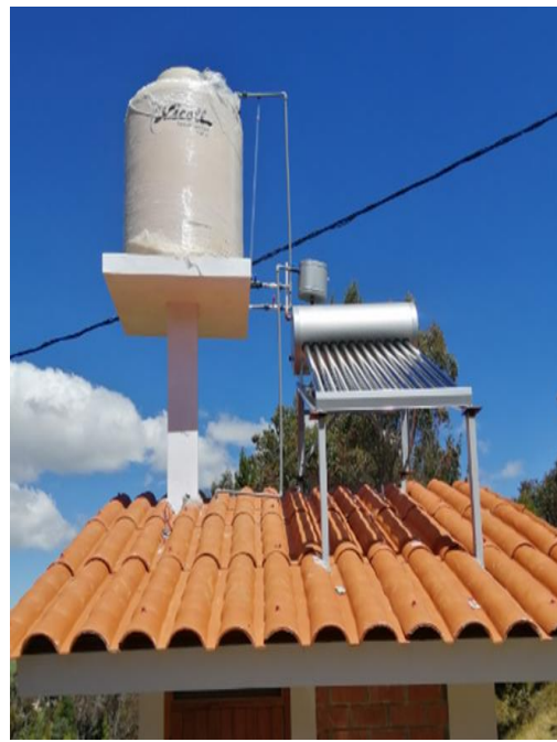
TANQUE ELEVADO Y THERMA SOLAR
