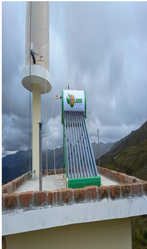
THERMA SOLAR Y TANQUE ELEVADO
