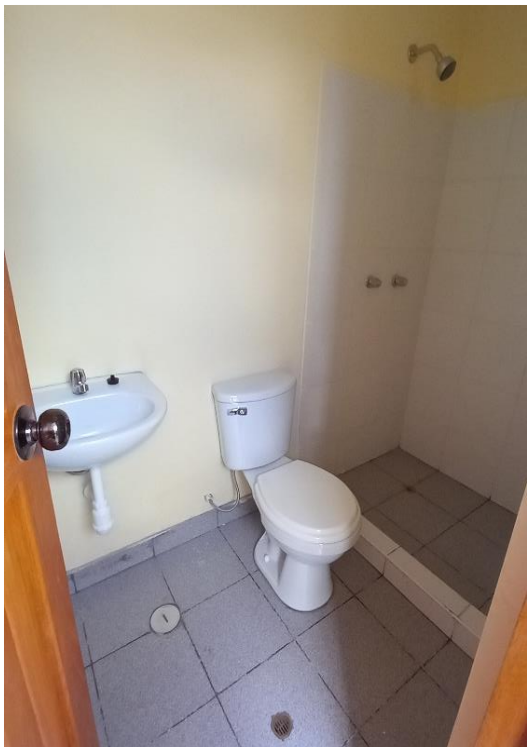
APARATOS SANITARIOS UBS
