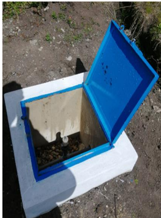
CAJA VÁLVULA DE AIRE
