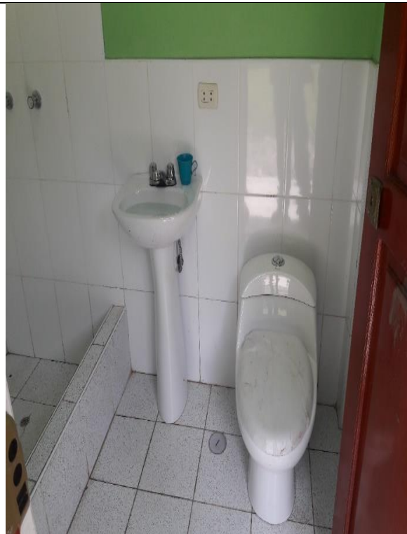
APARATOS SANITARIOS UBS
