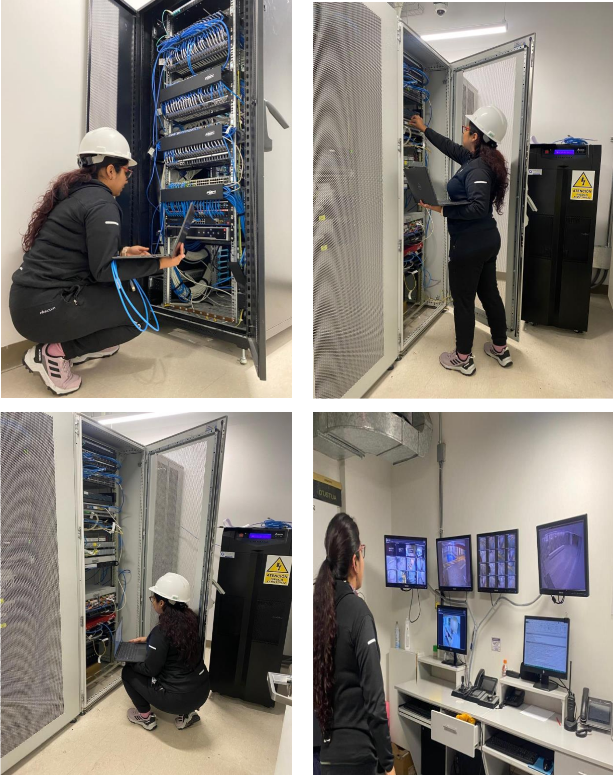
Fig. 72: Monitoreo de los equipos de comunicación
