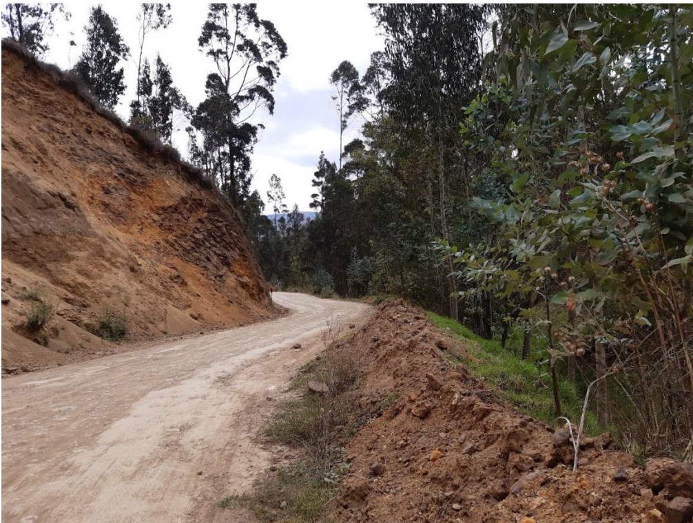
Fotografía 6. Vista de curva sin señalización km 1+500.
