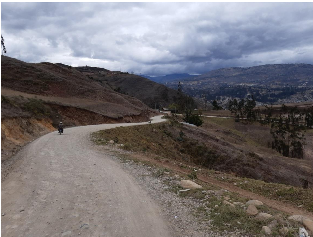
Fotografía 10. Vista del estado de la calzada y bermas.
