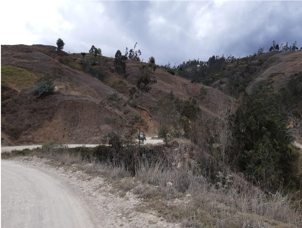
Fotografía 7. Vista panorámica del estado de la vía km 2+300.
