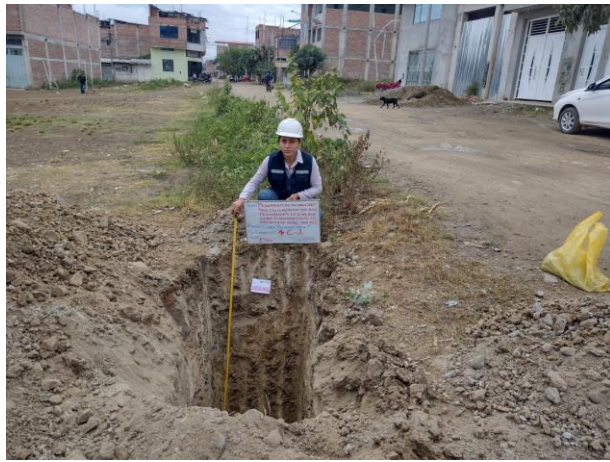
Fotografía 01: Ejecución de la calicata 01, al lado izquierdo de la Av. Inmaculada, a 1.50m de profundidad.
