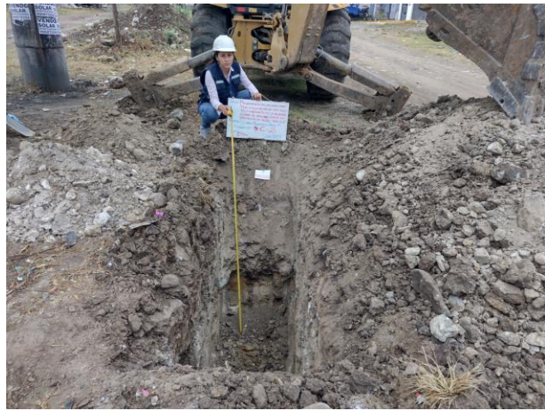
Fotografía 02: Ejecución de la calicata 02, al lado derecho de la Av. Inmaculada, a 1.50m de profundidad.
