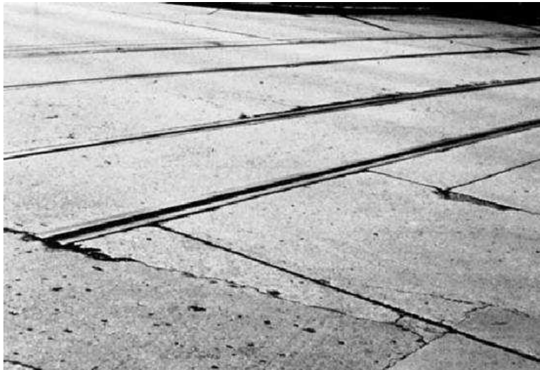
Cruce de vía férrea de baja severidad
