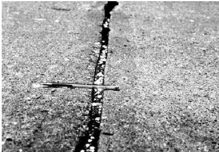
Daño del sello de junta de alta severidad
