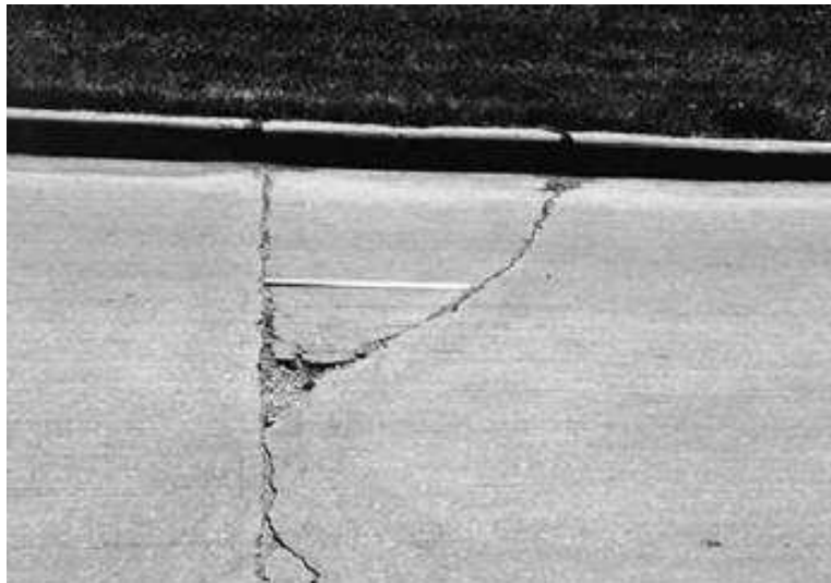
Grieta de esquina de severidad media
