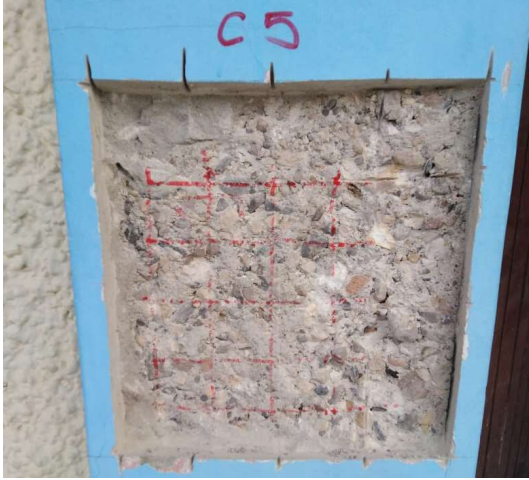
Fotografía N°5 Punto de Ensayo No Realizado por Superficie No Conforme
