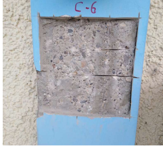
Fotografía N°6 Punto de Ensayo No Realizado por Superficie No Conforme
