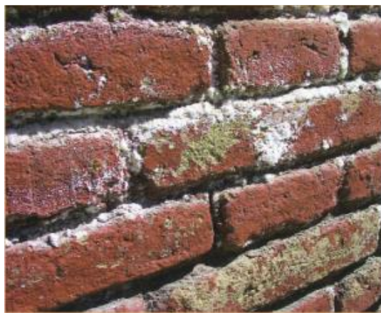
Figura 10: Aparición de eflorescencias en ladrillos
