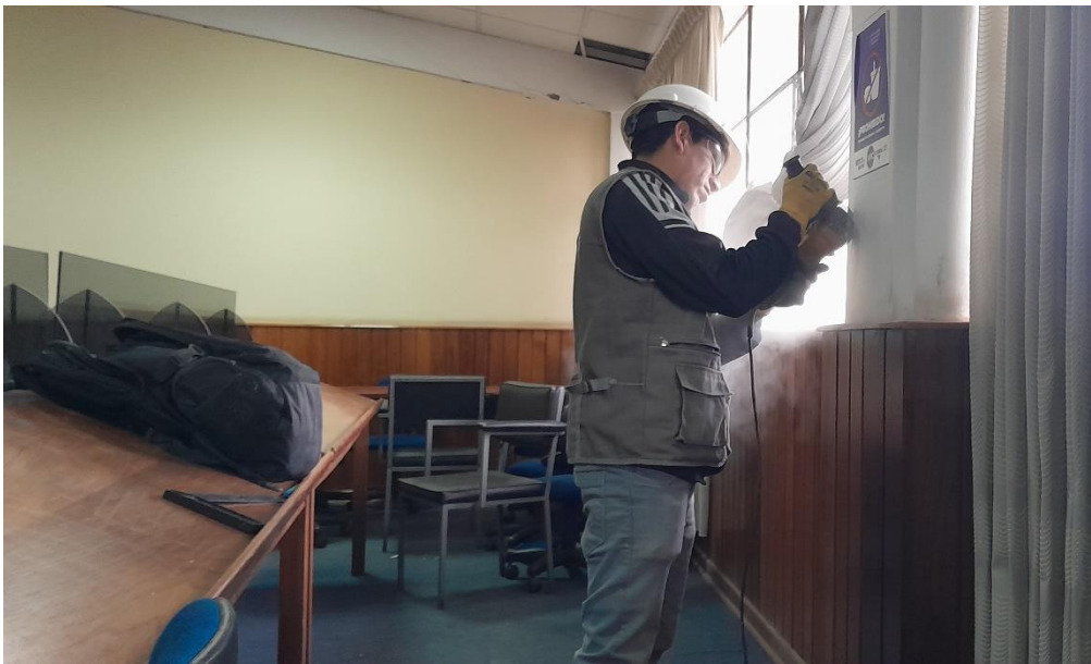
Fotografía N° 8: Retirando el recubrimiento de una columna del tercer nivel para su posterior ensayo.
