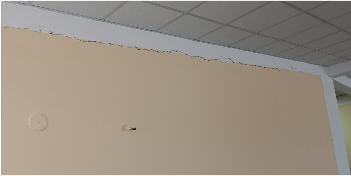
Fotografía N° 3: Grieta en viga del tercer Nivel en el ambiente de computo.
