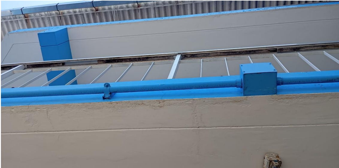
Fotografía N° 5: Presencia de eflorescencia y humedad en losa de la fachada principal del primer y segundo nivel.
