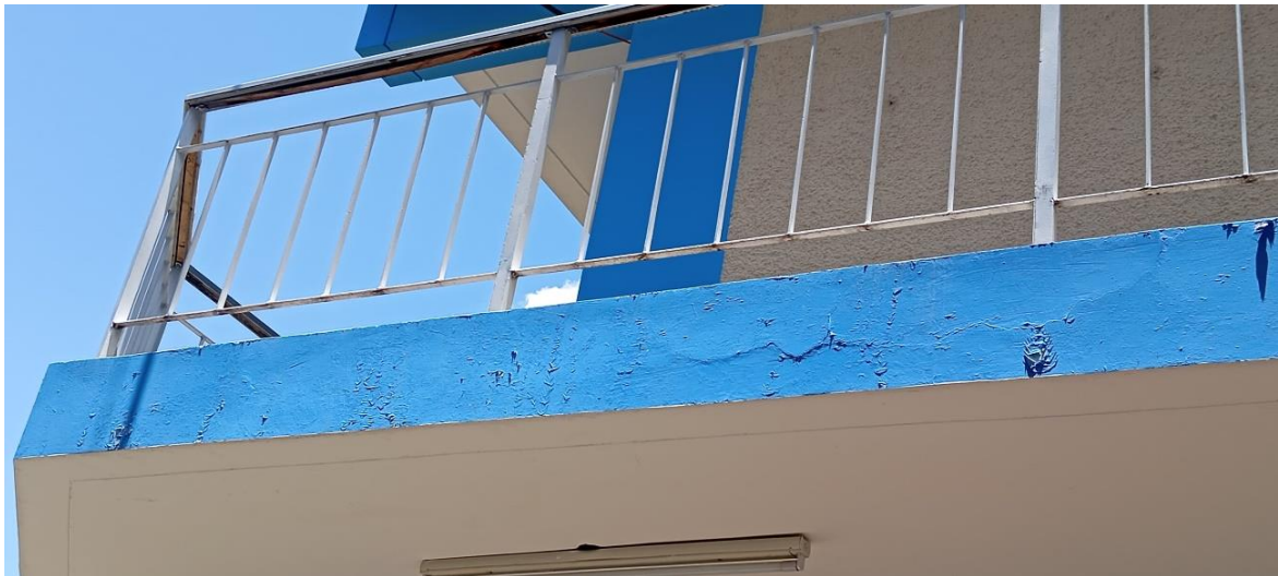
Fotografía N° 4: Fisura horizontal y presencia de desprendimiento de acabados en losa del primer nivel.
