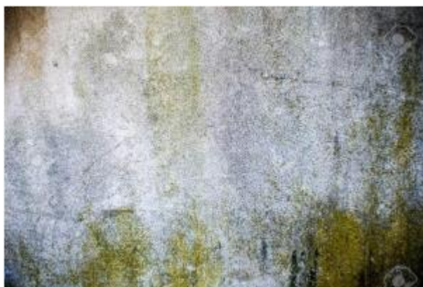
Figura 12: Presencia de hongos en el hormigón
