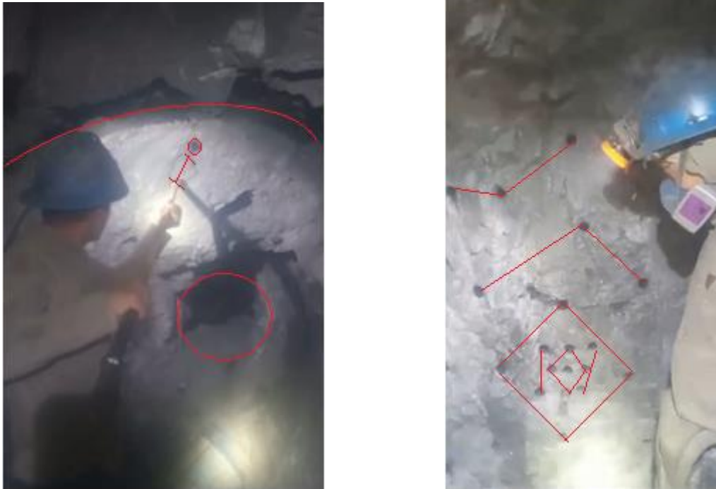
Figura 13 espaciamento entre taladros inadecuados.
