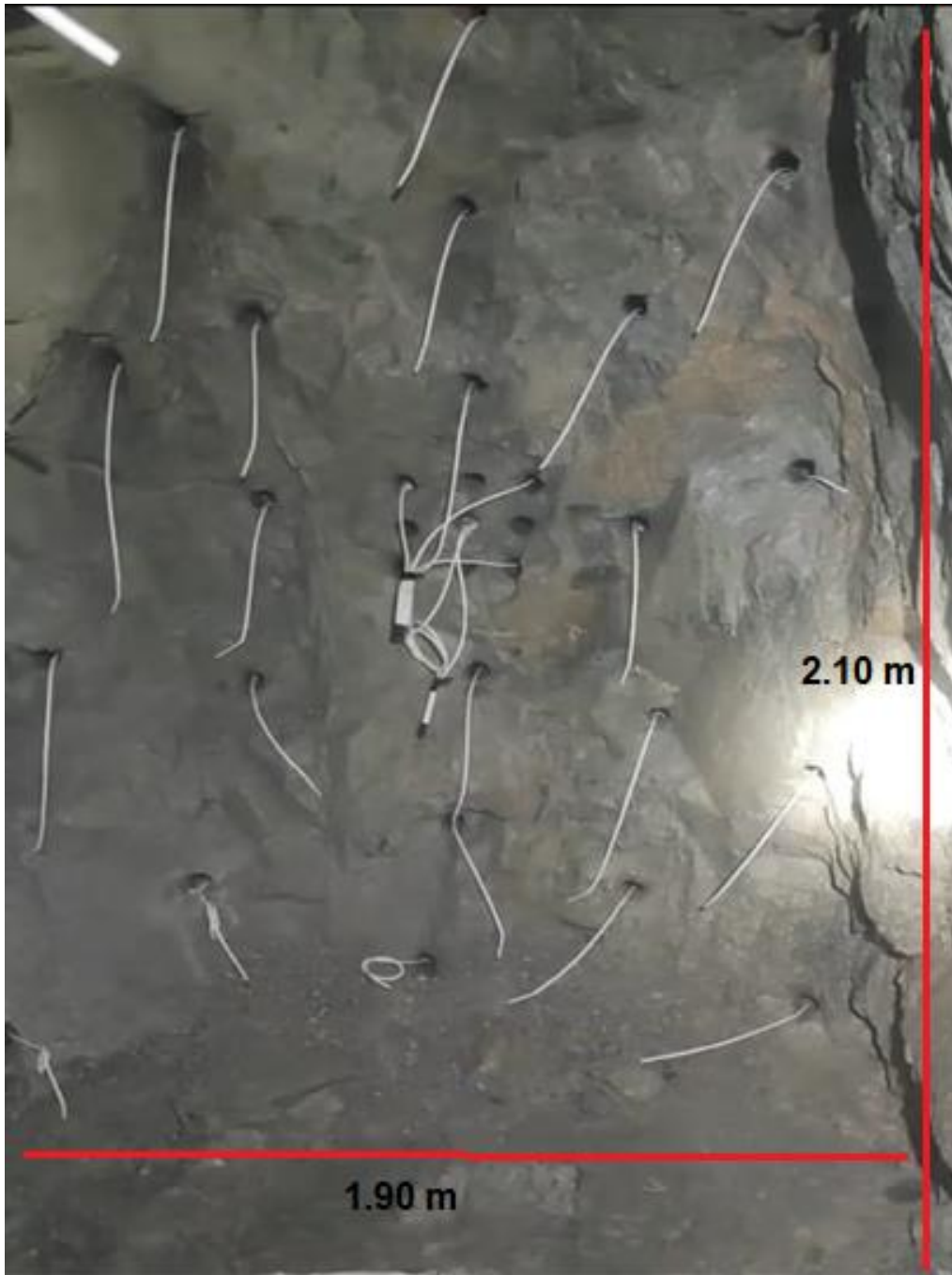
Figura 20 perforación y diseño de la malla en el frente de avance de la galería N°3
