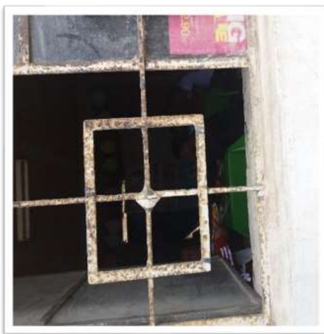
Figura 21: Ventana en pésimas condiciones.
