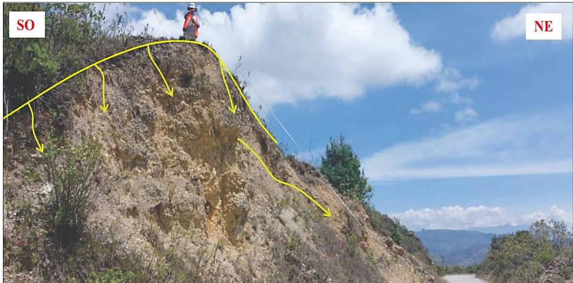
Fotografía 13 Deslizamiento; Movimiento de masa identificado. Caída de rocas y detritos, con pendiente pronunciada. Foto tomada en la margen izquierda de la carretera Lomas del Indio Km 5+780
