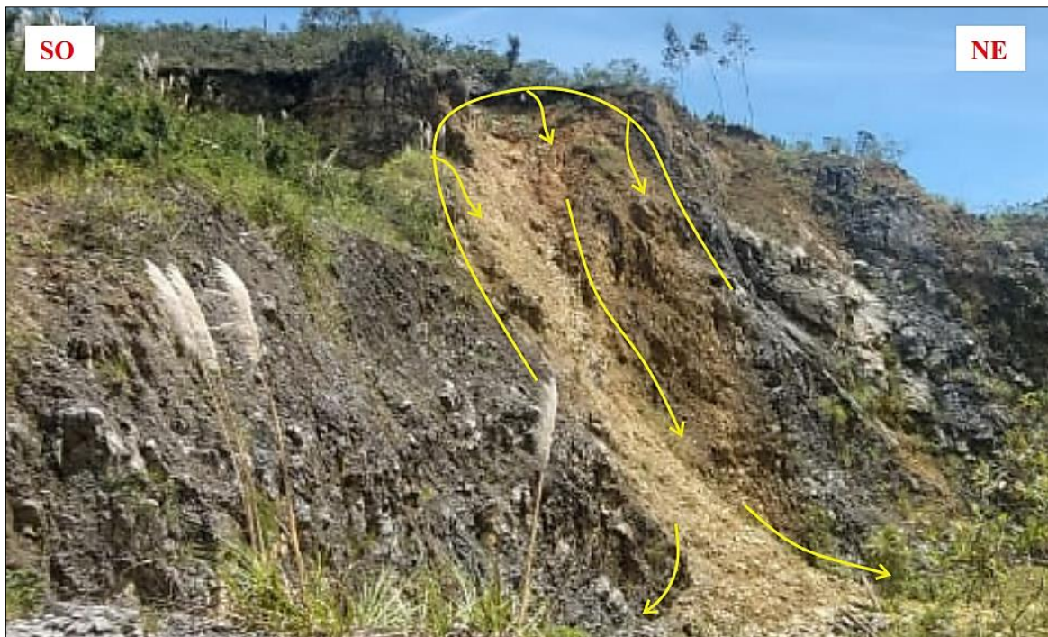
Fotografía 1 Flujo de detritos; con caída en pendiente pronunciada, susceptible a un Movimiento de masa de mayor tamaño, que se observa en la margen izquierda de la carretera de Lomas del Indio cerca al Km8+120
