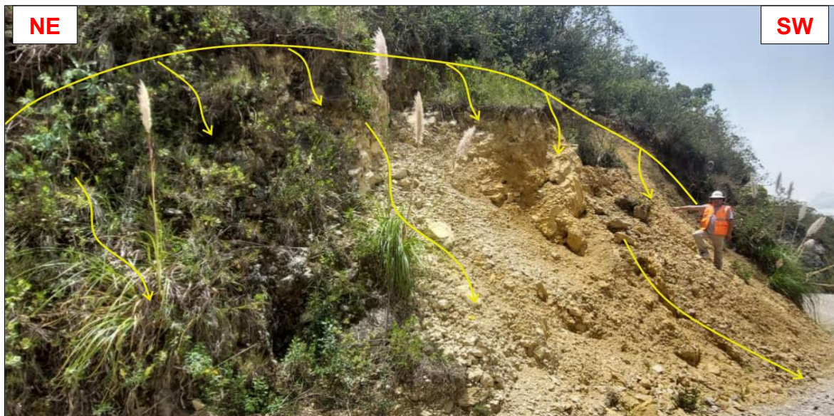
Fotografía 11 Deslizamiento; Movimiento de masa identificado, se evidencia escarpe principal y material desplazado. Foto tomada en la margen izquierda de la carretera Lomas del Indio Km 10+20
