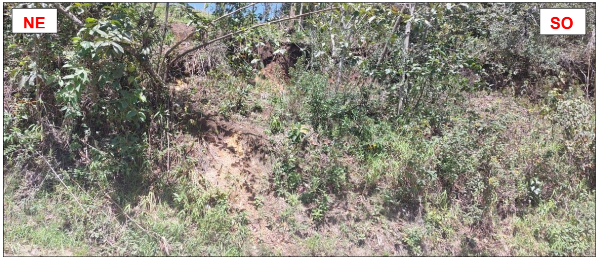
Fotografía 3 Troncos y tallos de plantas inclinados, lo que evidencia la reactivación de Movimiento de Masa. Foto tomada en el Km11+340 del tramo de carretera Lomas del Indio.
