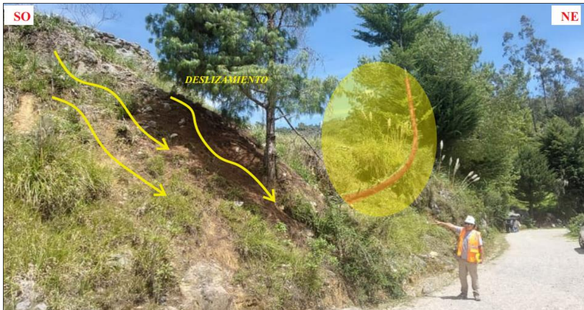
Fotografía 8 Tronco de árbol fuertemente torcido, que evidencia la reactivación de un Movimiento de Masa. Foto tomada en la margen izquierda de la carretera del indio y cerca al Km 7+960.
