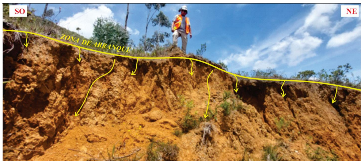
Fotografía 12 Zona de arranque, presenta grietas que se intensifican por acción de meteorización y en época de lluvias, identificada en arcillitas calcáreas de la Formación Yumagual.
