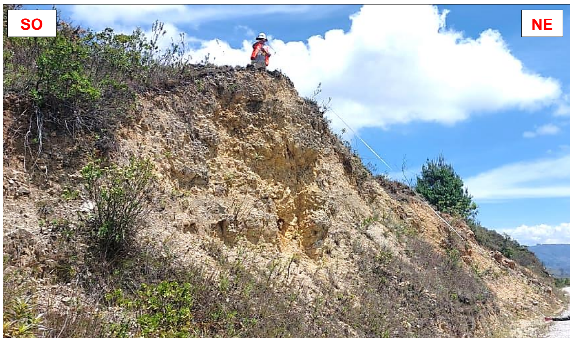
Fotografía 6 Se realiza medición en campo de un Movimiento de masa identificado en el área, presencia de grietas y material de derrumbe.
