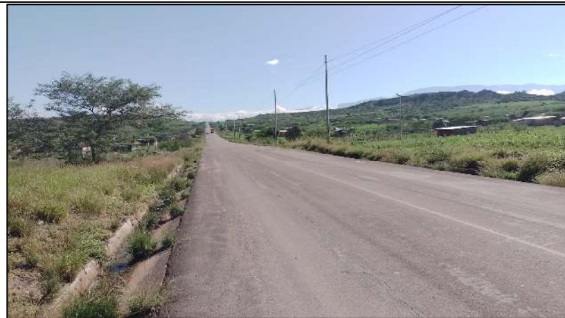
Foto N°14. Ausencia de Marcas en el Pavimento (Lateral y Central) denota mal estado de conservación
