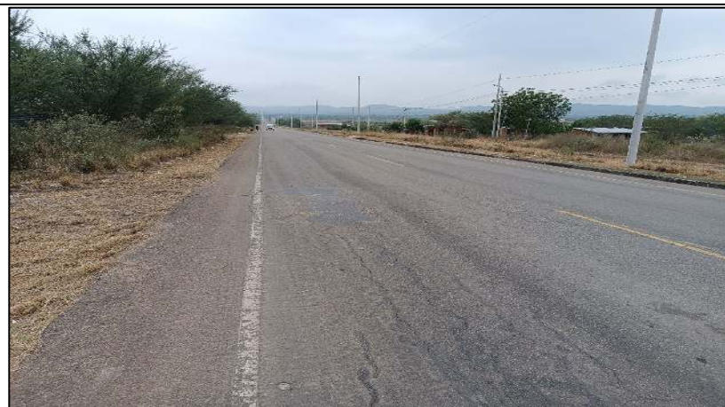
Foto N°12. Marca en el Pavimento (Lateral) en mal estado de conservación (Poco visible)
