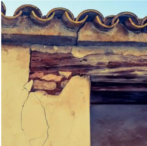
Fisura vertical en muro
