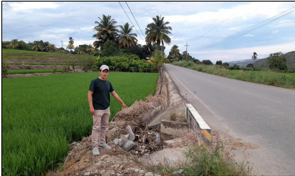
Figura 13. Verificación de las obras de arte y drenaje de vía cruce Shanango-Bellavista, entrada de alcantarilla se puede apreciar que se encuentra semicolmatada en la progresiva 2+207.
