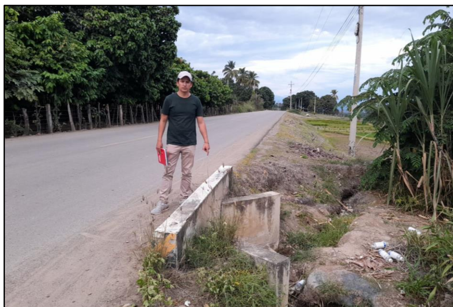
Figura 10 . Verificación de las obras de arte y drenaje de vía cruce Shanango-Bellavista, salida de alcantarilla se puede apreciar que se encuentra semicolmatada en la progresiva 0+259.
