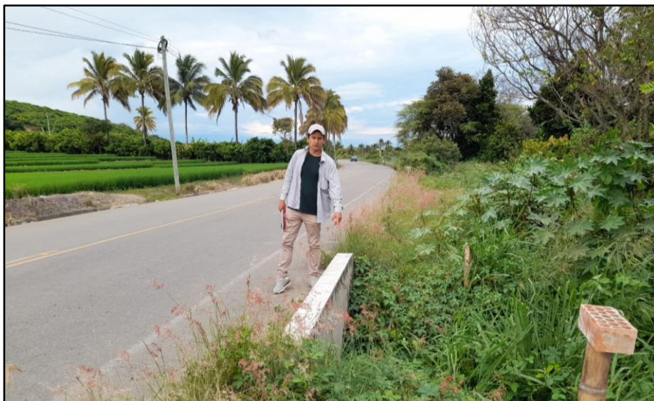
Figura 11. Verificación de las obras de arte y drenaje de vía cruce Shanango-Bellavista, salida de alcantarilla se puede apreciar que se encuentra semicolmatada en la progresiva 5+731.
