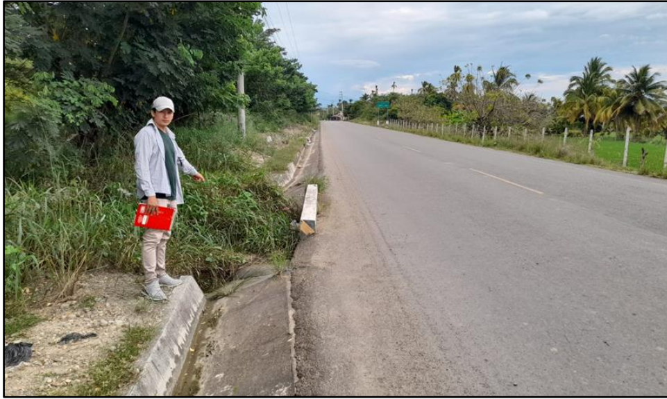
Figura 15. Estado de plataforma de ingreso de la alcantarilla de la vía cruce Shanango-Bellavista, se aprecia vegetación y lodo , en la progresiva 3+660.
