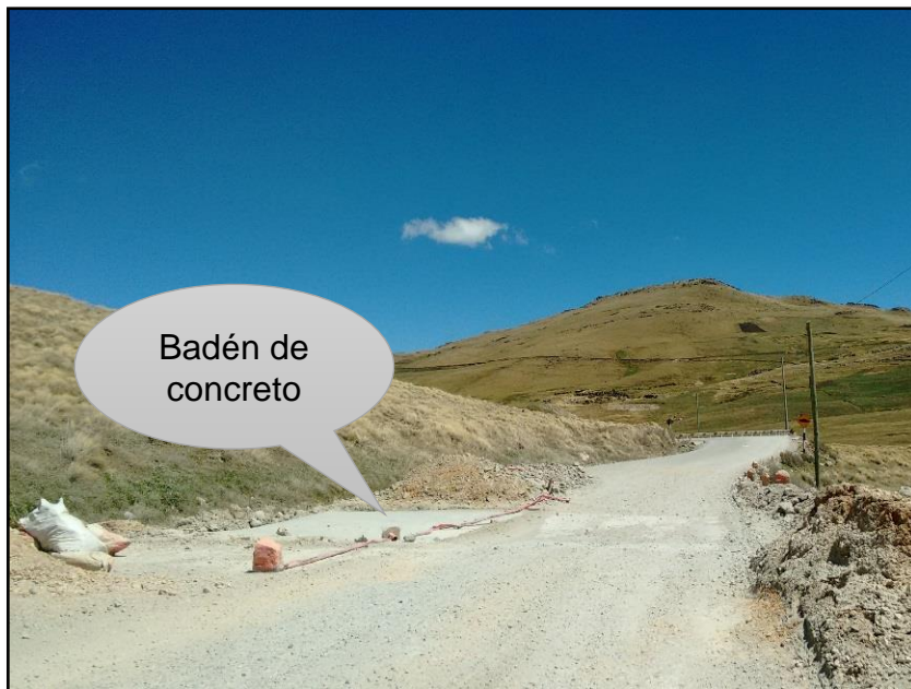
Fotografía N° 4: Obsérvese un badén de concreto en el Km 74+124, tramo sin asfaltar con alteración de la calidad del aire.
