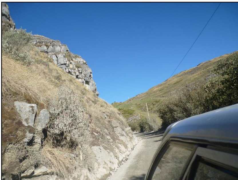
Fotografía N° 8: Km 84+334 obsérvese el talud de material rocoso, erosionable causante de caídas de roca caliza, que afecta a la salud y seguridad de conductores y peatones.
