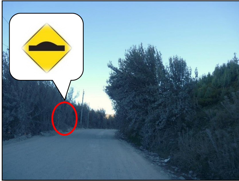
Fotografía N° 3: Tramo de afirmado en el Km 70+345, la calidad del aire es afectada por el incremento de polvo que evita la visibilidad de los transeúntes y conductores.
