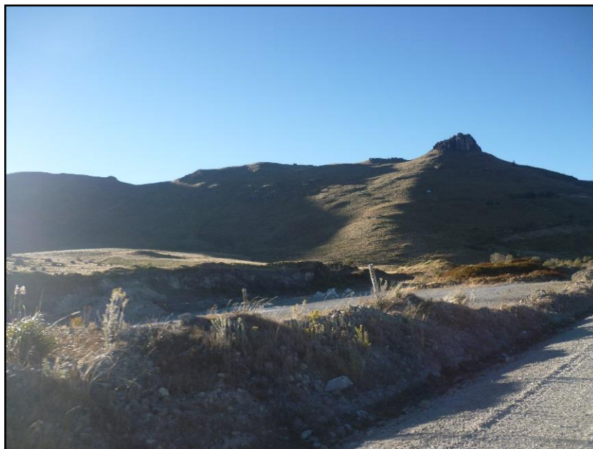
Fotografía N° 2: Depósito de material excedente en el km 69+200, en donde no se realizó las medidas de restauración ambiental, alterando la geomorfología, el paisaje de la zona y la calidad del aire.
